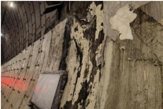
图 4 左洞装饰涂层脱落照
