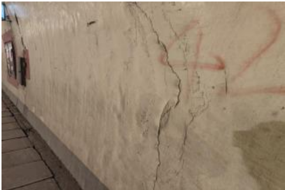
图 2 左洞装饰涂层脱落照
