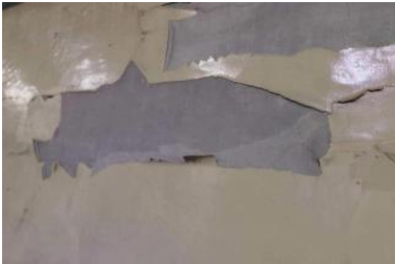
图 1 右洞装饰涂层脱落照
