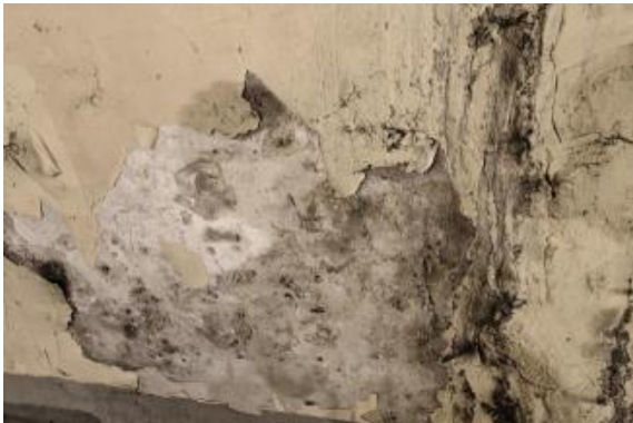
图 3 左洞装饰涂层脱落照
