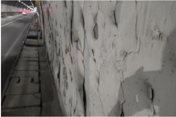
图 4 巴岳山隧道右洞K1+665装饰涂层起层、剥落
