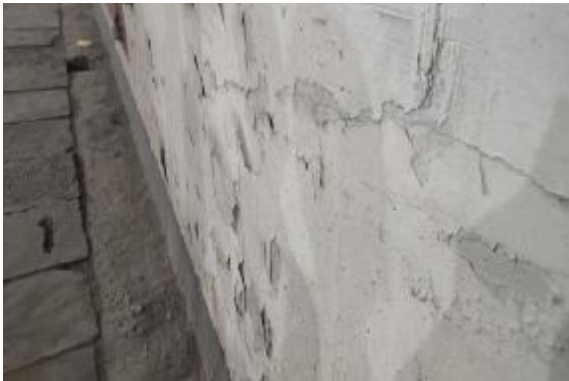
图 1 巴岳山隧道左洞K0+216装饰涂层起层、剥落
