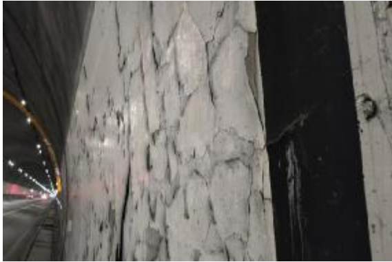
图 3 巴岳山隧道右洞K1+641装饰涂层起层、剥落
