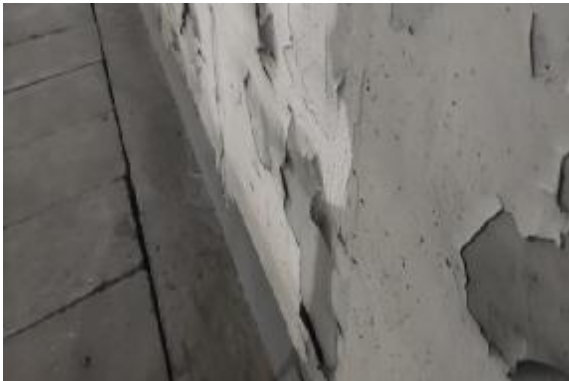
图 2 巴岳山隧道左洞K0+571装饰涂层起层、剥落
