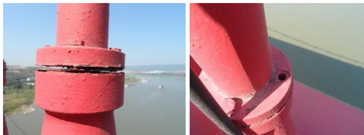
图 1.3-2 防护套与锚头连接处螺栓断裂或缺失
