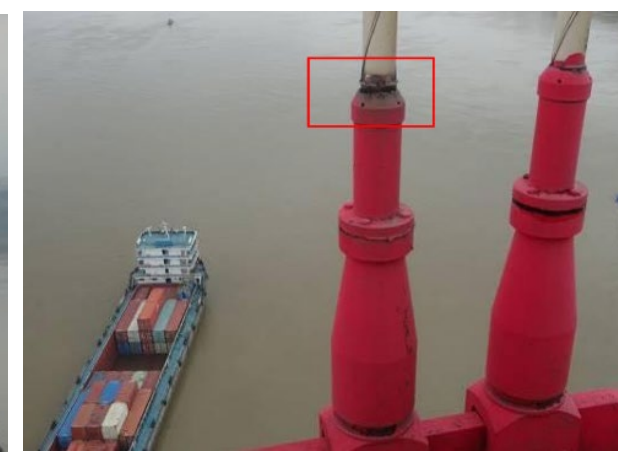
图 1.3-6 防护套与吊杆连接处锈蚀
