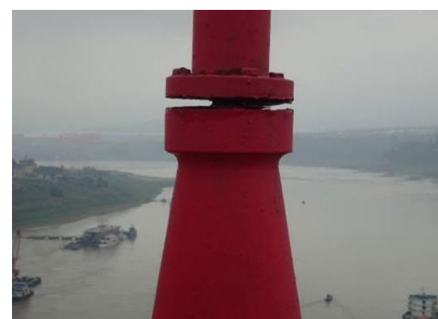
图 1.3-5 防护套与下锚头连接处螺栓断裂
