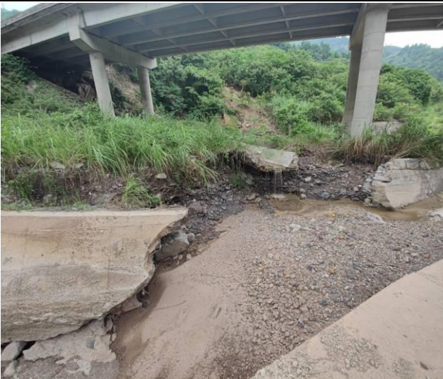
图 4.4.4 排洪渠被冲毁
