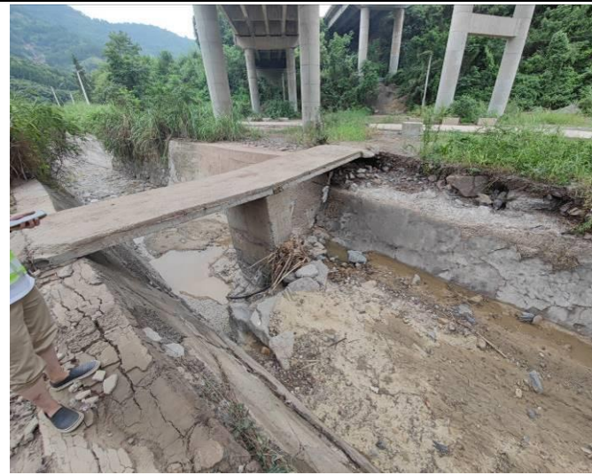
图 4.4.3 沟渠上小桥墩柱阻拦水流排泄
