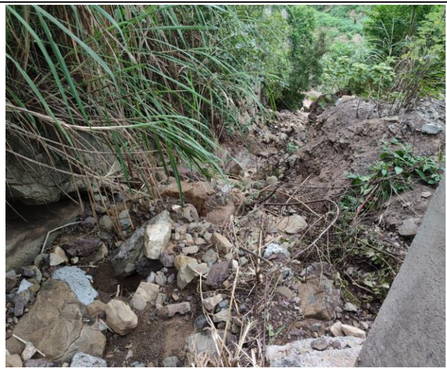
图 3.2 桥墩旁堆积土石
