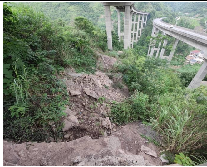
图 4.3.3 水流冲刷导致桥下坡体垮塌
