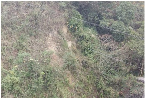
图 3.1.4 边坡溜坍区域
