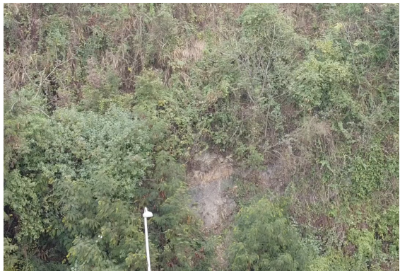
图 3.1.5 边坡掉块区域
