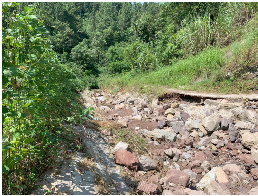
图 3.8.5 (4) 损坏的排洪渠和堆积的碎石(第二段)
