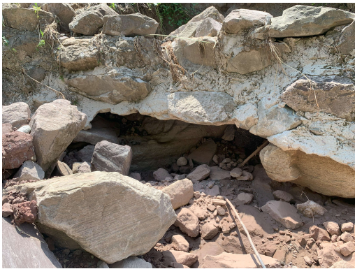
图 3.8.3 (2) 中上游损坏的排洪渠边墙(第一段)
