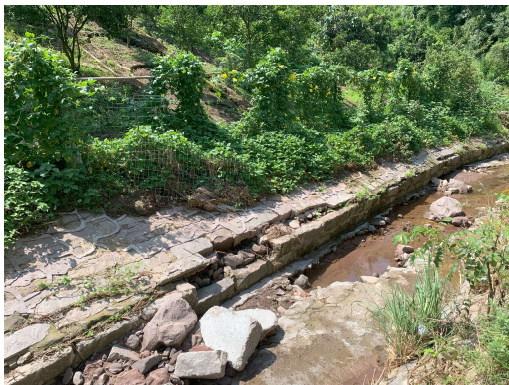
图 3.8.6 (5) 中下游损坏的排洪渠(第二段)
