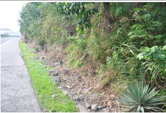
图 3.5.3 边坡底部掉落的石块
