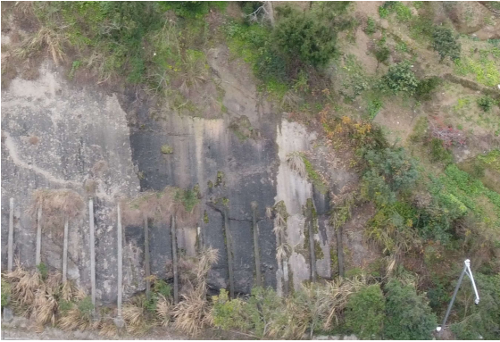
图 3.2.5 边坡东侧岩面水渍
