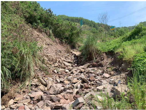
图 3.8.2 (1) 上游损坏的排洪渠和堆积的碎石(第一段)
