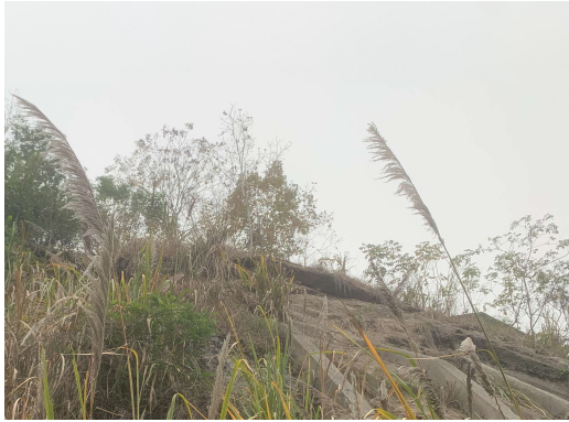
图 3.2.4 边坡西侧顶部掉块
