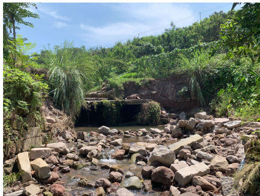
图 3.8.7 (6) 排洪渠末端边坡垮塌(第三段)
