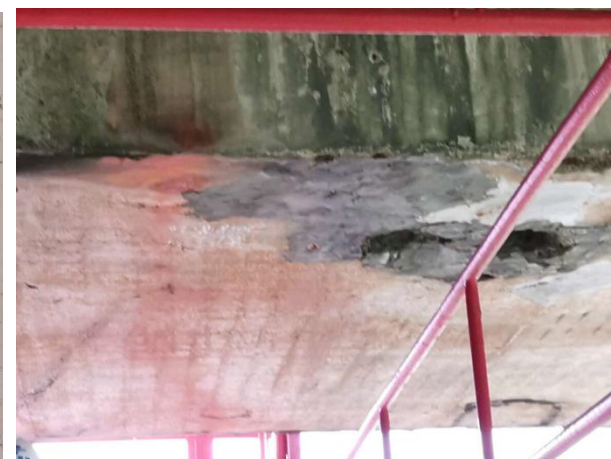
主梁混凝土剥落、露筋
