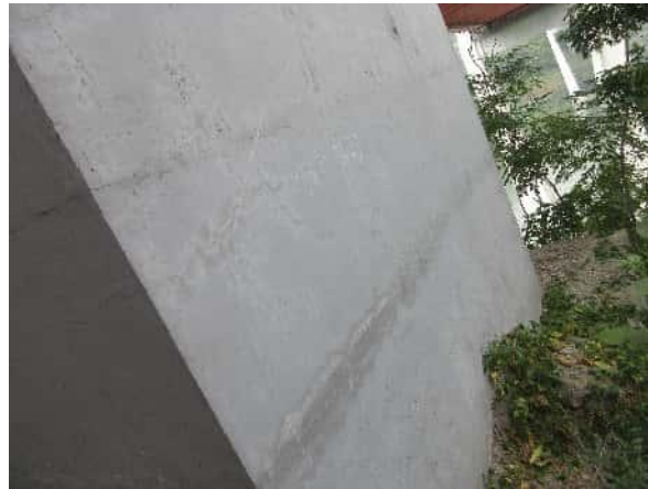
桥墩网状裂缝
