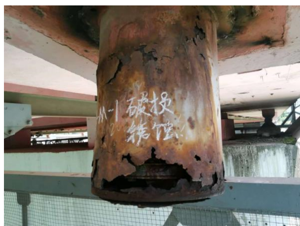
下锚头破损锈蚀
