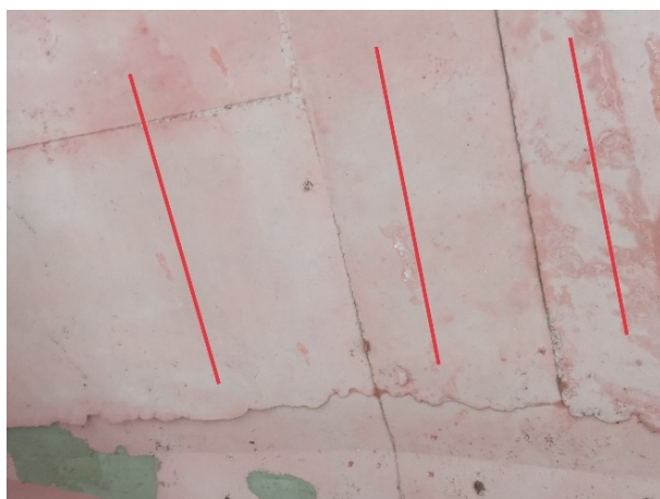
主梁节段纵向裂缝
