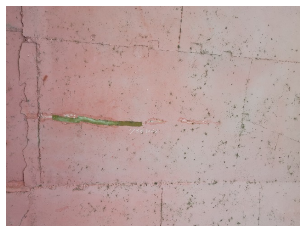
主梁纵向裂缝
