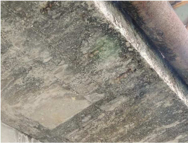
照片 4.2.1-24 6-3#T 梁露筋
