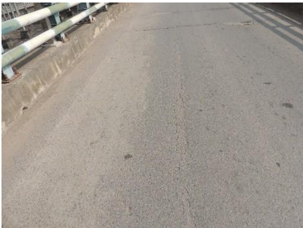
照片 4.2.6-12 桥面铺装松散、露骨
