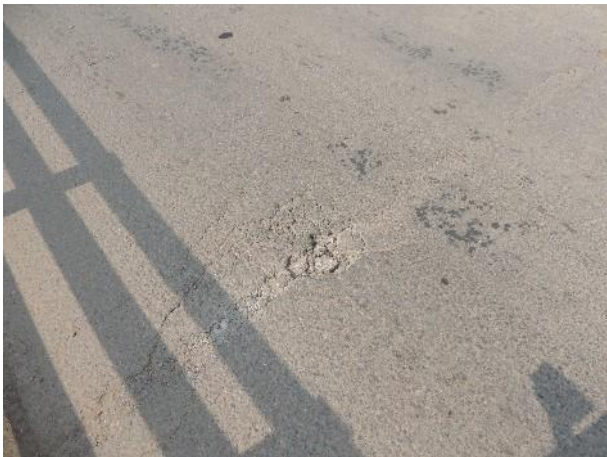
照片 4.2.6-9 桥面铺装破损、沉陷、开裂
