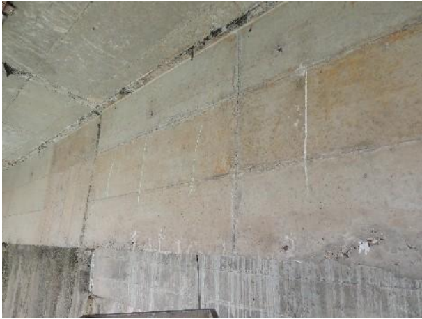
照片 4.2.1-47 13-1#T 梁竖向裂缝
