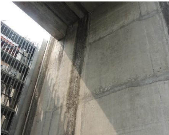
照片 4.1.3-2 1#桥墩~5#桥墩水渍污染
