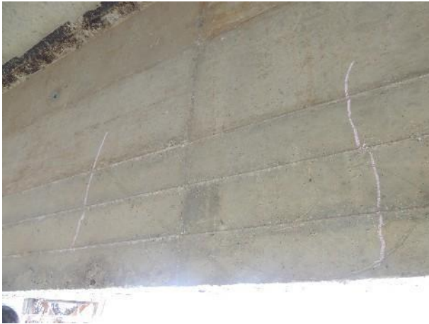
照片 4.2.1-6 1-3#T 梁竖向裂缝
