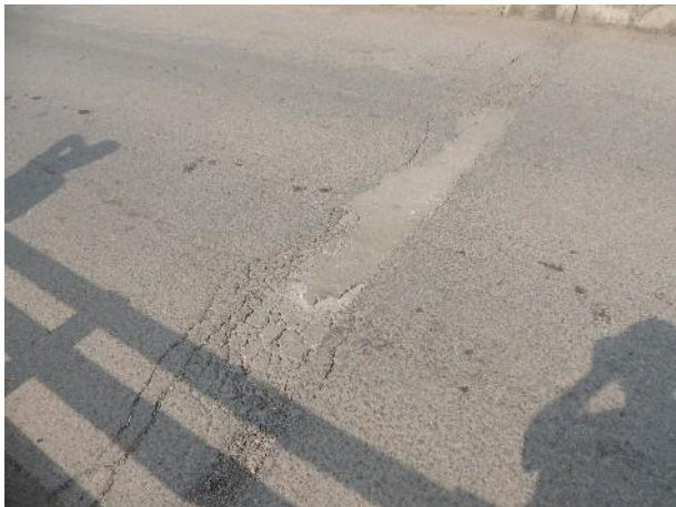
照片 4.2.6-3 桥面铺装纵向裂缝
