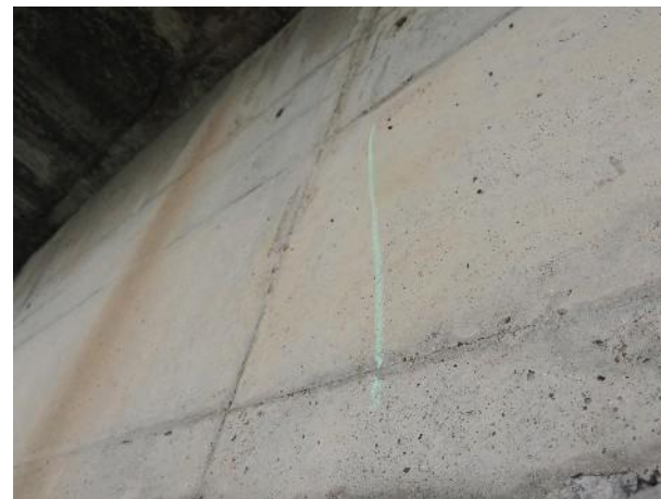
照片 4.2.1-36 9-3#T 梁竖向裂缝
