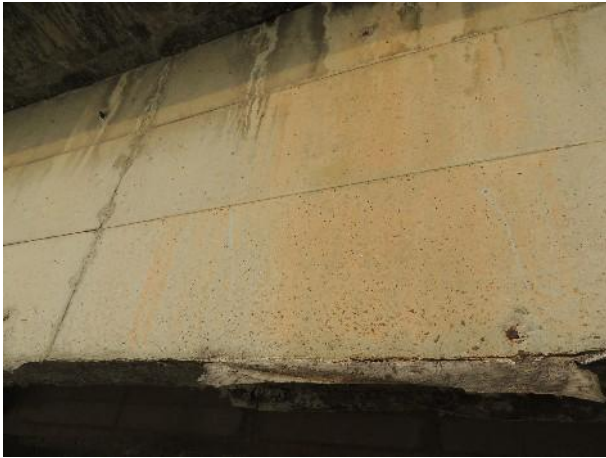
照片 4.2.1-23 6-3#T 梁竖向裂缝
