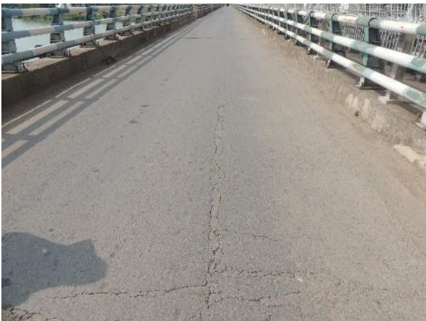
照片 4.2.6-2 桥面铺装纵向裂缝
