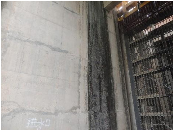
照片 4.1.4-4 6#桥台水渍污染痕迹
