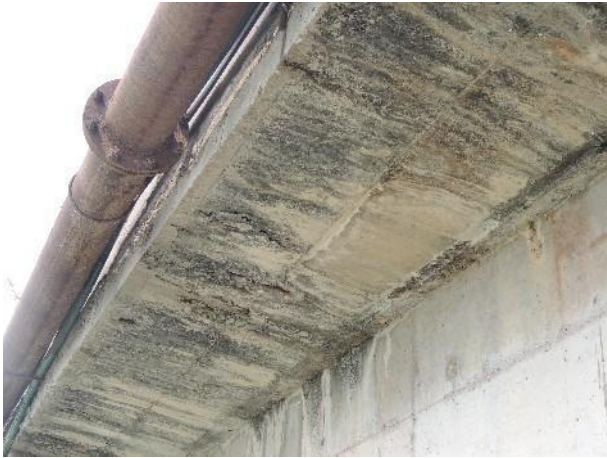
照片 4.2.1-5 1-3#T 梁剥落、露筋
