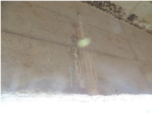
照片 4.2.1-20 5-3#T 梁竖向裂缝
