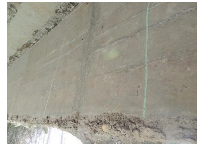
照片 4.2.1-42 11-2#T 梁竖向裂缝
