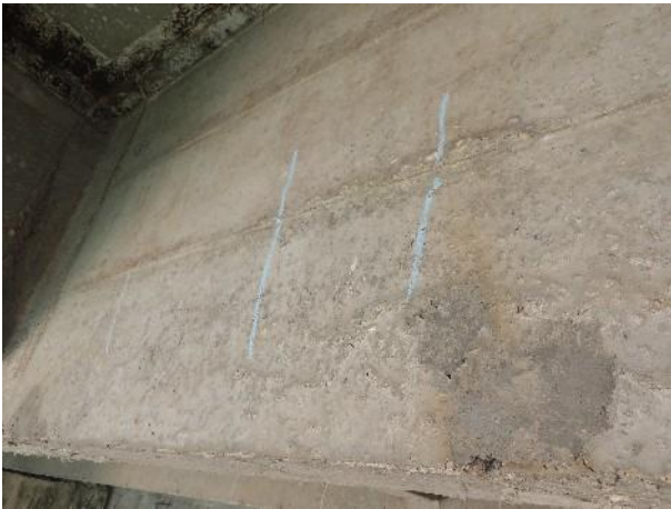
照片 4.2.1-10 3-2#T 梁竖向裂缝
