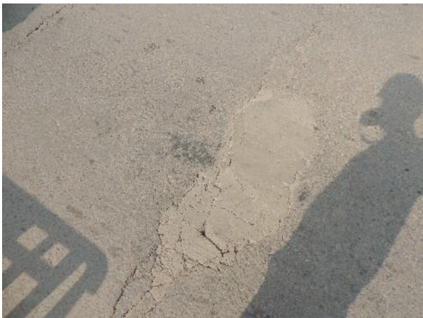
照片 4.2.6-11 桥面铺装破损、沉陷、开裂 伸缩缝装置检查结果见表4.2-7。
