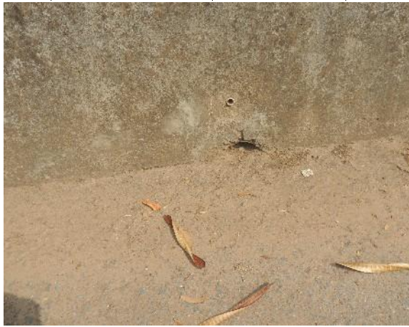
照片 4.1.8-1 排水系统泄水管、引水槽缺陷
