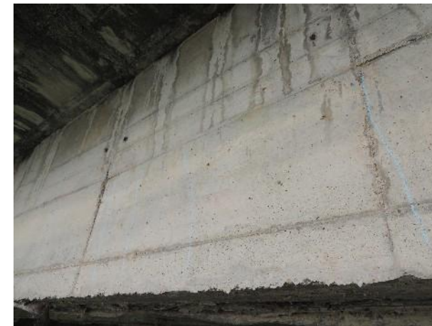
照片 4.2.1-39 10-3#T 梁竖向裂缝
