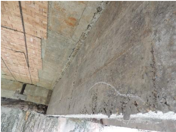
照片 4.2.1-63 18-2#T 梁蜂窝麻面 上部一般构件检查结果见表4.2-2。
