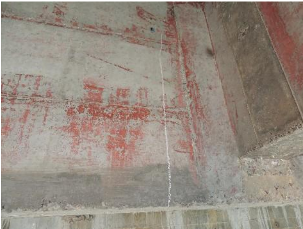
照片 4.2.1-14 4-1#T 梁竖向裂缝
