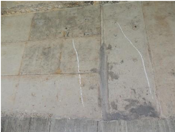
照片 4.2.1-45 12-2#T 梁竖向裂缝
