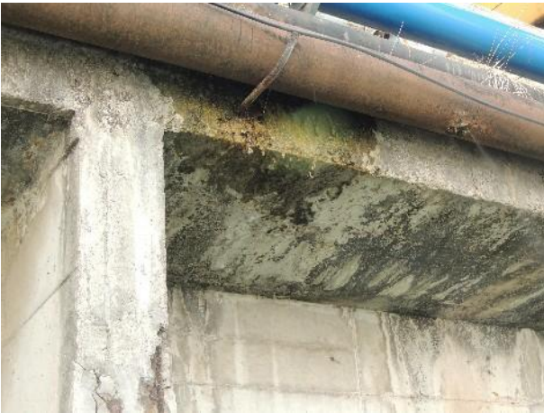
照片 4.2.1-28 7-3#T 梁水渍污染
