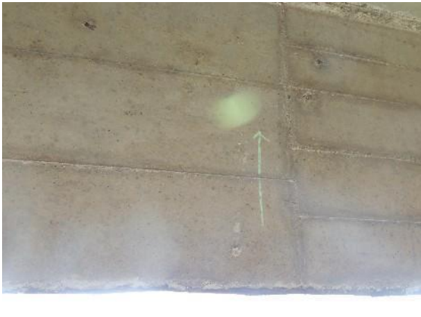
照片 4.2.1-31 8-3#T 梁竖向裂缝
