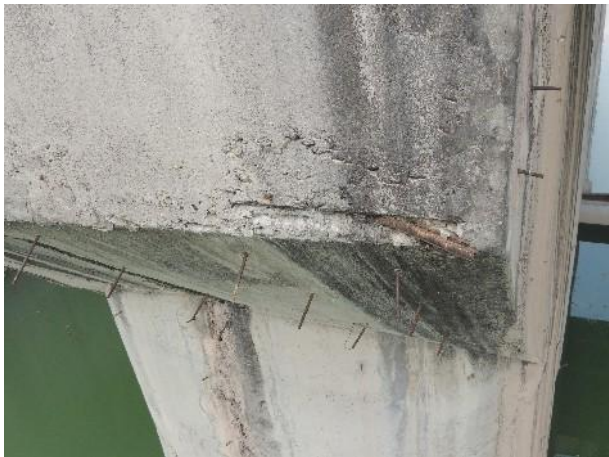
照片 4.2.3-9 12#桥墩盖梁右侧面, 存在 1 处施工质量差, 钢筋外露
