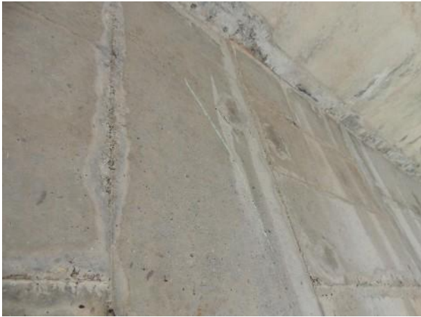
照片 4.2.1-53 15-1#T 梁竖向裂缝
