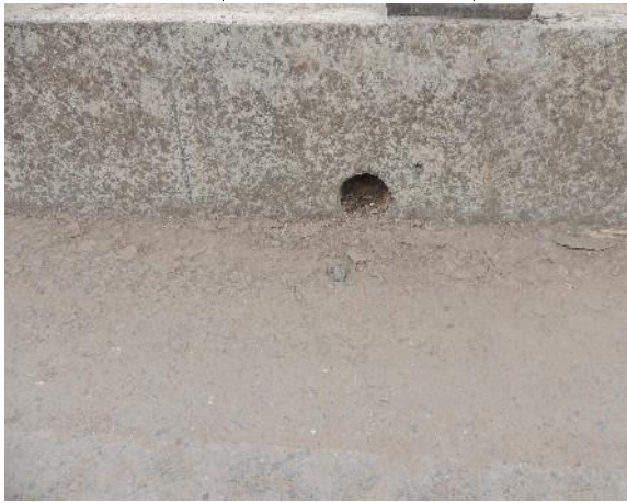
照片 4.1.8-2 排水系统泄水管、引水槽缺陷
