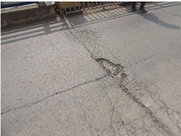
照片 4.2.6-6 桥面铺装横向开裂、破损、沉陷
