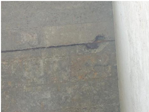
照片 4.1.1-1 1-1#板梁~1-3#板梁剥落、掉角
