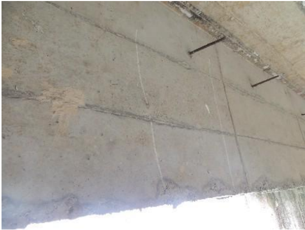
照片 4.2.1-54 15-2#T 梁竖向裂缝
