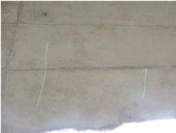
照片 4.2.1-49 13-3#T 梁竖向裂缝
