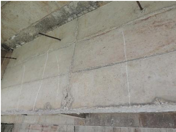
照片 4.2.1-57 16-2#T 梁竖向裂缝
