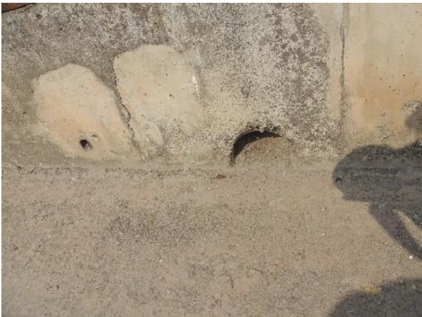
照片 4.2.8-2 排水系统泄水管、引水槽缺陷
