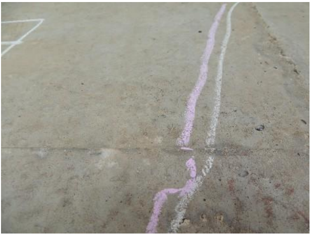
照片 4.2.1-2 1-1#T 梁竖向裂缝
