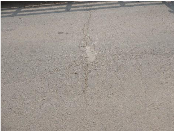
照片 4.2.6-4 桥面铺装横向裂缝
