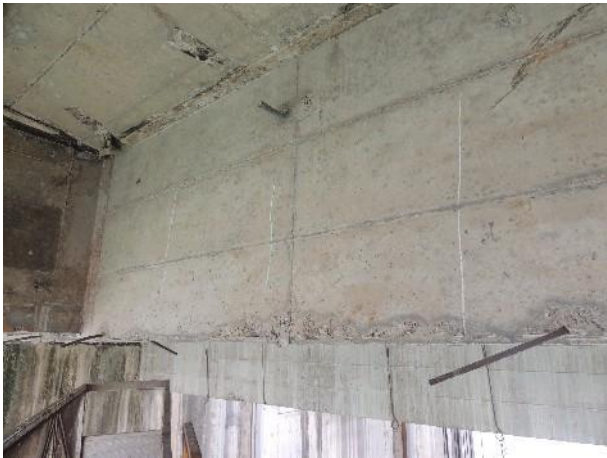
照片 4.2.1-51 14-2#T 梁竖向裂缝
