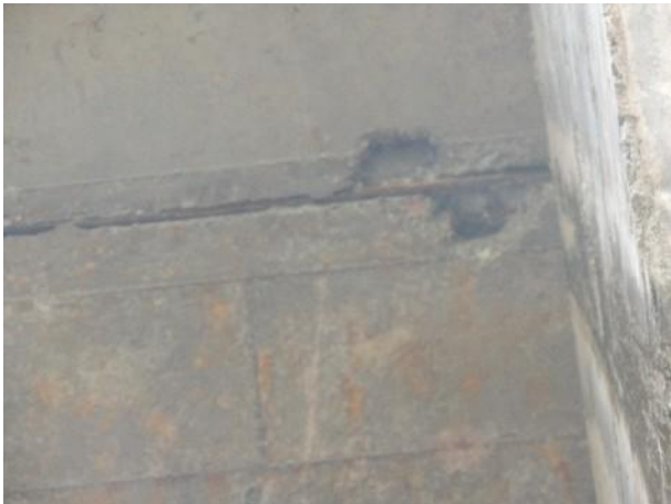
照片 4.1.1-3 2-1#板梁~2-3#板梁剥落、掉角
