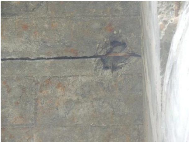
照片 4.1.1-4 2-1#板梁~2-3#板梁剥落、掉角
