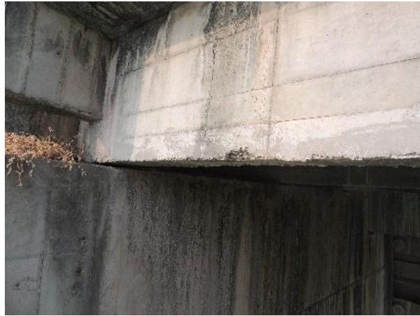
照片 4.2.1-17 4-3#T 梁剥落
