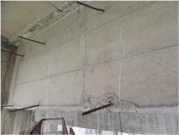
照片 4.2.1-48 13-2#T 梁竖向裂缝
