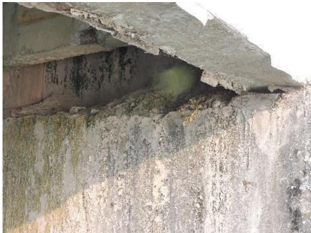
照片 4.2.3-12 1#桥墩~17 桥墩盖梁上方均存在大量施工垃圾堆积
