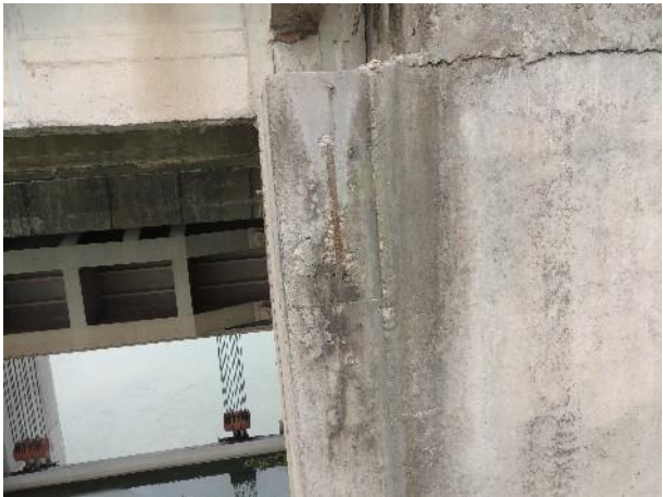
照片 4.2.3-5 6#桥墩破损、露筋
