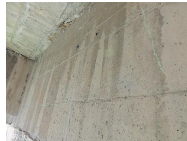
照片 4.2.1-41 11-1#T 梁竖向裂缝
