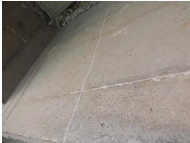
照片 4.2.1-19 5-2#T 梁竖向裂缝
