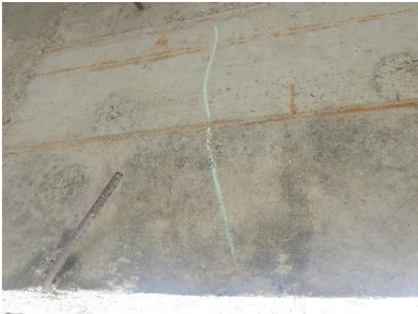
照片 4.2.1-64 18-3#T 梁竖向裂缝
