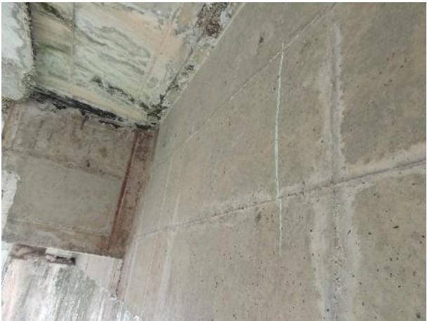
照片 4.2.1-50 14-1#T 梁竖向裂缝
