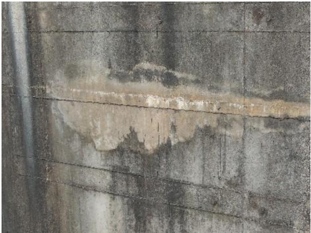
照片 4.2.3-1 1#桥墩纵向裂缝
