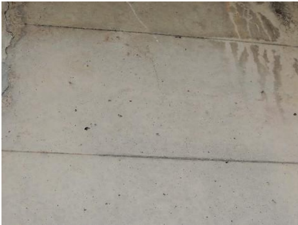
照片 4.2.1-27 7-3#T 梁竖向裂缝
