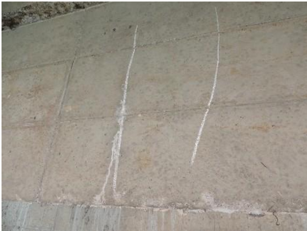
照片 4.2.1-25 7-1#T 梁竖向裂缝
