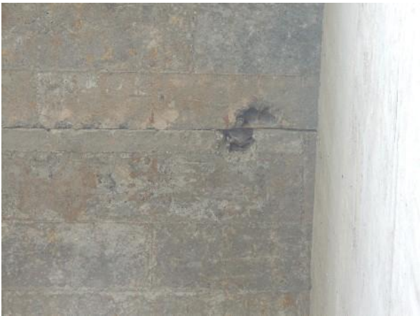
照片 4.1.1-2 1-1#板梁~1-3#板梁剥落、掉角
