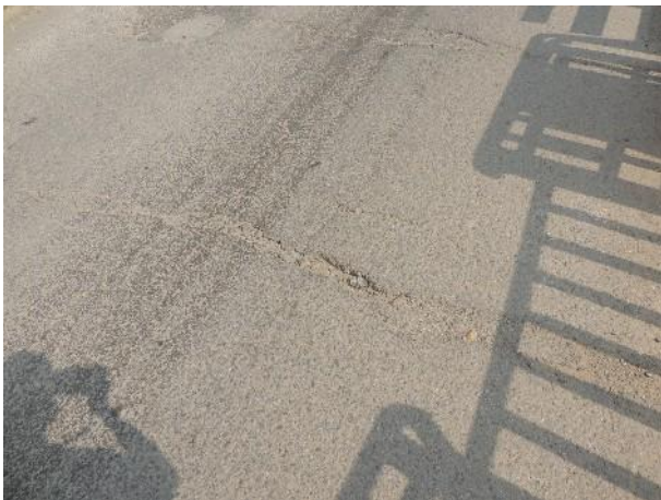
照片 4.2.6-8 桥面铺装横向开裂、破损、沉陷
