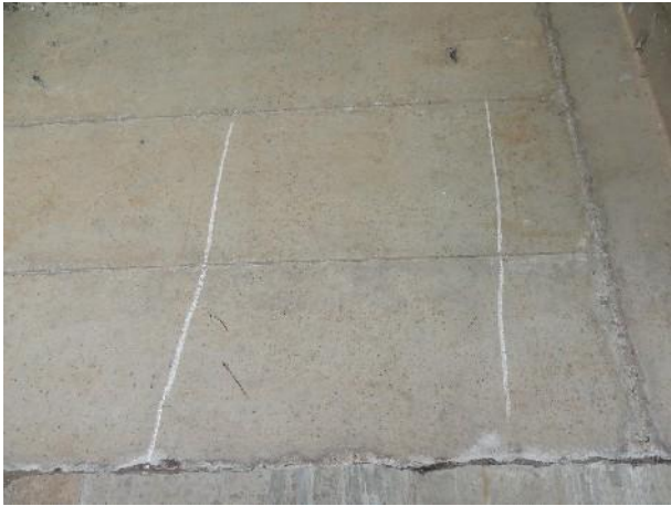
照片 4.2.1-29 8-1#T 梁竖向裂缝
