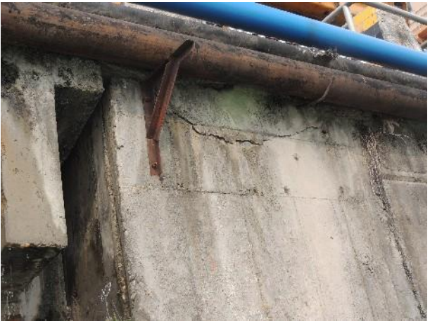
照片 4.2.3-6 8#桥墩剥落
