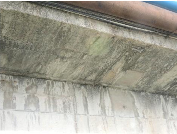
照片 4.2.1-32 8-3#T 梁露筋
