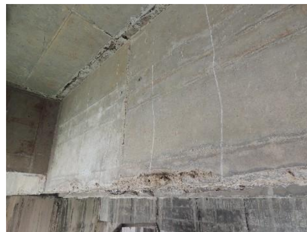
照片 4.2.1-38 10-2#T 梁竖向裂缝
