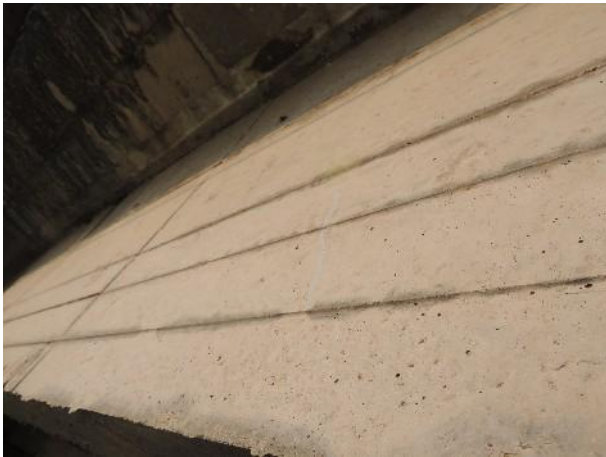
照片 4.2.1-13 3-3#T 梁斜向裂缝
