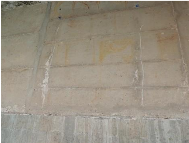
照片 4.2.1-18 5-1#T 梁竖向裂缝
