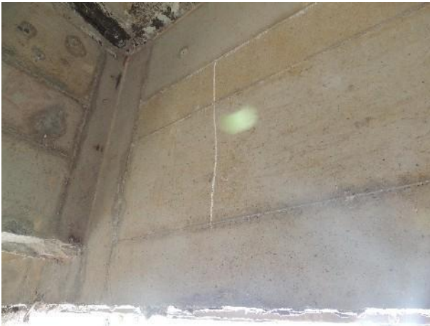
照片 4.2.1-22 6-2#T 梁竖向裂缝
