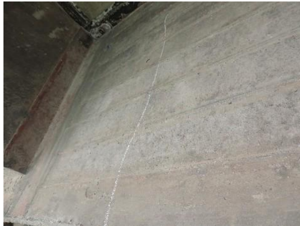
照片 4.2.1-15 4-2#T 梁竖向裂缝
