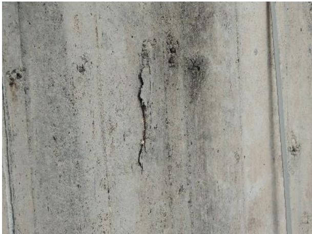
照片 4.2.4-3 18#桥台剥落
