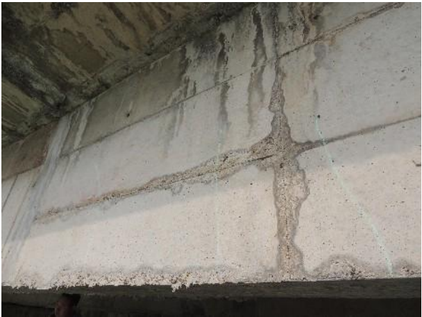
照片 4.2.1-46 12-3#T 梁竖向裂缝
