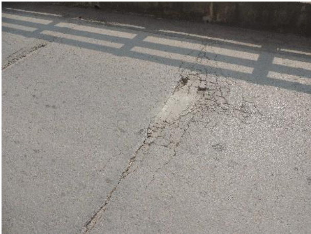
照片 4.2.7-1 全桥伸缩缝覆盖失效 排水系统检查结果见表4.2-8。
