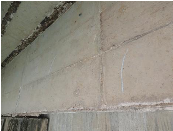
照片 4.2.1-21 6-1#T 梁竖向裂缝
