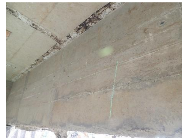
照片 4.2.1-43 11-3#T 梁竖向裂缝
