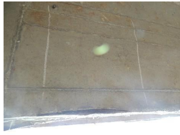
照片 4.2.1-34 9-2#T 梁竖向裂缝
