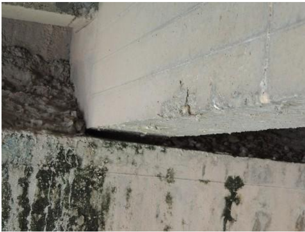
照片 4.2.1-1 1-1#T 梁剥落
