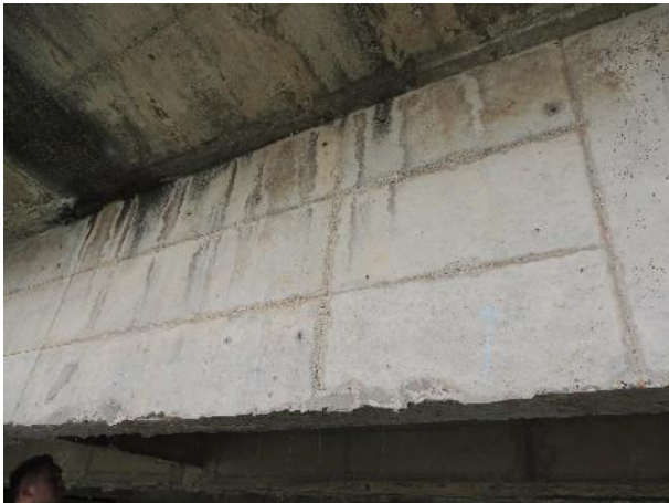
照片 4.2.1-61 17-3#T 梁竖向裂缝
