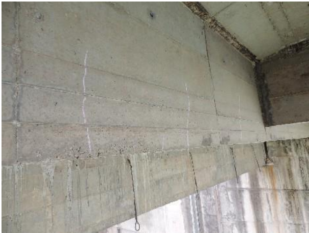
照片 4.2.1-3 1-1#T 梁竖向裂缝
