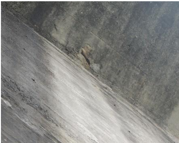
照片 4.1.3-3 4#桥墩剥落、露筋
