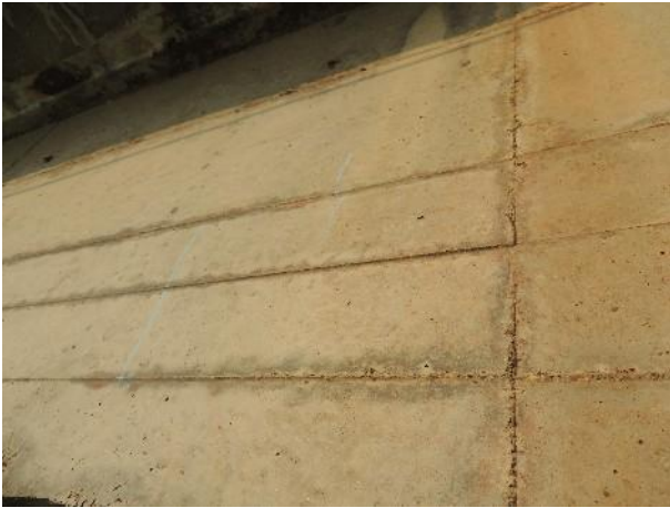
照片 4.2.1-12 3-3#T 梁竖向裂缝
