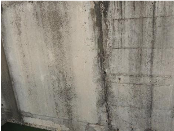
照片 4.2.3-3 5#桥墩施工缝开裂
