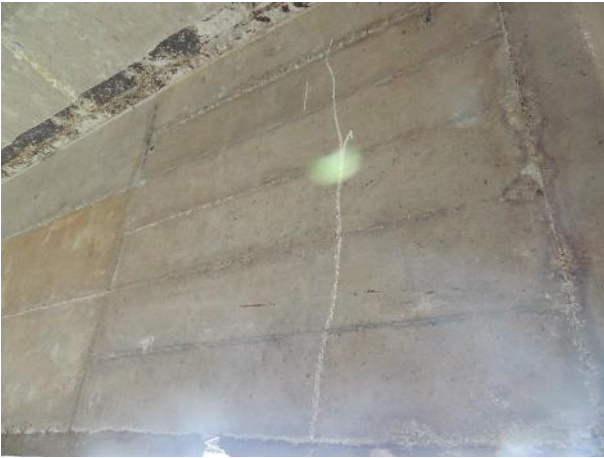
照片 4.2.1-30 8-2#T 梁竖向裂缝
