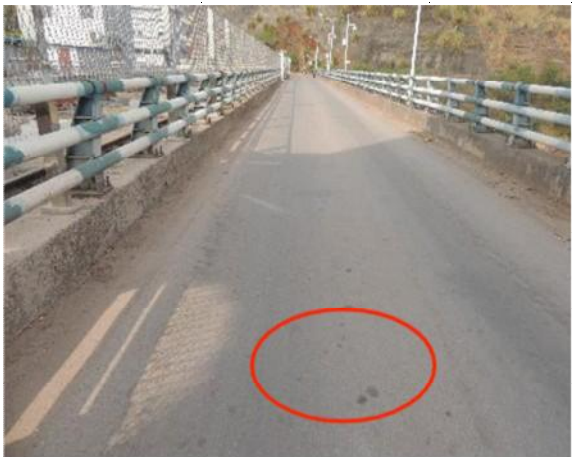
照片 4.1.6-2 桥面铺装破损
