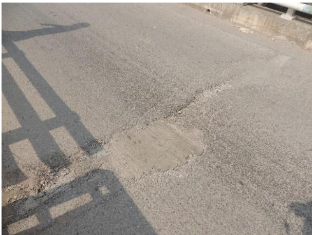
照片 4.2.6-7 桥面铺装破损、沉陷、开裂
