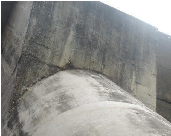
照片 4.1.3-4 5#桥墩露筋
