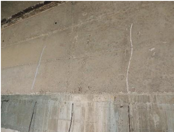
照片 4.2.1-9 3-1#T 梁竖向裂缝
