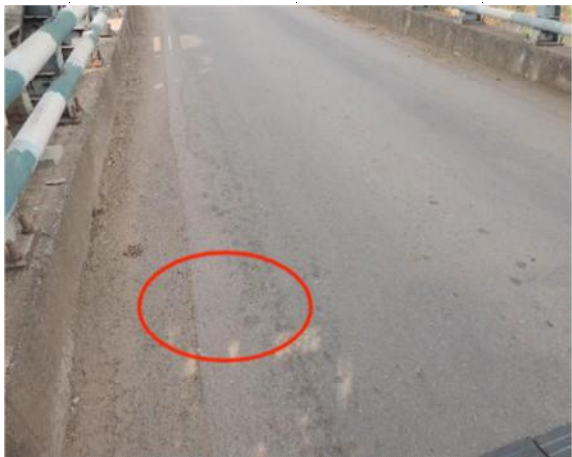
照片 4.1.6-1 桥面铺装破损
