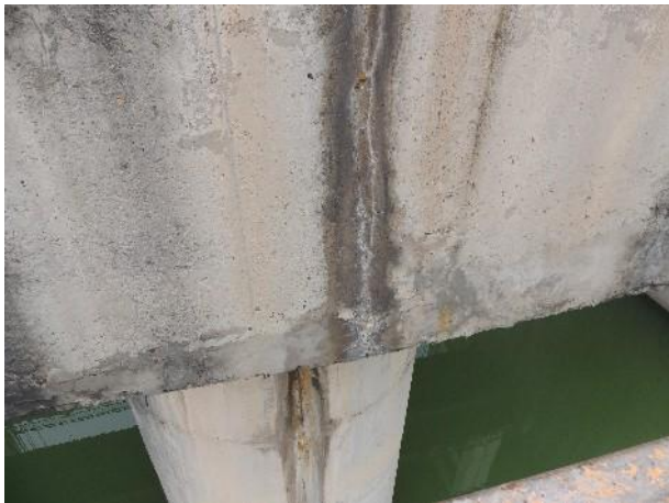
照片 4.2.3-11 14#桥墩盖梁右侧施工缝泛碱
