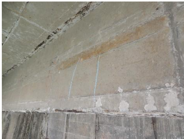
照片 4.2.1-33 9-1#T 梁竖向裂缝
