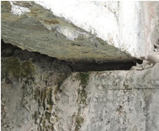
照片 4.2.2-2 全桥支座被混凝土包裹，占 90%
