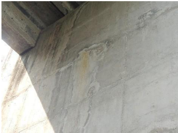
照片 4.1.4-3 0#桥台泛碱痕迹
