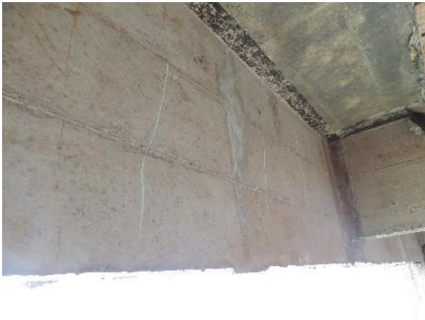
照片 4.2.1-55 15-3#T 梁竖向裂缝
