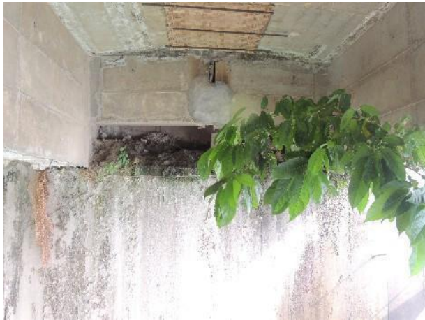
照片 4.2.3-7 8#桥墩盖梁顶部存在植物生长
