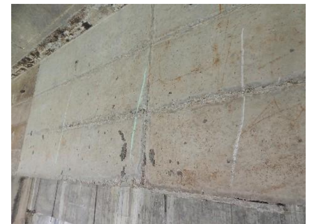
照片 4.2.1-44 12-1#T 梁竖向裂缝
