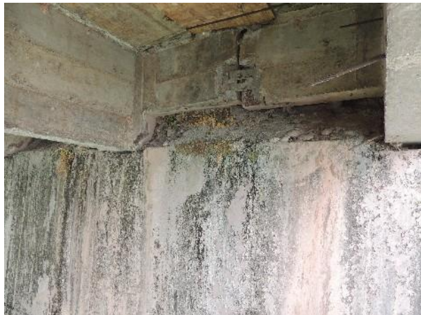
照片 4.2.4-5 18#桥台台帽垃圾堆积
