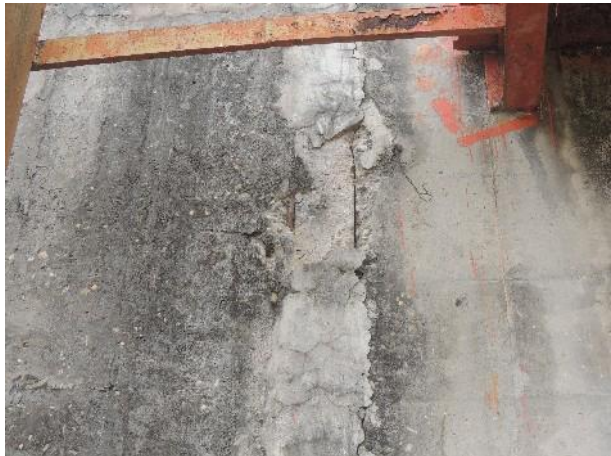
照片 4.1.4-1 0#桥台剥落、露筋
