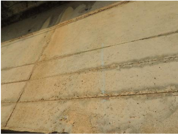
照片 4.2.1-11 3-3#T 梁斜向裂缝
