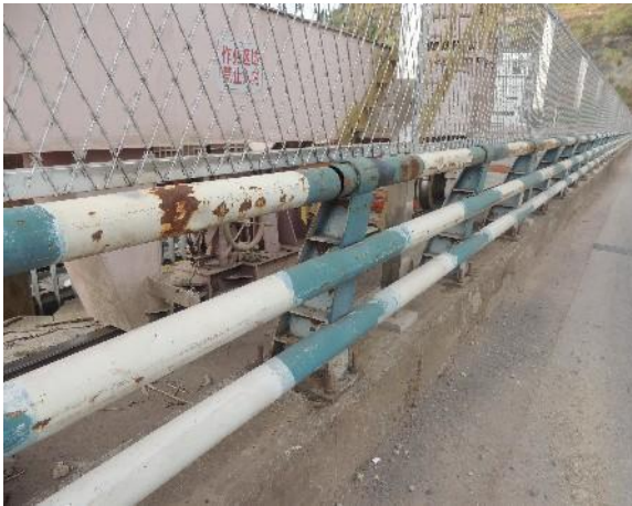
照片 4.1.7-2 右侧护栏破损
