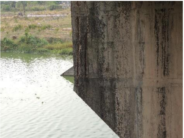
照片 4.2.3-2 2#桥墩破损、露筋
