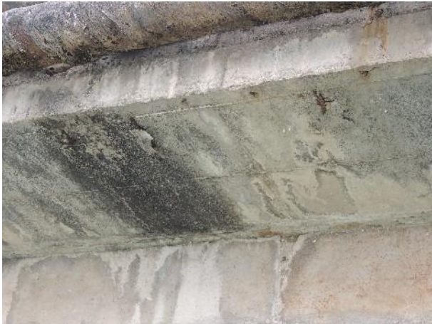
照片 4.2.1-59 16-3#T 梁露筋
