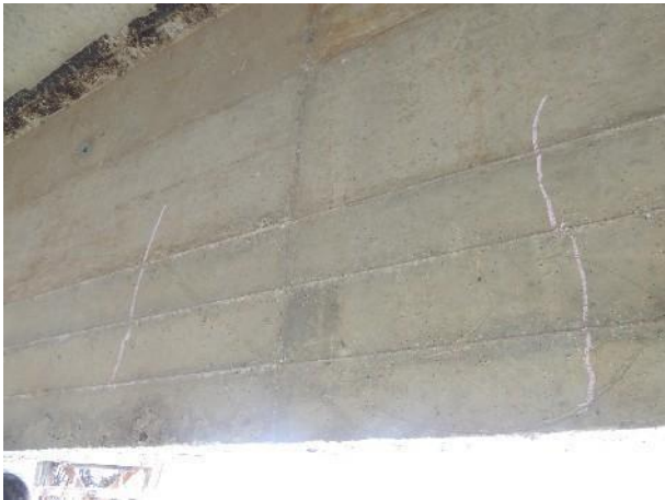
照片 4.2.1-7 2-2#T 梁竖向裂缝
