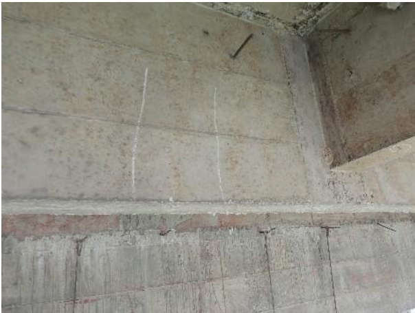
照片 4.2.1-62 18-1#T 梁竖向裂缝
