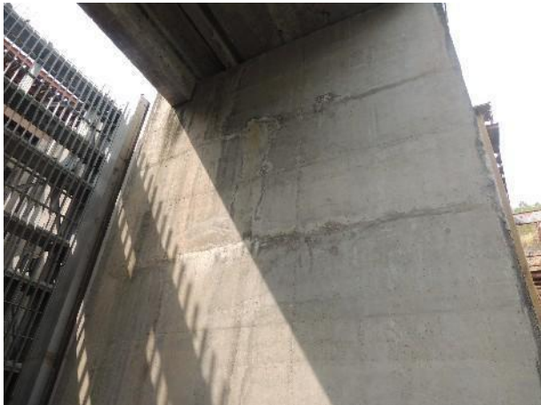
照片 4.1.4-2 0#桥台泛碱痕迹
