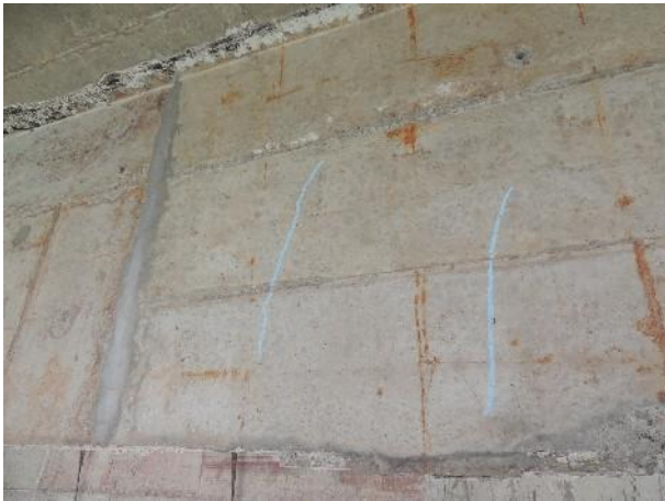
照片 4.2.1-56 16-1#T 梁竖向裂缝
