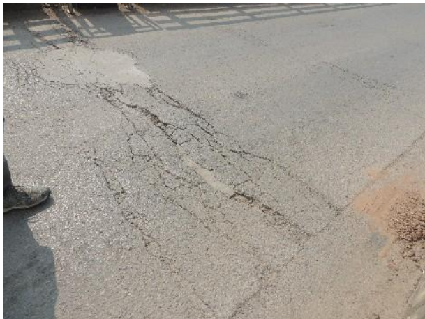
照片 4.2.6-1 桥面铺装破损、开裂
