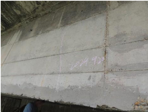
照片 4.2.1-8 2-3#T 梁竖向裂缝
