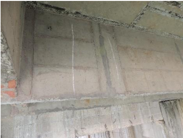
照片 4.2.1-26 7-2#T 梁竖向裂缝
