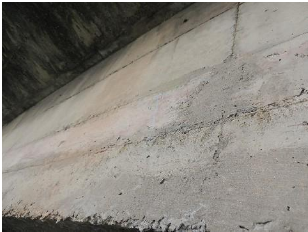
照片 4.2.1-16 4-3#T 梁竖向裂缝
