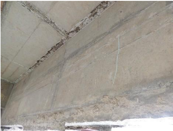
照片 4.2.1-58 16-3#T 梁竖向裂缝
