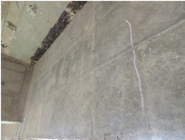
照片 4.2.1-4 1-2#T 梁竖向裂缝
