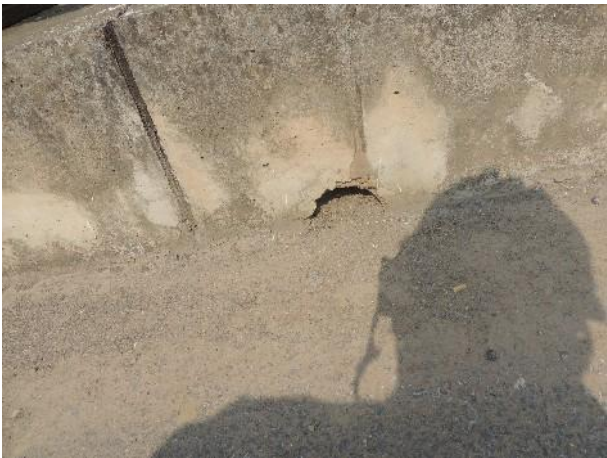
照片 4.2.8-1 排水系统泄水管、引水槽缺陷
