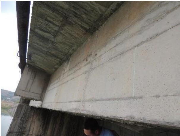
照片 4.2.1-52 14-3#T 梁竖向裂缝
