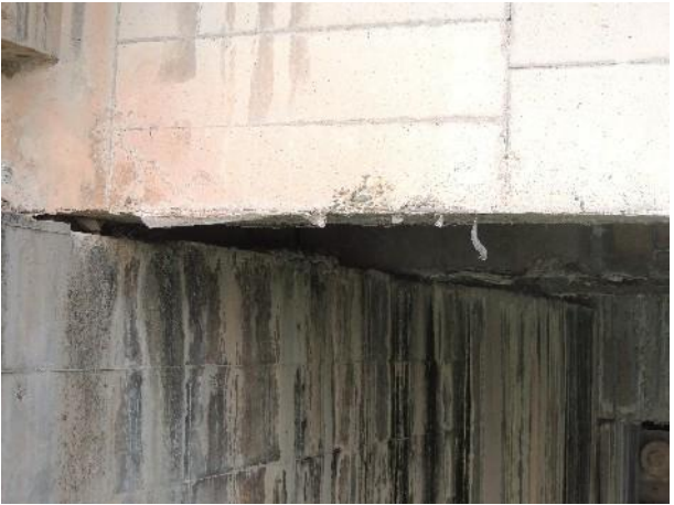
照片 4.2.3-4 5#桥墩剥落
