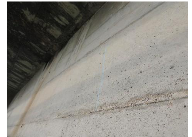
照片 4.2.1-40 10-3#T 梁竖向裂缝
