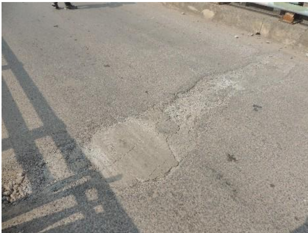
照片 4.2.6-10 桥面铺装横向开裂、破损、沉陷
