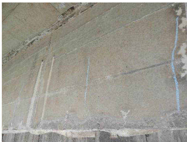
照片 4.2.1-37 10-1#T 梁竖向裂缝
