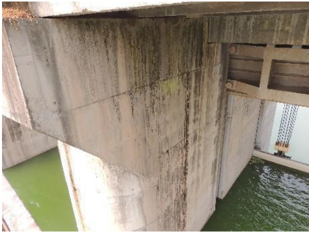
照片 4.2.3-13 1#桥墩~17 桥墩水渍污染
