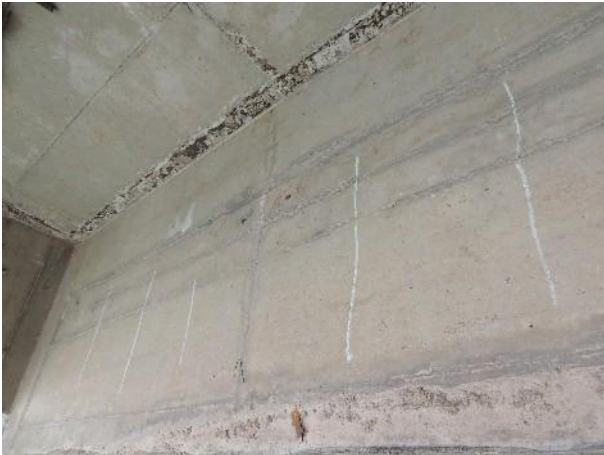
照片 4.2.1-60 17-2#T 梁竖向裂缝
