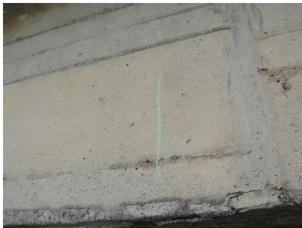
照片 4.2.1-35 9-3#T 梁竖向裂缝
