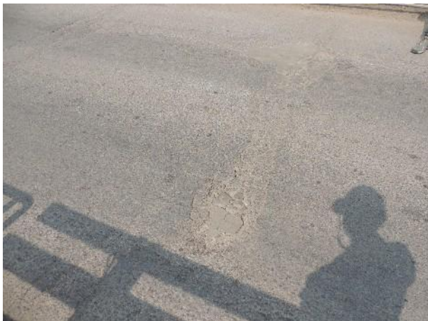
照片 4.2.6-5 桥面铺装破损、沉陷、开裂
