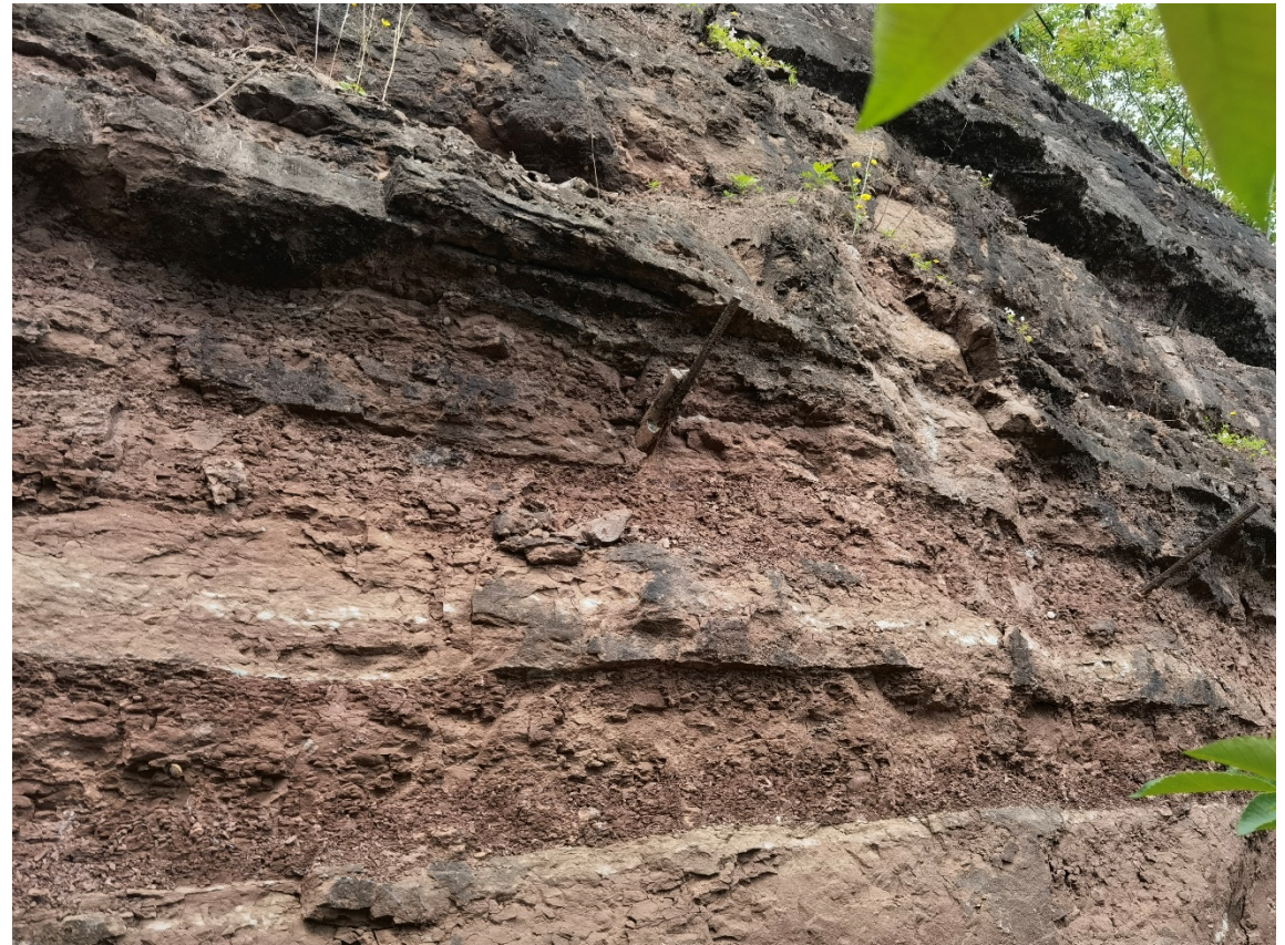
边坡防护损坏情况
