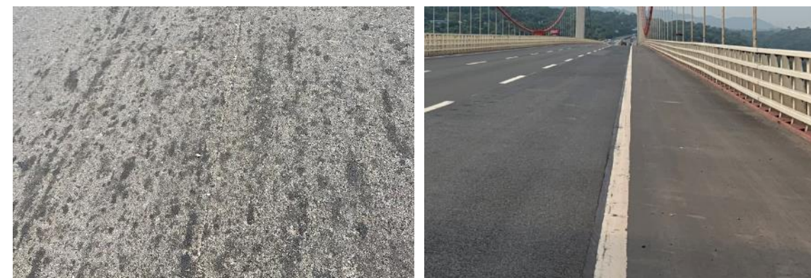
(e) 施工缝纵向开裂（左：原铺装层，右：修补区域）
