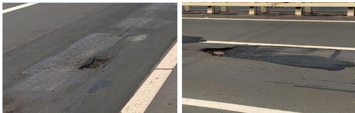
(f) 修补后二次破坏：坑槽、网裂、推移、钢板锈蚀等
