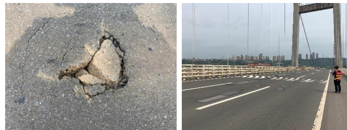
(b) 鼓包、开裂、坑槽（连续坑槽修补）
