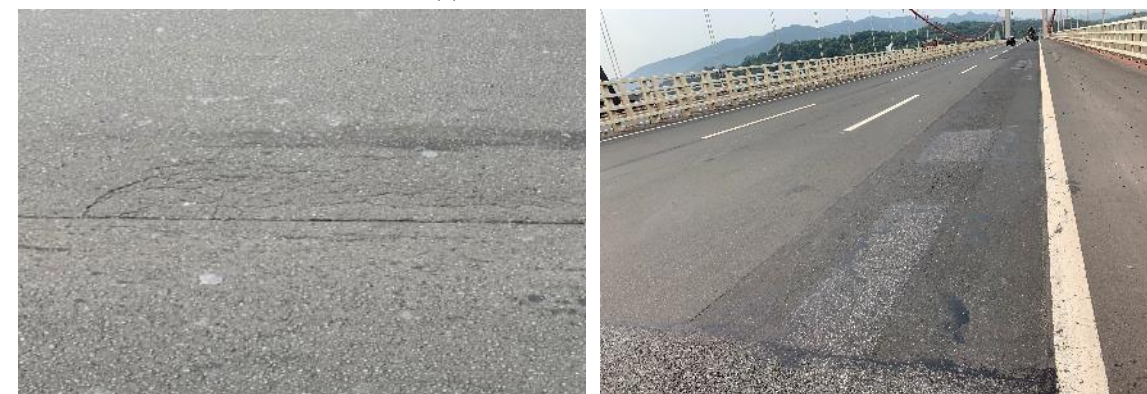
(d) 网裂（左：原铺装层，右：修补区域）
