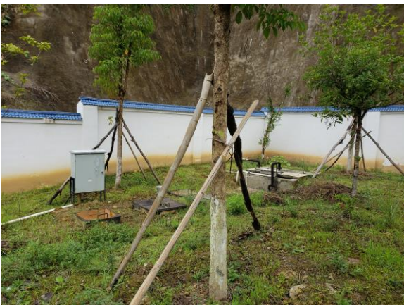
图8-3-9 龙驹收费站污水处理设施
