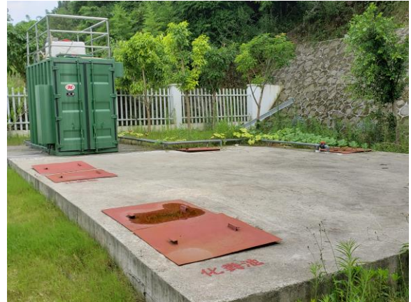
图8-3-6 熊家收费站污水处理设施
