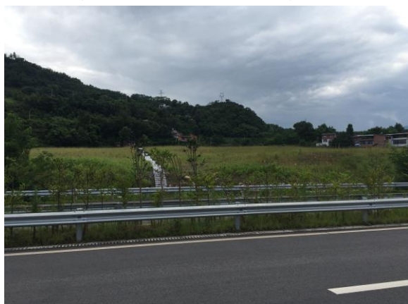
图 6-4-9 k4+400 中央分隔带排水
