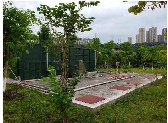
图8-3-8 五桥收费站污水处理设施
