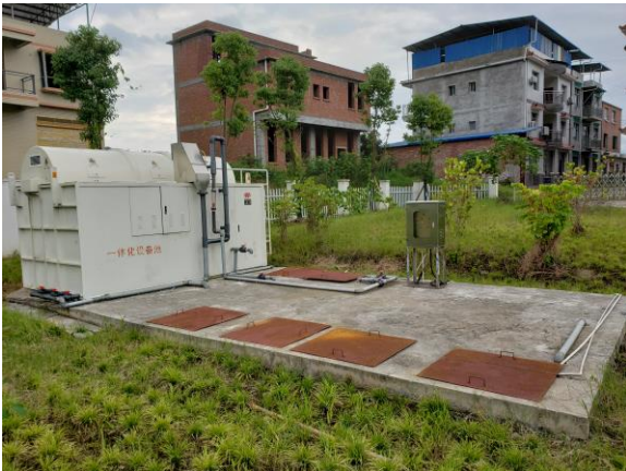
图8-3-7 江南收费站污水处理设施
