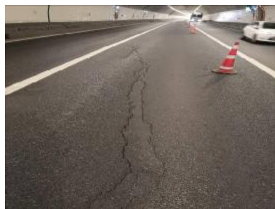
图 7-2 K47+014~K46+930 路面纵向裂缝
