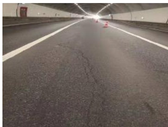
图 7-1 K47+024~K47+016 路面纵向裂缝
