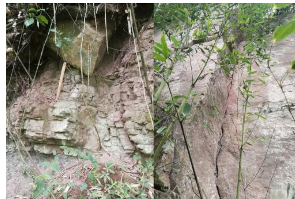
图 3.5 陡崖下部小块危岩体即将坠落
