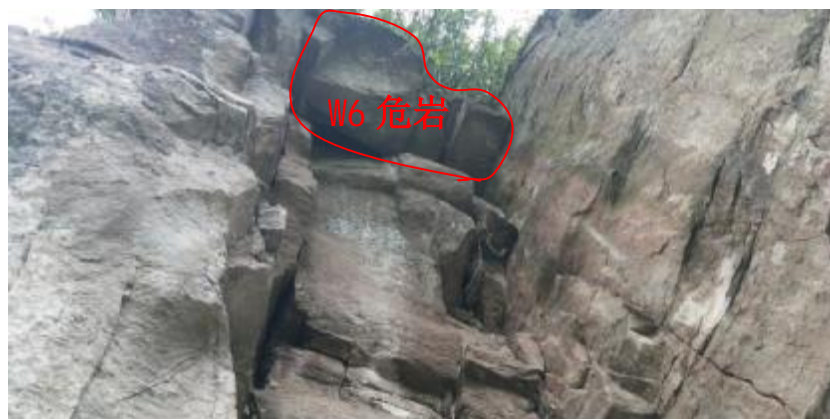
图 3.9 危岩体顶部构造裂隙切割形成松动块石
