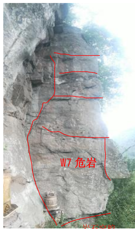
图 3.7 陡崖带卸荷裂隙形成危岩体
