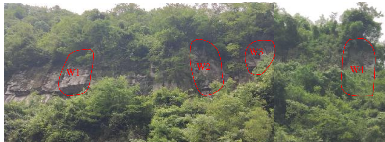
照片 3.1 K1536+000~K1536+300 段坡顶陡崖危岩带
