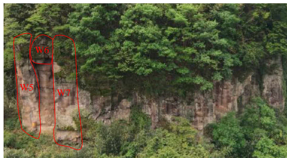
照片 3.2 K1536+300~K1536+420 段坡顶陡崖危岩带
