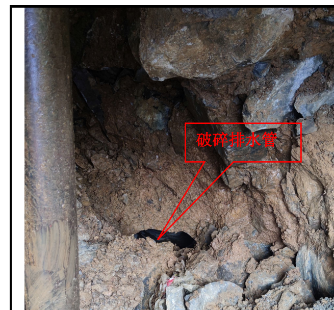
图 4.1-2 ZK1 钻孔位置排水管破坏照片
