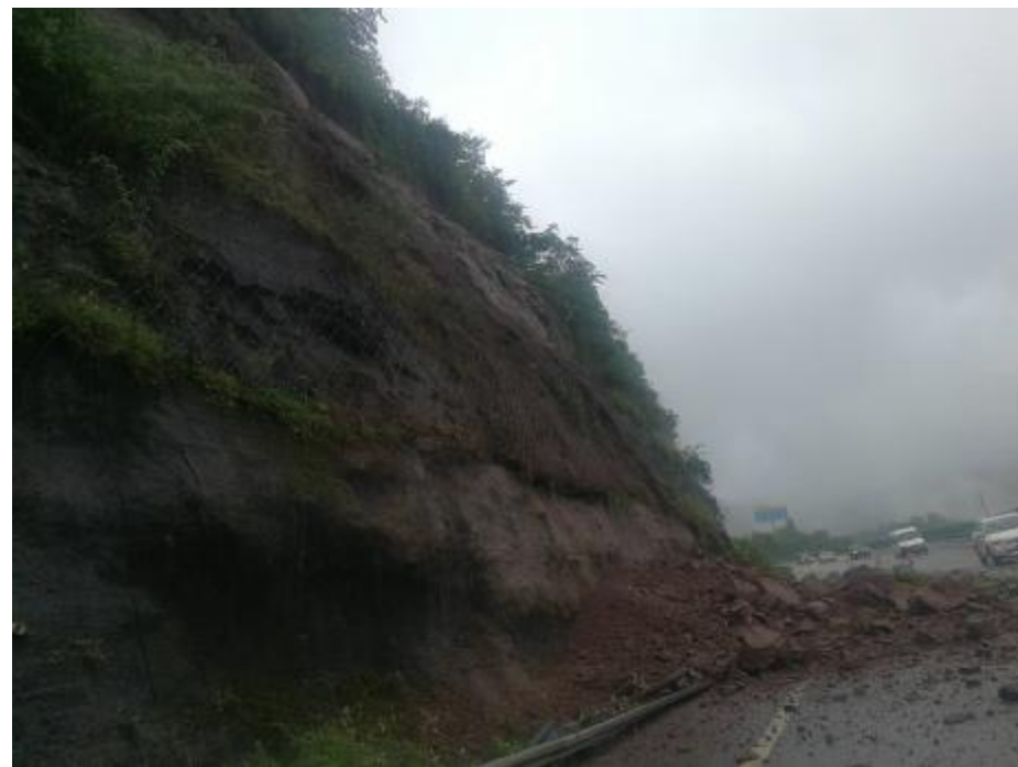
K1497+400~K1497+740 段左侧高边坡崩塌体上路阻断交通
