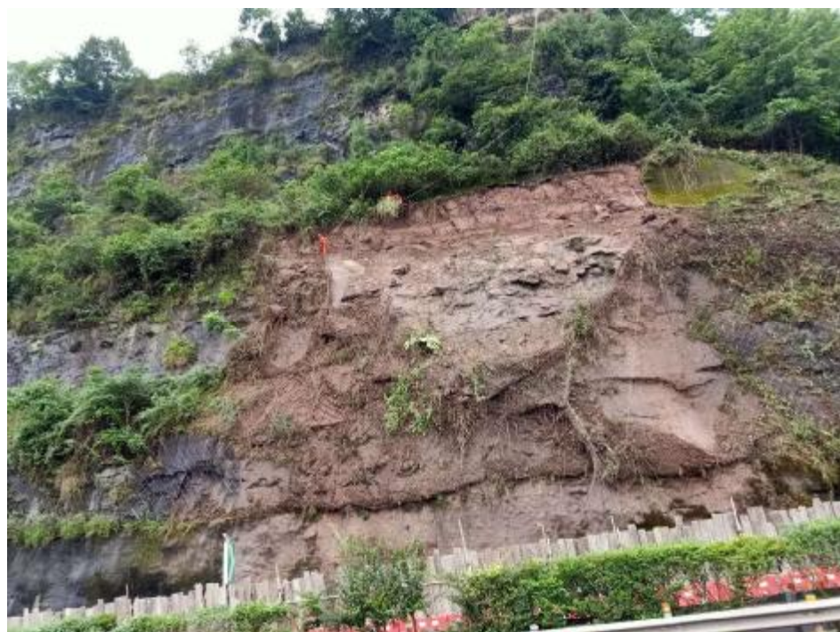
照片 3.3 四级边坡坡面发生崩塌
