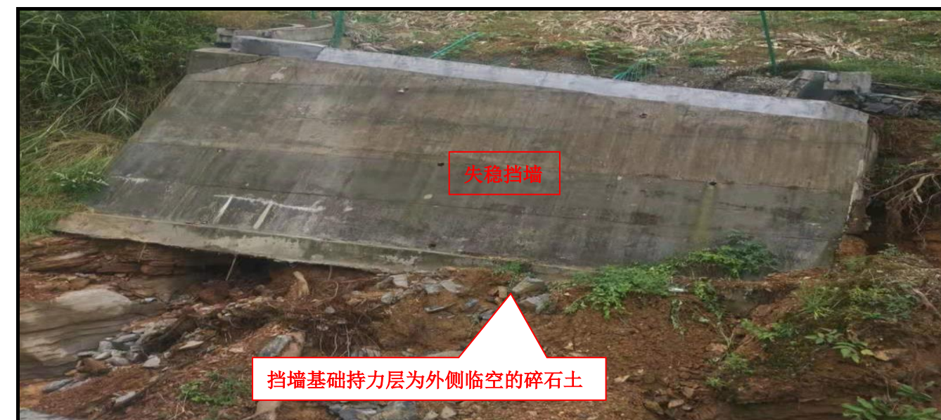
图 4.1-1 失稳挡墙和基础持力层（临空的碎石土）照片
