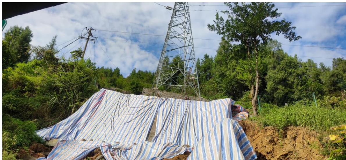
图 1.1-1 垮塌边坡及上部高压线塔照片
