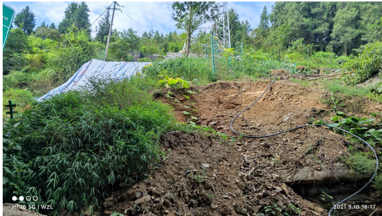
图 4.1-3 临近东侧边坡局部垮塌照片
