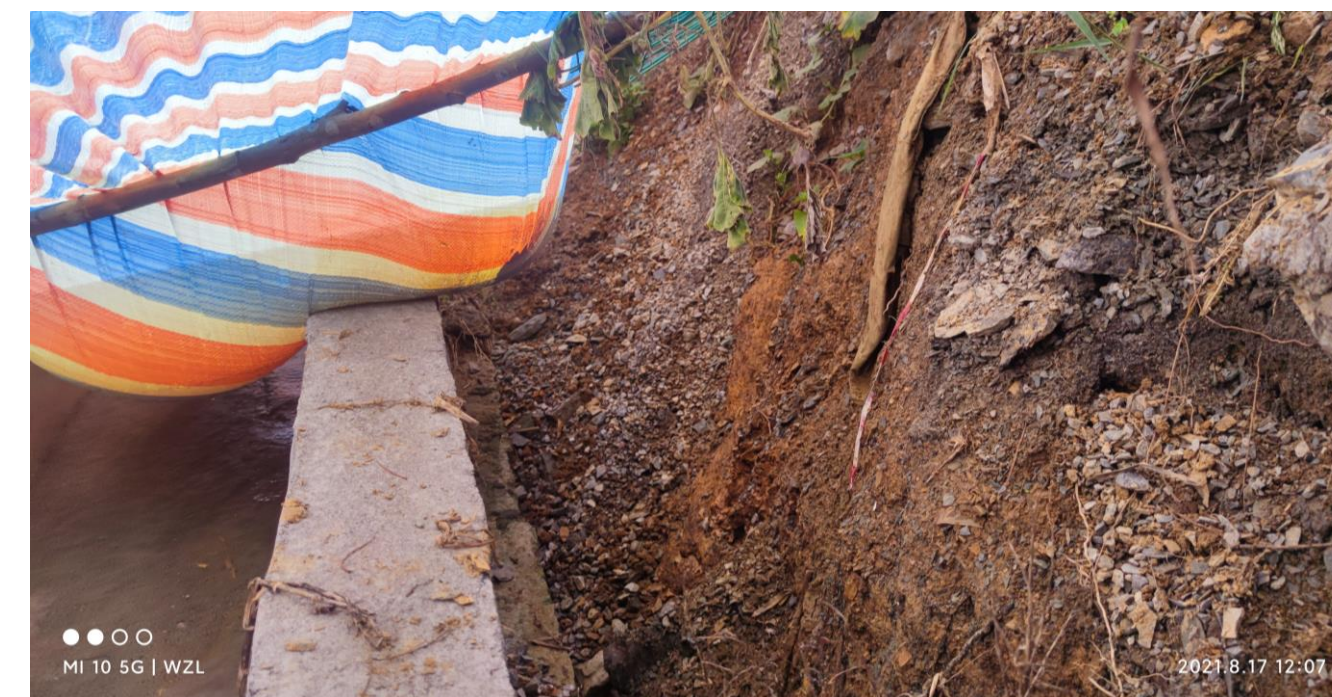
图 4.1-2 坡顶垮塌后缘和排水沟下沉照片
