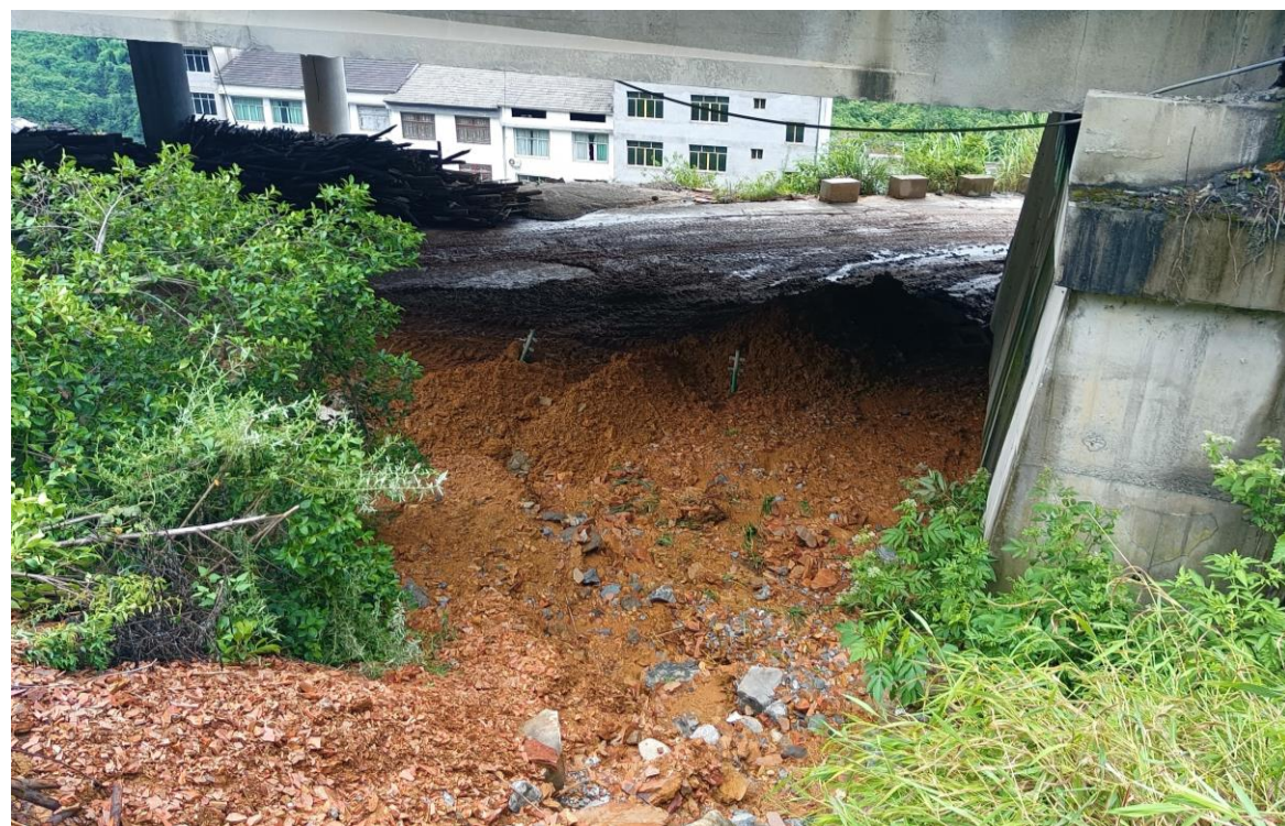
图 1.1-2 边坡垮塌土方冲积村道照片
