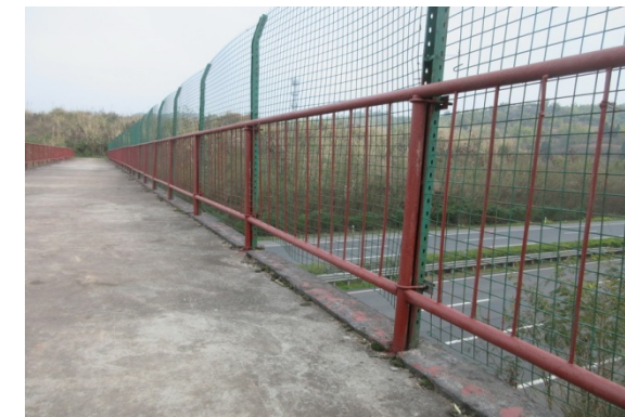
图 4.12-4 右侧不锈钢栏杆现状
