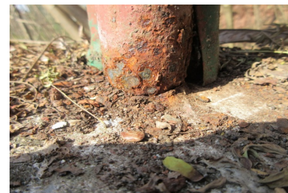
图 4.7-3 立柱柱脚锈断状况
