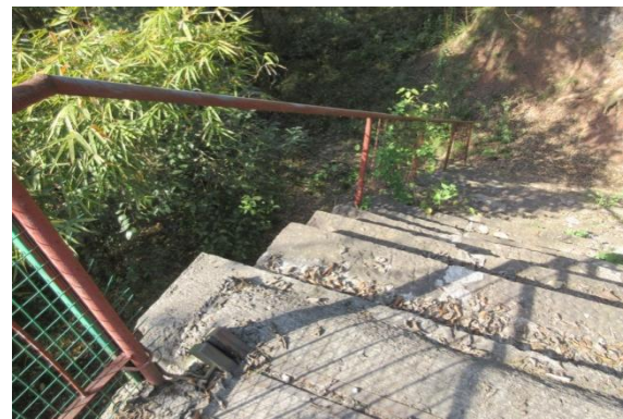
图 4.8-4 2#台处梯步栏杆立柱缺失
