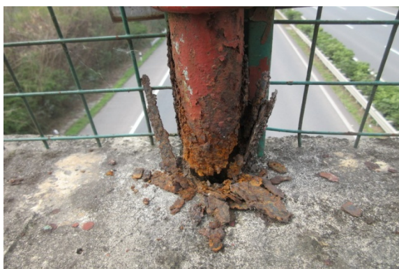
图 4.6-4 栏杆柱脚锈断状况
