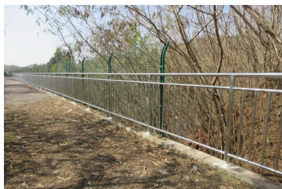
图 4.9-3 左侧不锈钢栏杆现状
