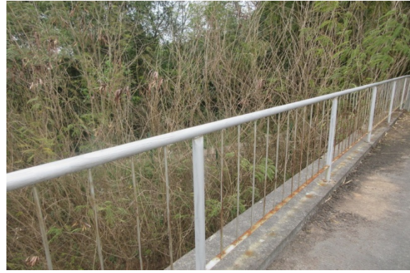
图 4.3-3 栏杆底部锈蚀
