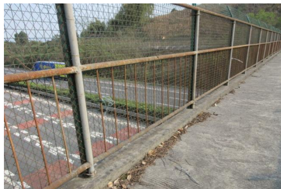
图 4.1-4 右侧栏杆锈蚀
