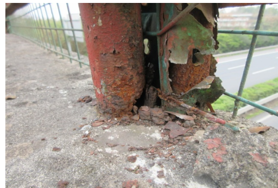
图 4.5-3 栏杆柱脚锈断状况
