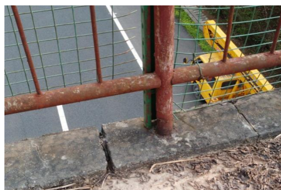
图 4.11-3 桥面栏杆立柱柱脚锈断
