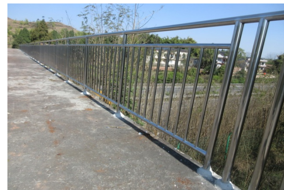
图 4.10-4 右侧不锈钢栏杆现状
