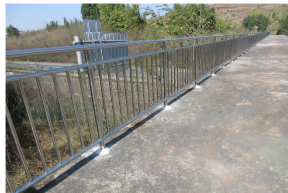
图 4.10-3 左侧不锈钢栏杆现状
