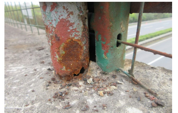
图 4.5-4 栏杆柱脚锈断状况
