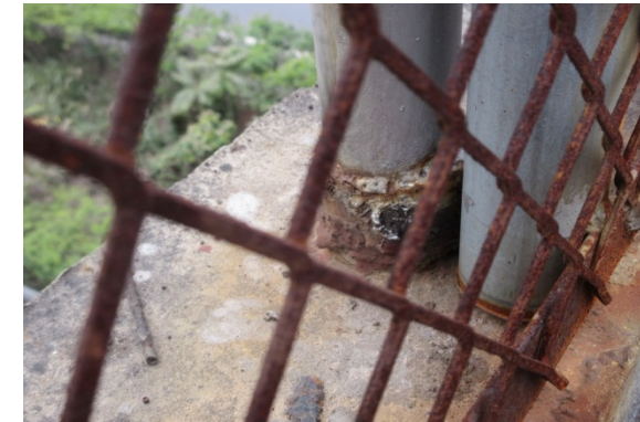
图 4.2-3 立柱柱脚处锈蚀无防腐涂刷
