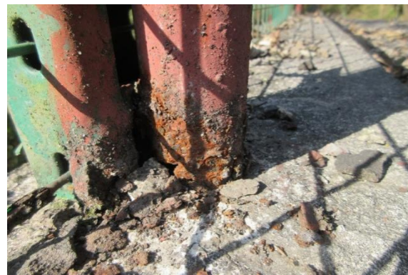
图 4.8-3 桥面栏杆立柱柱脚锈断
