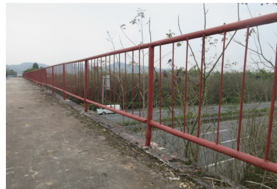
图 4.12-3 左侧不锈钢栏杆现状
