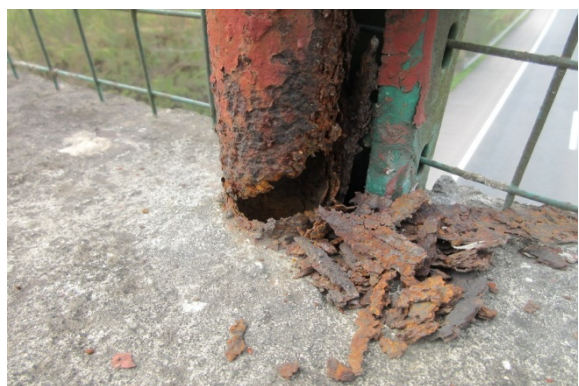
图 4.6-3 栏杆柱脚锈断状况
