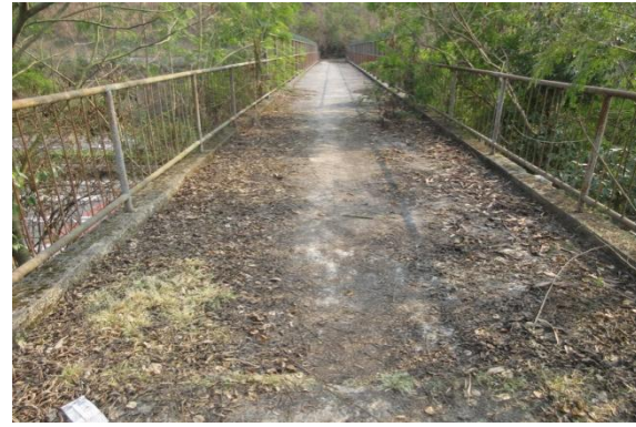
图 4.1-1 桥梁正面照 两侧栏杆、防抛网存在严重锈蚀病害。
