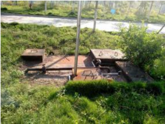
图8-3-8 竹溪收费站污水处理设备
