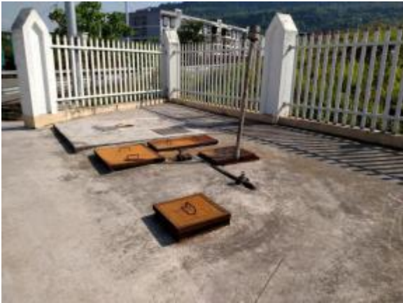
图8-3-10 南雅收费站污水处理设施
