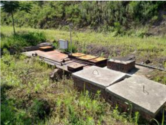
图8-3-9 开州区服务区污水处理设备
