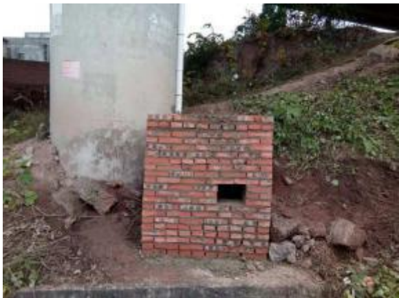
图 8-3-6 南河大桥沉淀事故池
