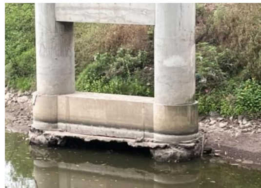
照片 4-3-1 桥墩河水冲刷、骨料外露
