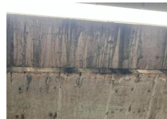
照片 3-3-3 左幅底板锈胀
