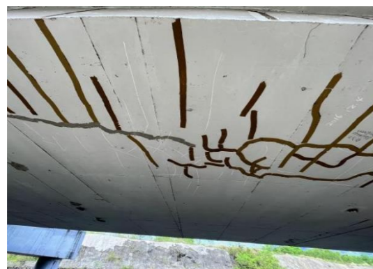
照片 3-6-5 第 8 跨梁底板裂缝多条 各修复裂缝有发展现象
