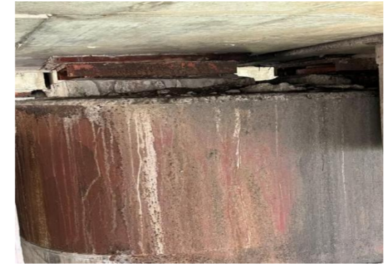
照片 3-5-4 左幅 6-2#墩柱外包钢护筒锈蚀
