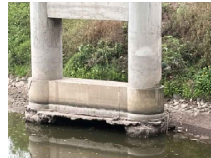
右幅5#桥墩基础冲刷病害示意图
