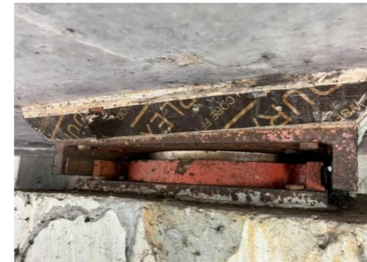
照片 3-5-5 右幅 1-1-2#支座钢板锈蚀
