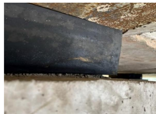
照片 3-4-5 左幅 2-1-4#支座底面脱空
