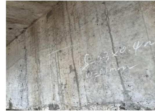
照片 3-5-3 左幅第 1 跨箱梁腹板网状裂缝
