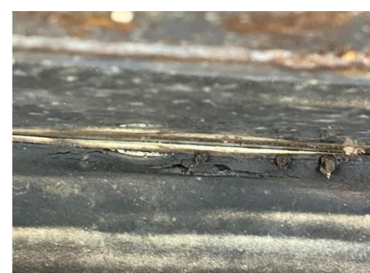
照片 3-1-10 R-32-31-1#支座滑板脱离开裂
