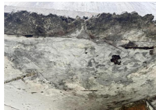
照片 3-6-4 5#盖梁底部破损露筋
