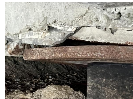
照片 3-1-9 R-32-31-1#支座钢板翘曲
