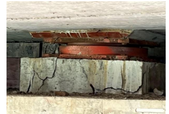
照片 3-5-6 1-0-3#支座垫石开裂严重
