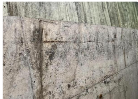
照片 3-6-3 第 3 跨梁底板右侧锈胀
