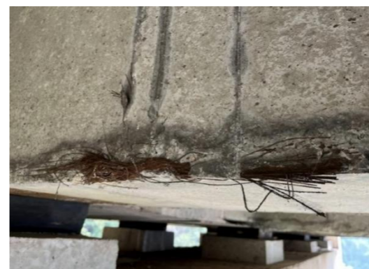
照片 3-4-3 左幅 2-4#T 梁底部夹渣
