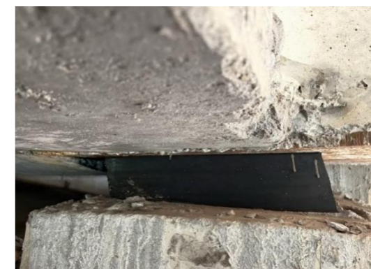
照片 3-4-6 左幅 4-4-5#支座纵向剪切变形
