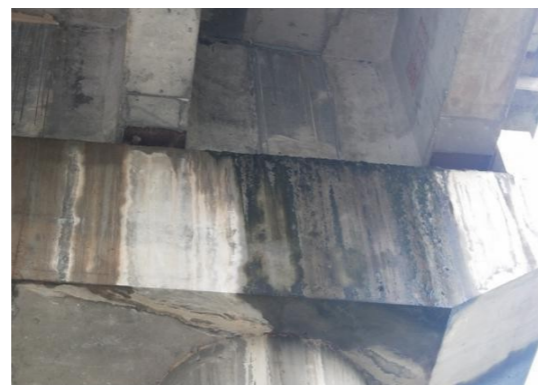
照片 3-1-6 R-4#盖梁渗水污染
