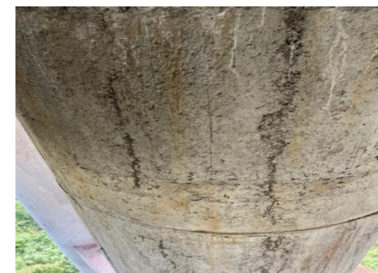
照片 3-4-4 左幅 2-2#墩柱顶部大面积麻面
