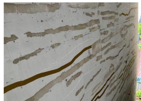
照片 3-6-6 第 9 跨梁底板横、纵裂缝多条 各修复裂缝有发展现象
