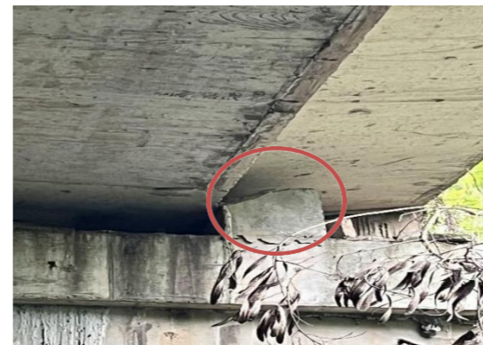
照片 3-2-4 右侧 1#桥台右侧挡块砼破损
