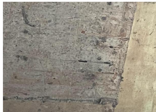
照片 3-2-3 左幅现浇梁底板锈胀
