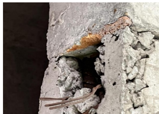
照片 3-1-5 R-17-1-1#端隔板现浇段底部空洞
