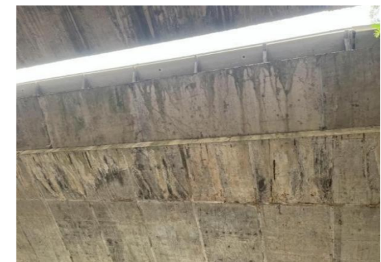
照片 3-3-4 右幅底板锈胀
