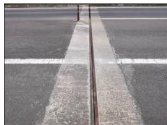
图 3.8-1 L1#伸缩缝失效卡死
