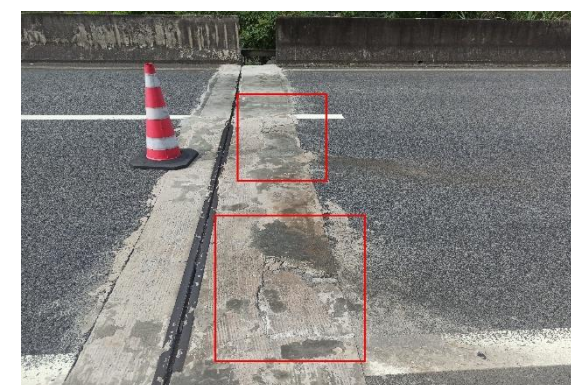
图 3.26-1 L1#伸缩缝锚固区破损
