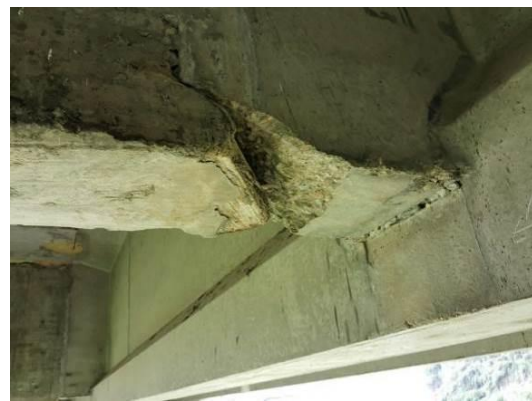
图 3.4-4 L18-2-3#横隔板底面剥落、掉角漏筋
