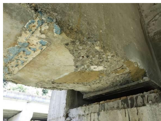
图 3.1-2 4-5#T 梁梁底剥落、掉角露筋
