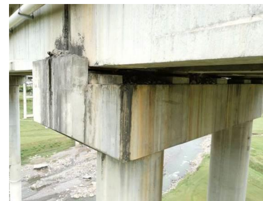
图 3.4-6 L12#盖梁受水侵蚀
