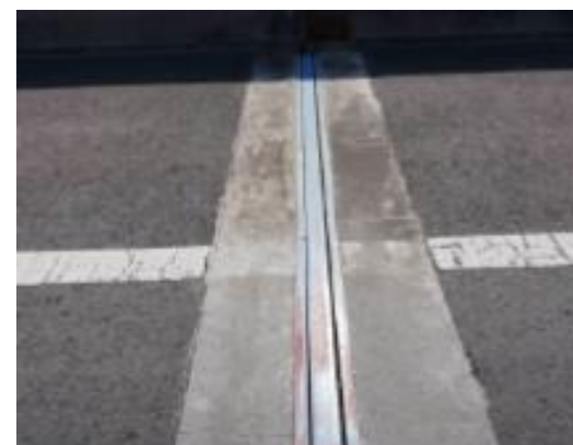
图 3.14-4 R3#伸缩缝失效卡死
