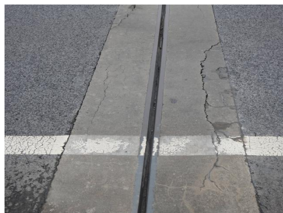
图 3.20-1 R3#伸缩缝锚固区破损
