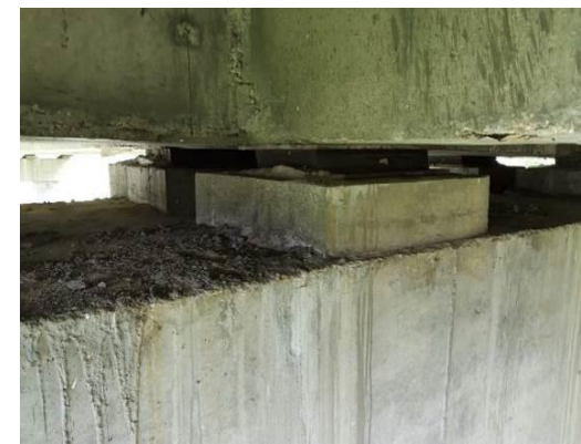
图 3.4-5 L-19-18-4#支座小桩号面剪切变形纵向
