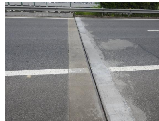
图 3.22-1 L6#伸缩缝锚固区破损
