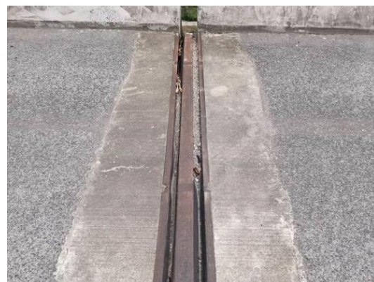
图 3.5-8 R2#伸缩缝堵塞
