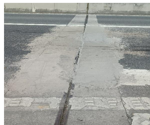
图 3.15-1 R0#伸缩缝锚固区破损
