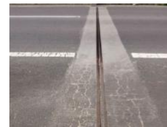
图 3.7-2 R2#伸缩缝堵塞
