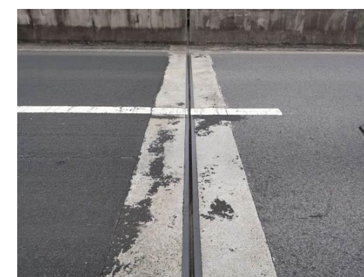
图 3.3-6 R1#伸缩缝锚固区缺陷开裂
