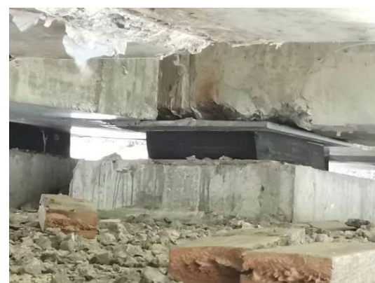
图 3.1-6 1-1-3#支座大桩号面剪切变形
