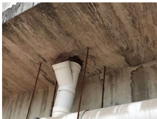
图 3.4-1 L2-1#T 梁左翼缘板剥落、掉角露筋
