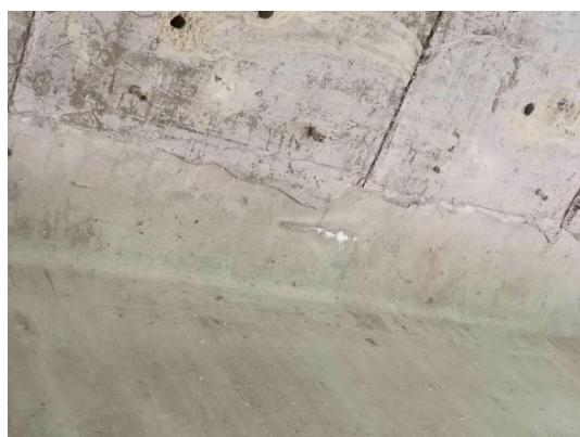
图 3.1-1 4-4#T 梁左翼缘板纵向裂缝
