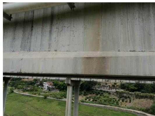
图 3.4-2 L8-1#T 梁马蹄左侧面纵向裂缝
