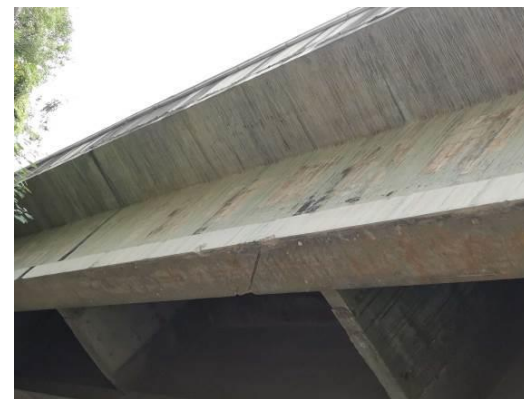
图 3.5-1 R-1-1#T 梁马蹄右侧面剥落、掉角
