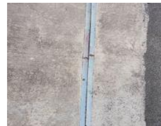
图 3.14-2 R1#伸缩缝失效卡死
