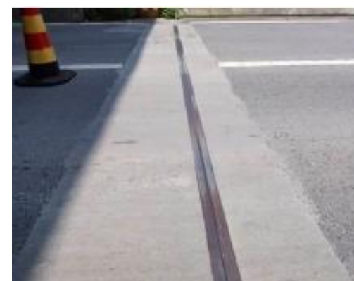
图 3.11-2 L2#伸缩缝锚固件、止水带破损
