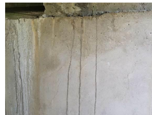
图 3.1-6 4#盖梁小桩号面网状裂缝
