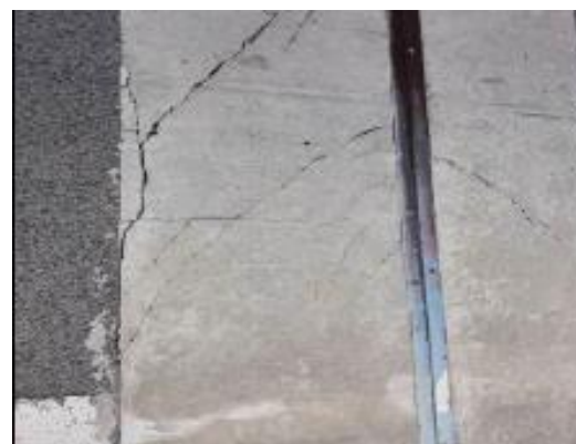
图 3.14-3 R1#伸缩缝锚固区、止水带破损
