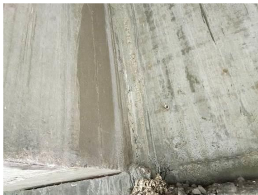
图 3.4-3 L6-1-1#横隔板大桩号面纵向裂缝
