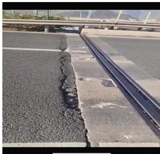
图 3.16-1 L1#伸缩缝锚固区破损
