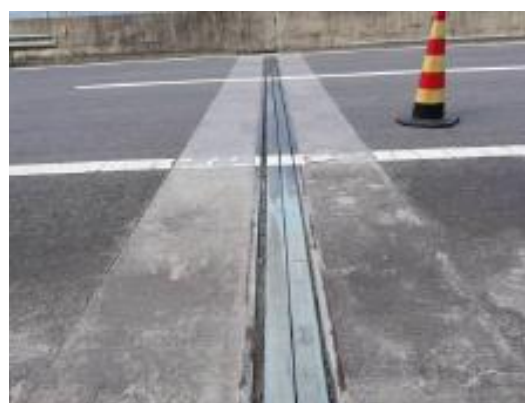
图 3.13-1 L2#伸缩缝失效卡死
