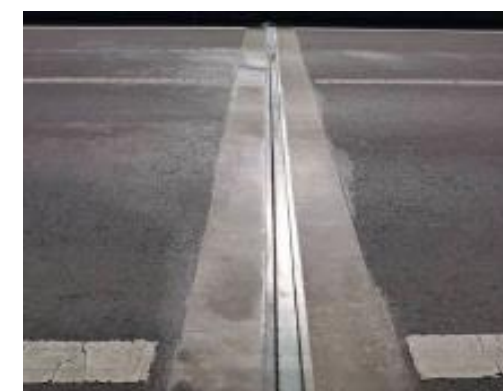
图 3.10-2 R2#伸缩缝失效堵塞
