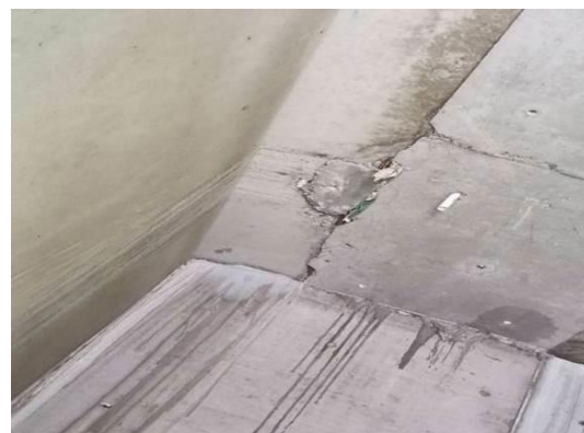
图 3.2-2 L8-3#T 梁左腹板剥落、掉角露筋
