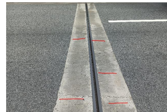
图 3.25-1 L7#伸缩缝锚固区破损
