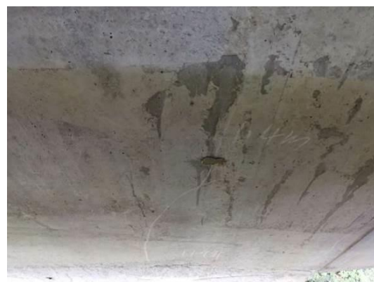
图 3.2-7 L4#盖梁大桩号面竖向裂缝
