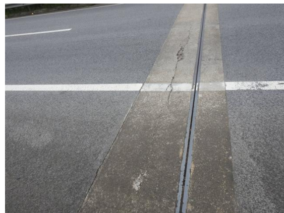
图 3.23-1 L9#伸缩缝锚固区破损
