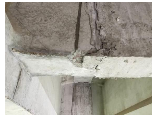
图 3.2-3 L2-1-2#横隔板底面剥落、掉角
