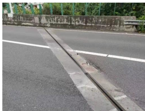
图 3.17-1 L1#伸缩缝锚固区破损
