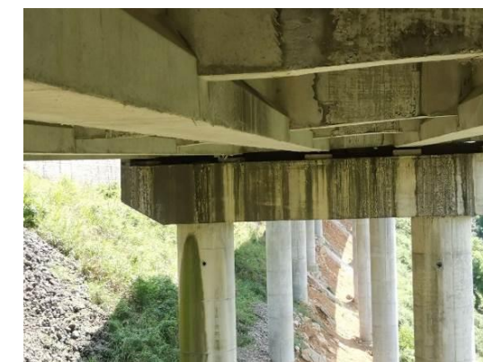
图 3.1-7 5#盖梁受水侵蚀
