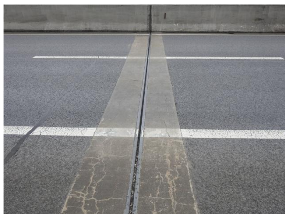
图 3.19-1 L1#伸缩缝锚固区破损
