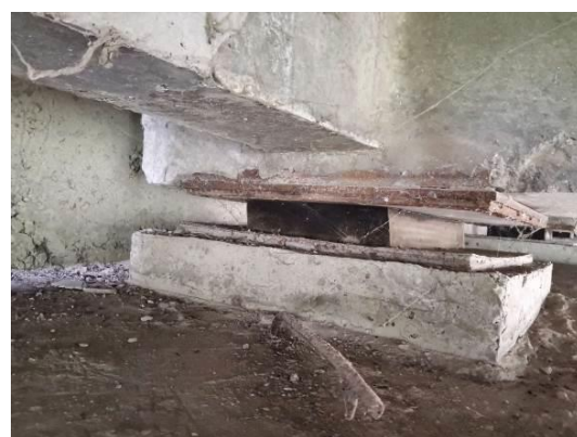
图 3.3-3 R-1-4#支座大桩号面板式剪切超限纵向
