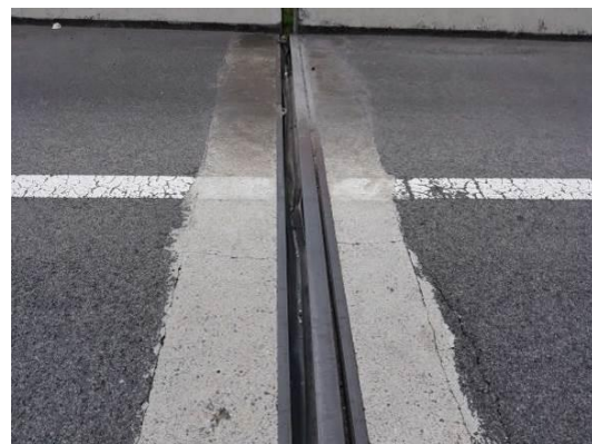
图 3.4-8 L5#伸缩缝锚固区缺陷开裂
