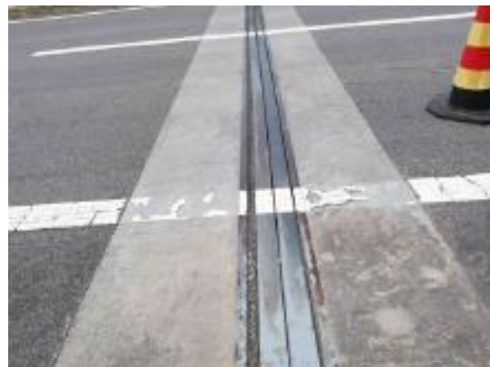
图 3.13-2 L2#伸缩缝锚固件、止水带破损
