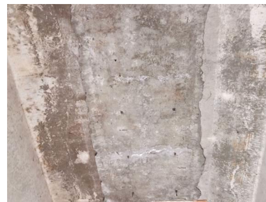
图 3.5-3 R-2-2#湿接缝横向裂缝
