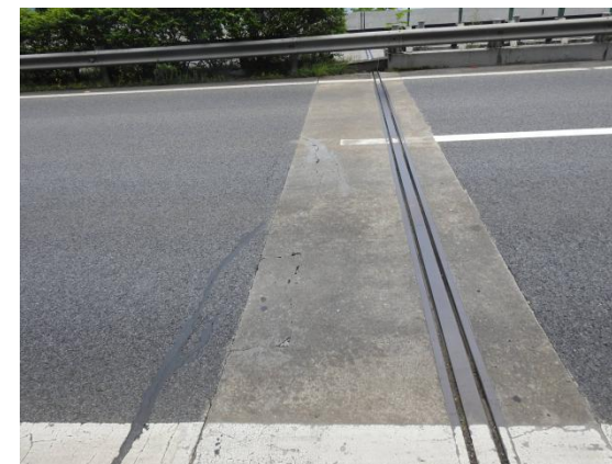
图 3.21-1 R1#伸缩缝锚固区破损
