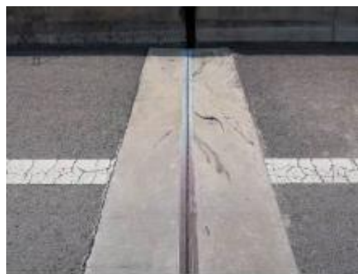
图 3.12-1 R3#伸缩缝失效卡死
