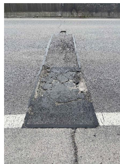
图 3.6-1 R1#桥台处存在变形，混凝土碎裂
