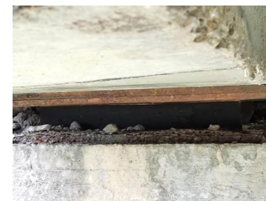
图 3.5-5 R15-15-5#支座小桩号面钢垫板锈蚀
