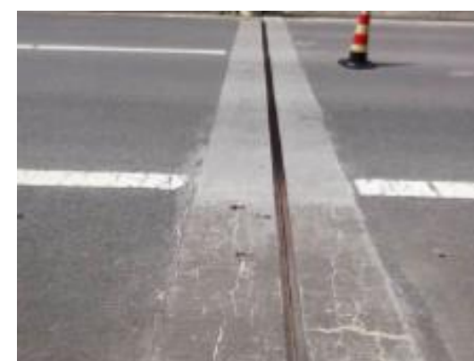
图 3.7-1 R1#伸缩缝失效卡死
