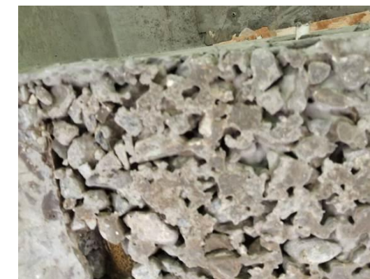
图 3.5-4 R10-4-6#横隔板底面蜂窝、麻面漏筋
