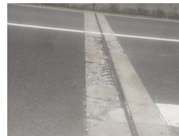
图 3.15-2 R1#伸缩缝锚固区破损
