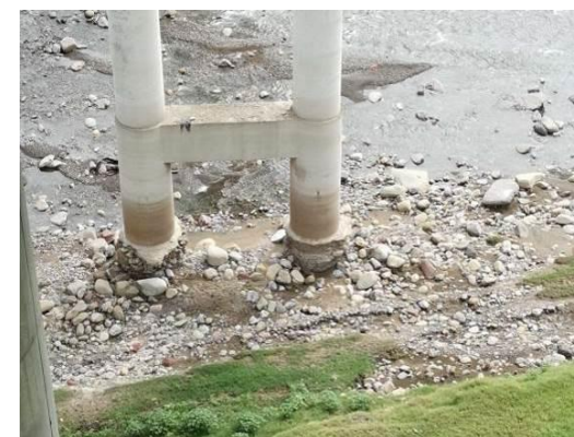
图 3.4-7 L-14-1#桥墩桩基础冲刷、掏空
