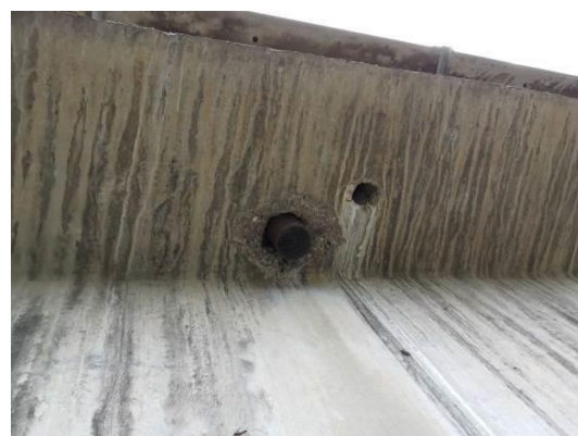
图 3.3-1 R-1-5#T 梁左翼缘板剥落、掉角露筋
