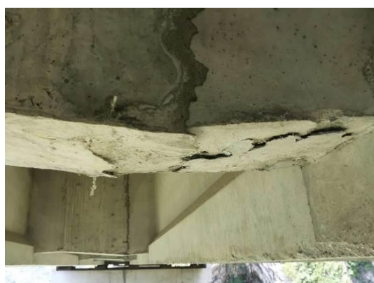
图 3.1-3 3-3-5#横隔板底面剥落、掉角
