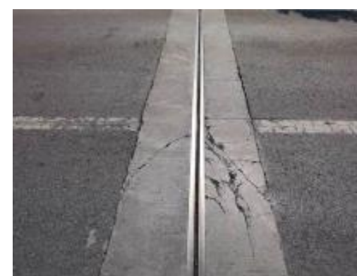
图 3.10-1 R1#伸缩缝锚固区缺陷破损
