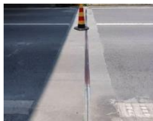
图 3.11-1 L2#伸缩缝失效卡死
