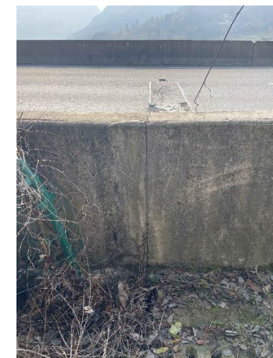
图 3.6-2 R1#桥台处存在变形，混凝土碎裂
