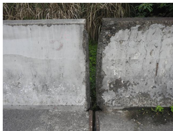
图 3.19-2 L2#伸缩缝锚型钢断裂
