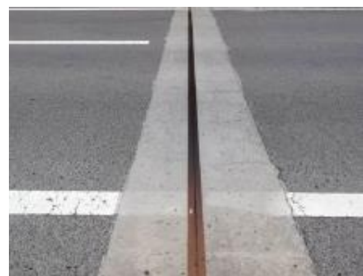
图 3.9-2 R4#伸缩缝锚固区缺陷开裂
