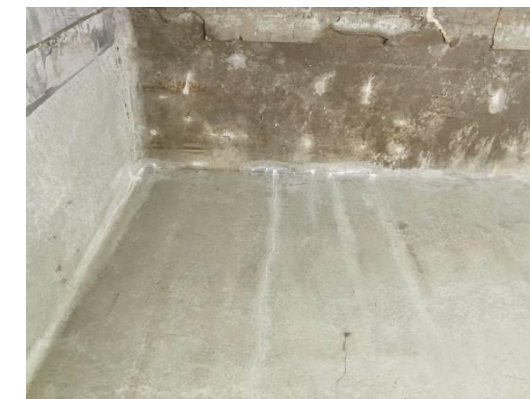
图 3.5-2 R-3-4#T 梁右翼缘板纵向裂缝
