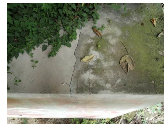
图 3.3-4 R-1#墩台基础承台环向裂缝
