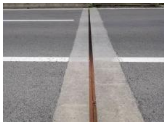
图 3.9-1 R4#伸缩缝失效卡死
