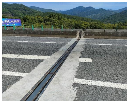
图 3.27-1 R7#伸缩缝锚固区破、型钢断裂
