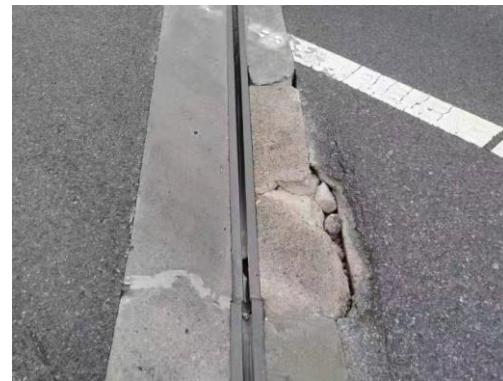
图 3.17-2 L1#伸缩缝型钢断裂
