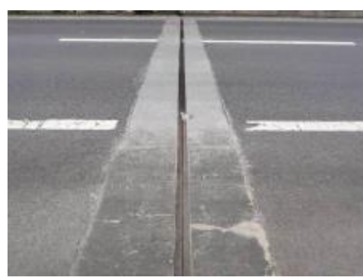
图 3.8-2 R1#伸缩缝失效卡死
