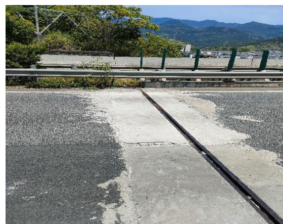
图 3.24-1 R0#伸缩缝锚固区破损、型钢断裂
