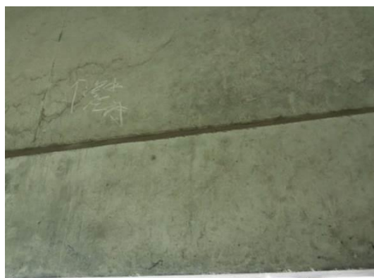
图 3.2-1 L3-3#T 梁左腹板纵向裂缝
