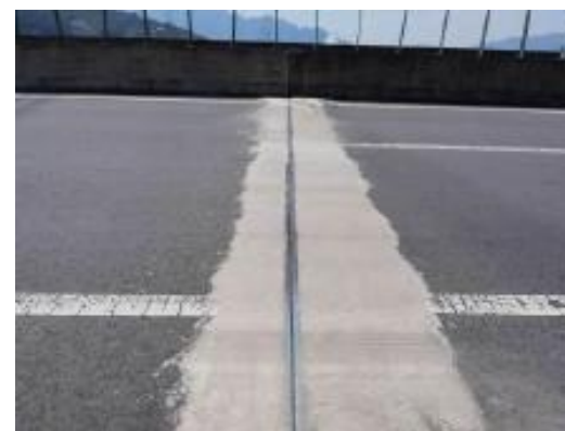
图 3.14-1 L1#伸缩缝失效卡死
