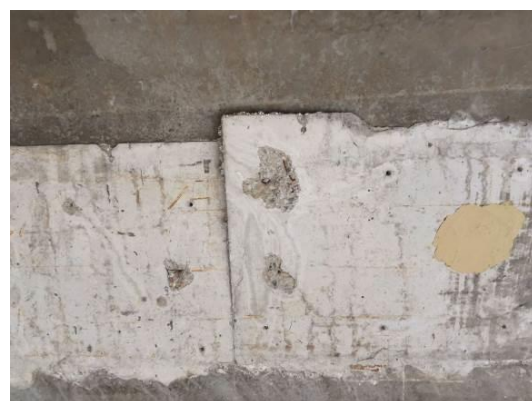
图 3.3-2 R-1-2#湿接缝剥落、掉角
