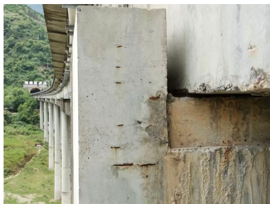
图 3.5-6 R10#盖梁左侧挡块钢筋锈蚀胀裂剥落
