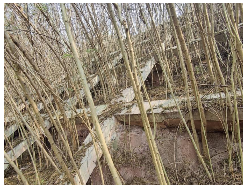
图 4-1 框架梁底悬空情况
