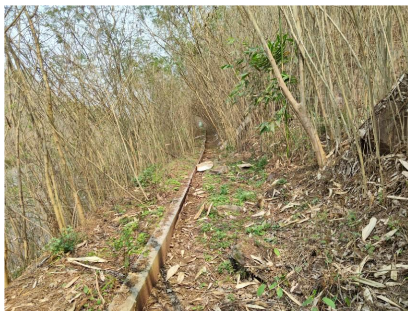
图 4-2 截水沟堵塞破损情况
