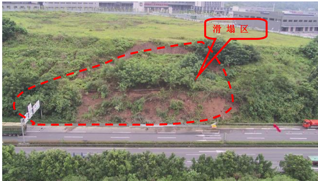
照片 2.2-1 边坡滑塌区全面图
