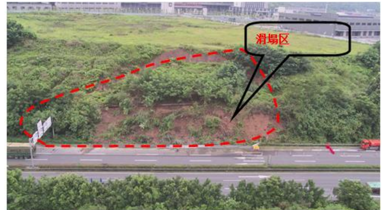
照片 4.2-1 边坡滑塌区照片全貌
