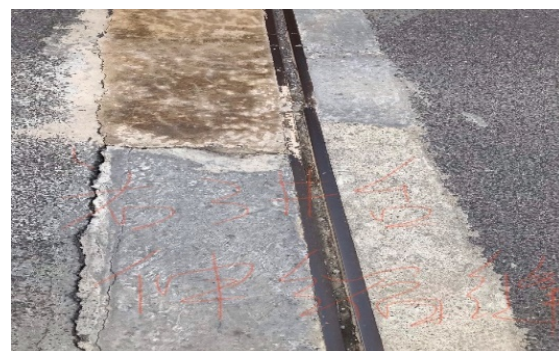
图 5.1-14 右幅 3#台锚固区裂缝
