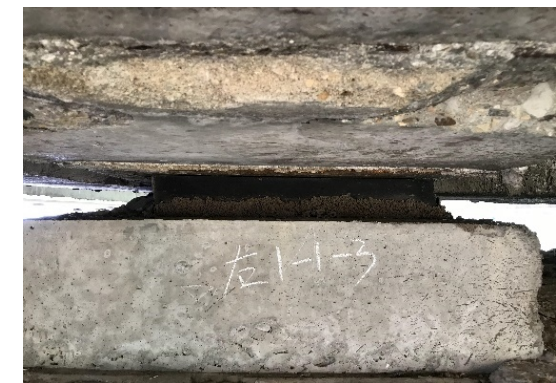
图 5.1-8 右幅支座脱空
