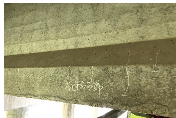
图 5.1-4 右幅 4#梁右侧腹板、翼板纵向裂缝
