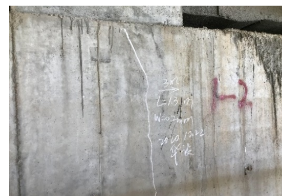
图 5.1-11 右幅盖梁竖向裂缝
