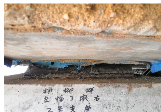
图 5.1-6 左幅支座剪切变形、脱空
