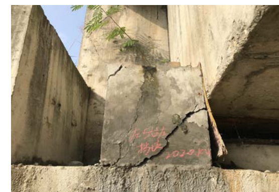
图 5.1-10 左幅 5#台左侧挡块开裂
