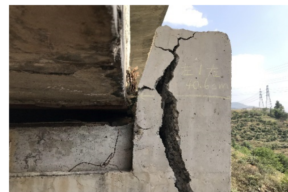
图 5.1-9 左幅 1#墩挡块开裂
