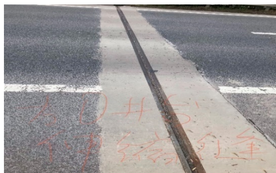
图 5.1-13 左幅 0#台槽口堵塞、锚固区裂缝
