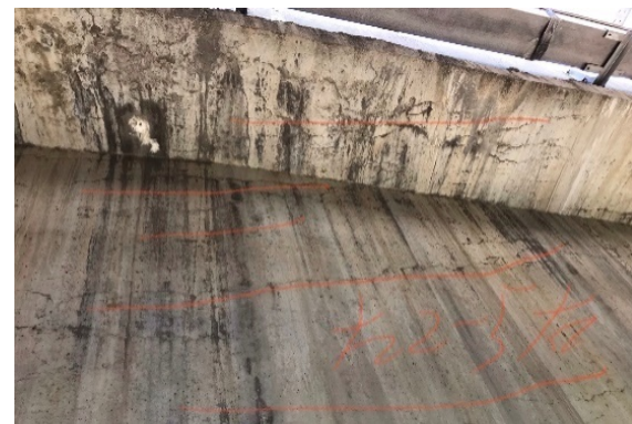
图 5.1-2 左幅 5#梁右侧腹板、翼板纵向裂缝
