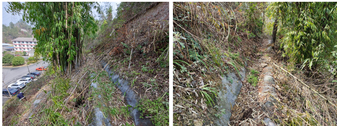
图 2 挖方边坡后方情况（截水沟堵塞）
