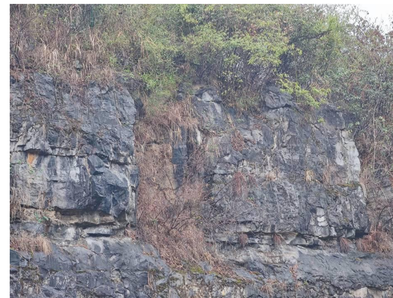
图 1.3 坡面岩体裂隙发育
