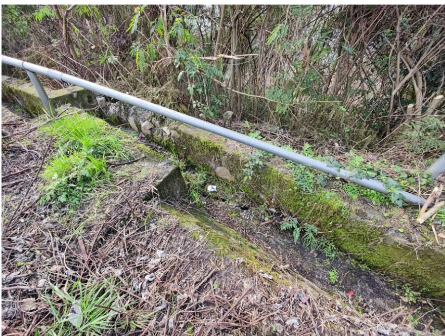
图 1.6 路基边沟开裂情况 (路基外侧)
