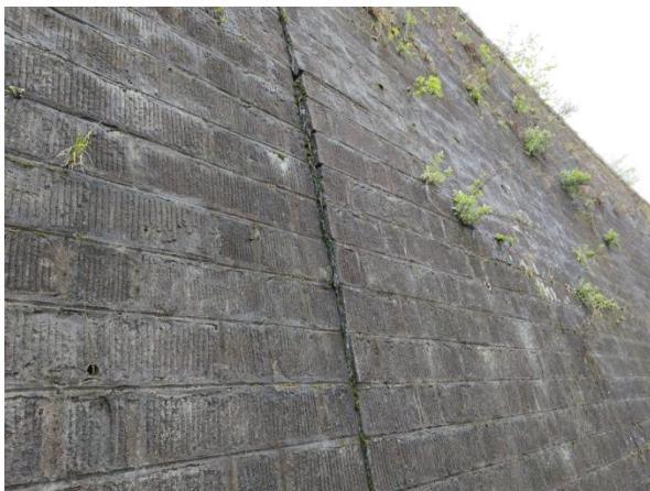
图 1 护面墙伸缩缝处鼓胀、错台
