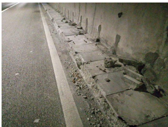
图 6-9 隧道检修道路缘石破损
