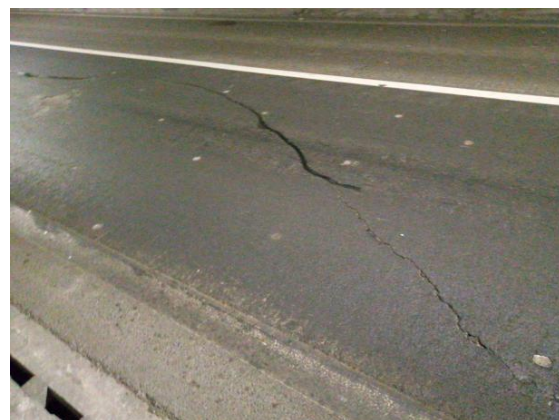
图 6-12 隧道路面纵向裂缝
