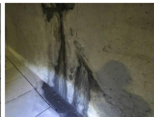
图 6-8 隧道衬砌渗水
