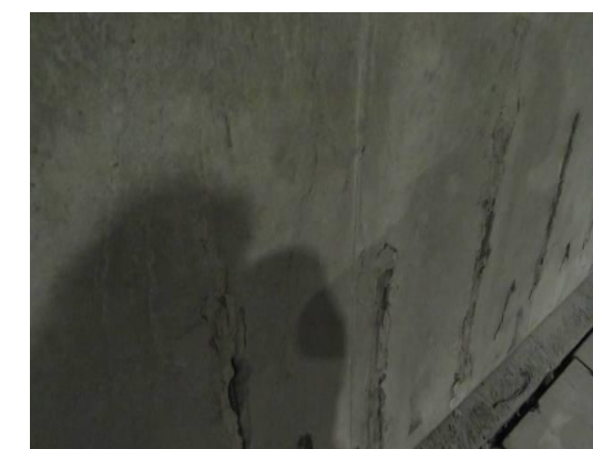
图 6-7 隧道锈胀、露筋
