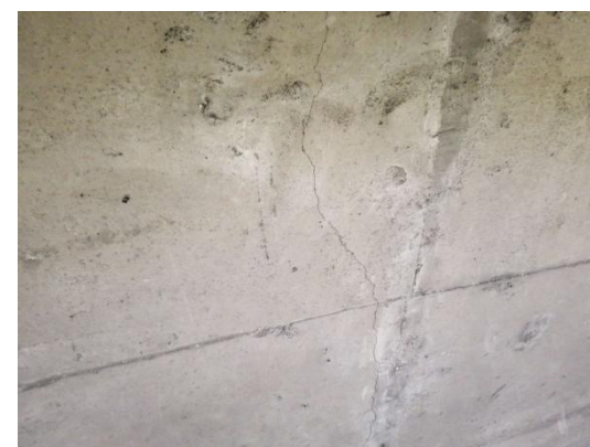
图 6-3 隧道衬砌环向裂缝
