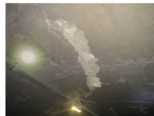
图 6-5 隧道拱顶衬砌破损
