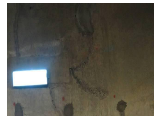
图 6-6 隧道衬砌起层、剥落
