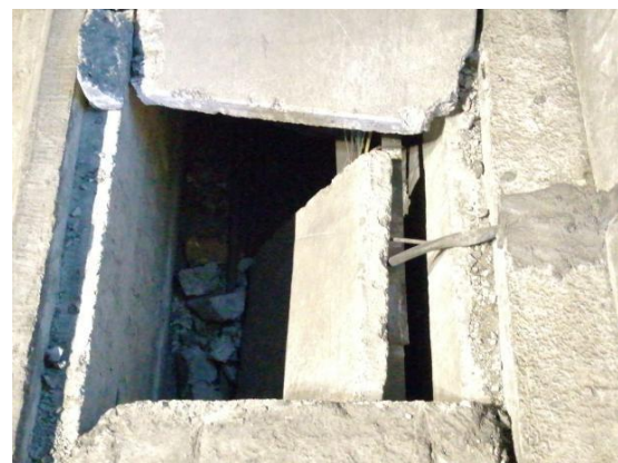
图 6-10 隧道检修道盖板破损
