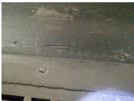
图 6-11 隧道路面坑槽
