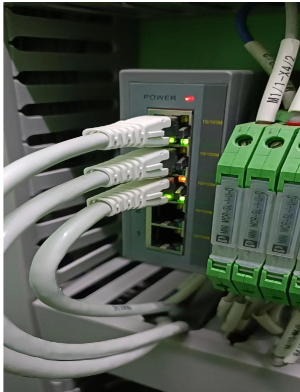
图 1：调速器交换机故障
