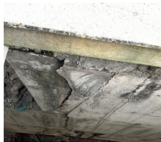
图 4.1-3 左幅 4#桥台侧墙竖向开裂
