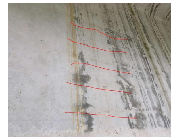
图 3.13-2 R13-1#T梁左腹板纵向裂缝
