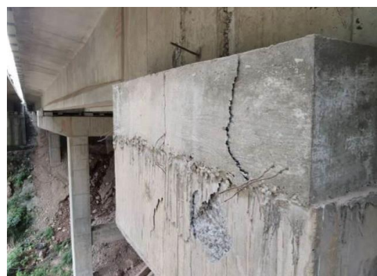
图 3.1-7 L3#盖梁右侧挡块混凝土破损
