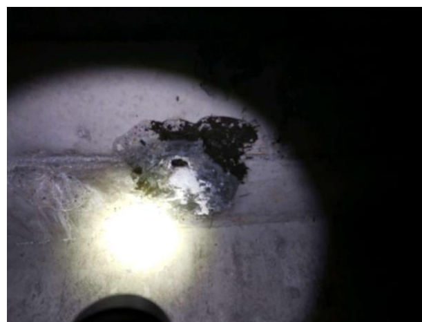
图 3.14-1 L6-6-8#节段箱梁内侧顶板破损
