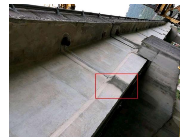
图 3.4-2 R1-7#T 梁马蹄右侧面受水侵蚀
