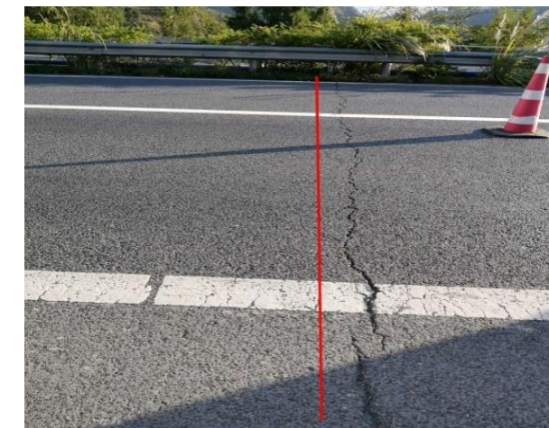
图 3.3-10 R1#桥面铺装横向裂缝
