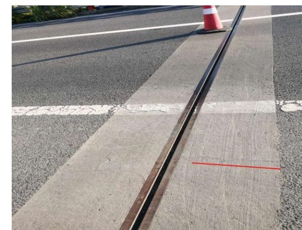
图 3.3-11 R1#伸缩缝锚固区缺陷开裂
