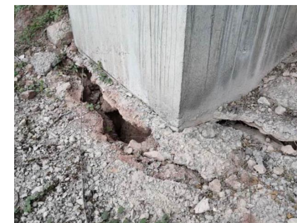
图3.6-2 R-13#墩台基础周边土体塌陷
