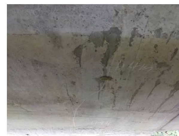
图 3.2-7 L4#盖梁大桩号面竖向裂缝
