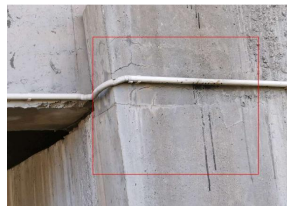
图 3.3-8 R7#盖梁右侧挡块网状裂缝
