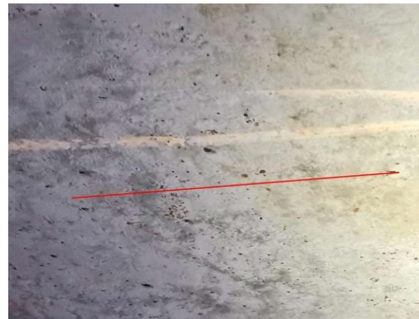
图 3.14-2 R6-6-7#节段箱梁内侧顶板纵向裂缝
