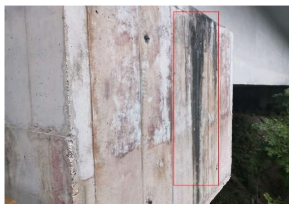
图 3.4-7 L12#盖梁受水侵蚀
