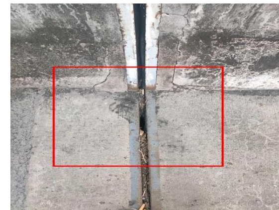
图 3.4-10 R1#伸缩缝老化破损
