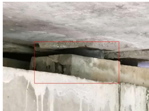
图 3.5-4 R3-3-13# 支座大桩号面位置串动
