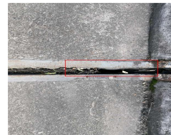
图 3.5-8 L3# 伸缩缝橡胶条橡胶带老化破损
