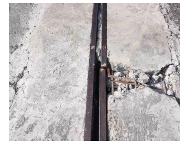
图 3.1-14 R2#伸缩缝型钢破损
