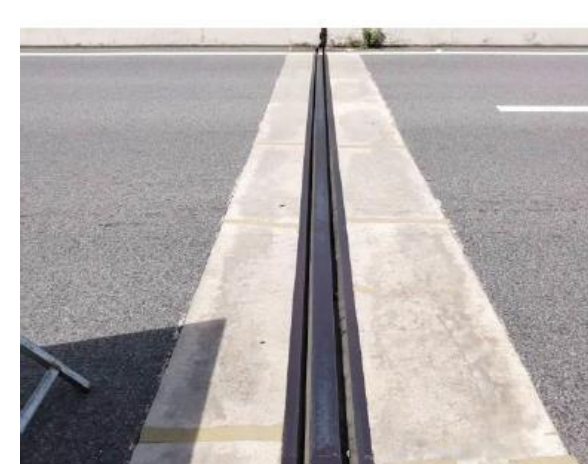
图3.6-4 L2#伸缩缝锚固件、止水带破损
