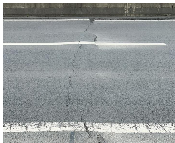
图 4.2-1 三里河大桥桥面铺装横向裂缝
