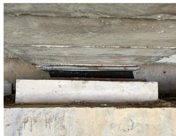
图 4.2-2 三里河大桥支座剪切变形明显
