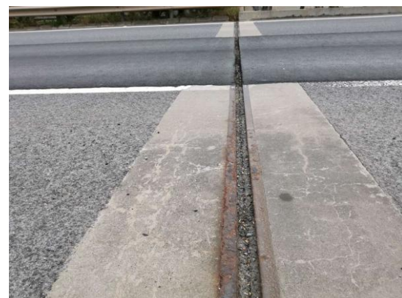
图 3.10-2 引桥 R1#伸缩缝型钢堵塞
