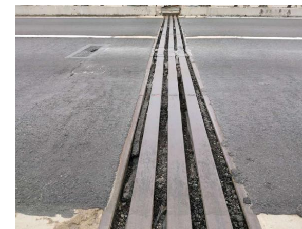
图 3.10-4 主桥 L3#伸缩缝橡胶条堵塞
