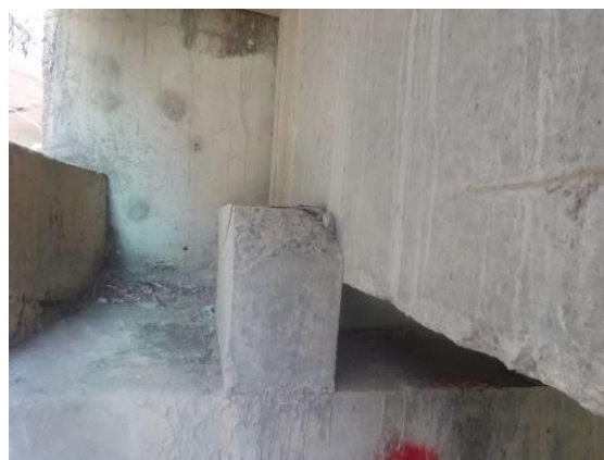
图 3.7-1 0#桥台挡块抵死破损
