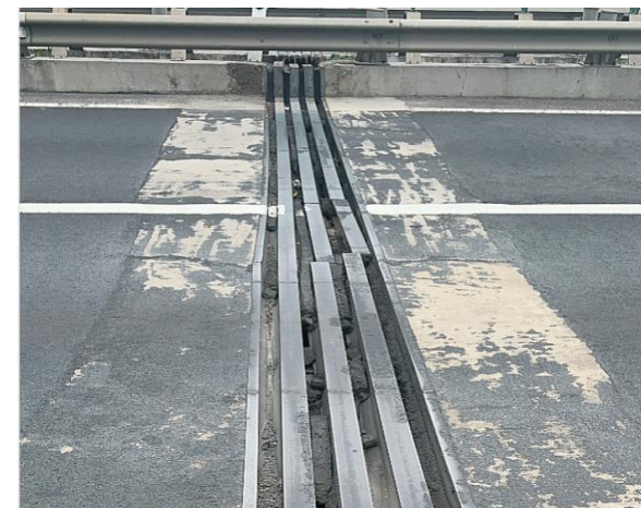
图 4.3-1 彭溪河特大桥 L4#伸缩缝型钢断裂
