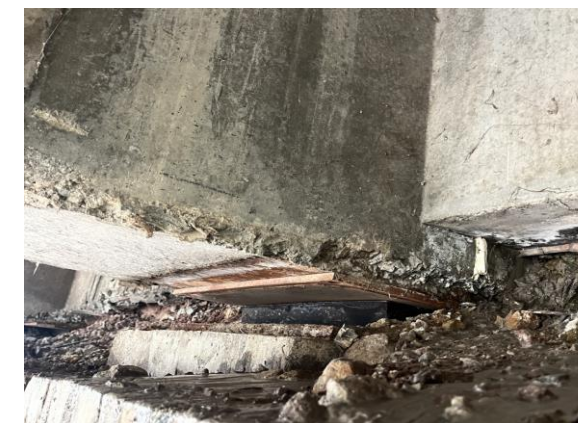
图 3.8-4 6号桥台处支座滑移
