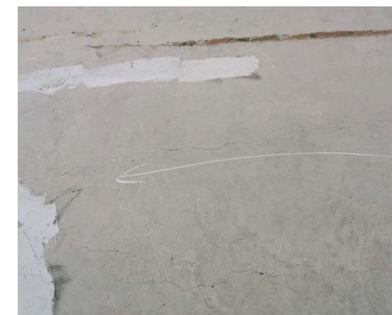
图 3.16-2 L1-1#T梁马蹄左侧面纵向裂缝
