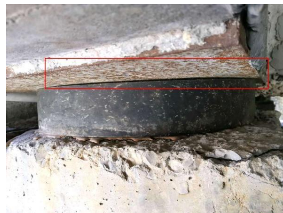
图 3.3-6 R2-1-5#支座大桩号面脱空
