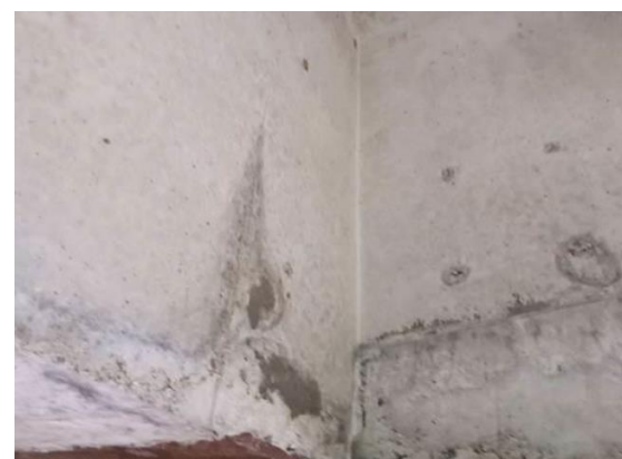
图 3.1-4 R1-1-3#横隔板小桩号竖向裂缝
