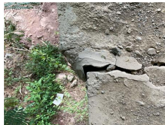
图 3.8-3 6号桥台桥下挡墙外倾
