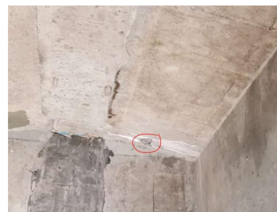
图 3.3-1 L1-3#T 梁右翼缘板破损
