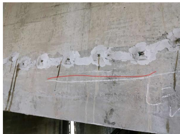
图 3.11-1 R1#箱梁右腹板纵向裂缝
