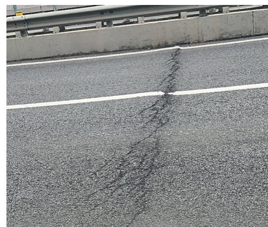
图 4.1-1 桥面铺装横向裂缝
