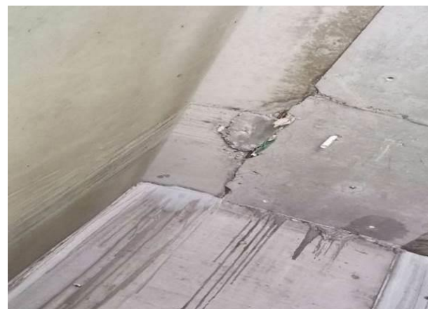
图 3.2-2 L8-3#T 梁左腹板剥落、掉角露筋
