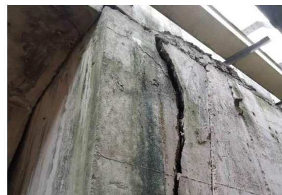
图 3.1-8 L4#台身右侧侧墙竖向开裂
