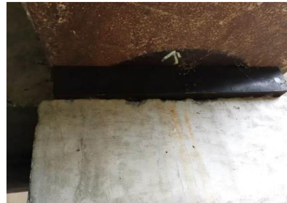
图 3.1-6 R-1-1-1#支座小桩号面位置串动
