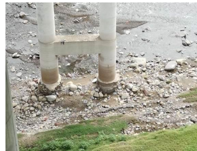
图 3.15-1 L-14-1#桥墩桩基础冲刷、掏空
