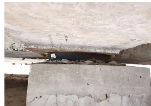
图 3.1-5 L-4-3-7#支座右侧剪切变形
