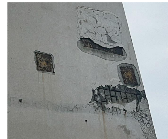
图 4.3-2 彭溪河特大桥桥塔混凝土剥落露筋
