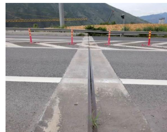
图 3.1-13 L1#伸缩缝失效卡死
