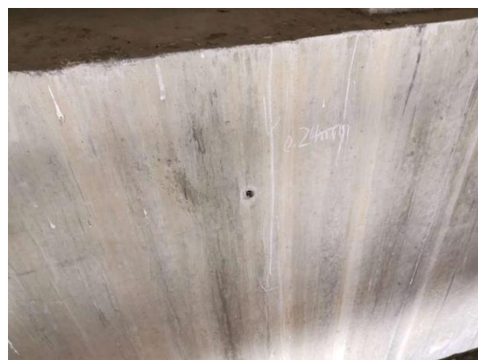
图 3.3-7 L1#盖梁大桩号面竖向裂缝
