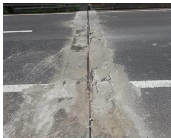
图 3.8-2 伸缩缝后保护带破损
