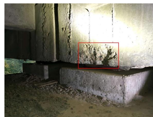
图 3.4-1 L4-2#T 梁马蹄右侧面剥落
