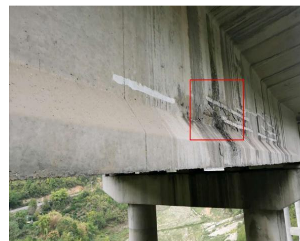
图 3.13-1 R12-1#T梁左腹板破损露筋
