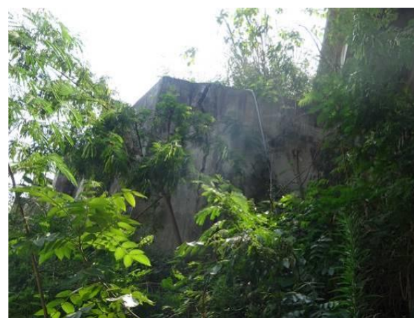
图 3.8-1 6号桥台护坡挡墙破损开裂
