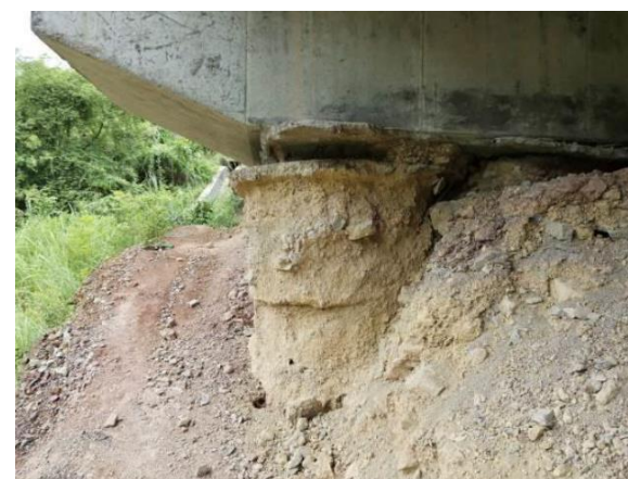
图3.6-1 R-1#墩台基础冲刷、掏空
