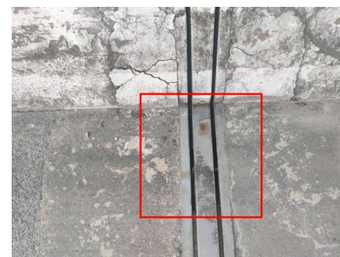
图 3.16-7 R3#伸缩缝橡胶条老化破损
