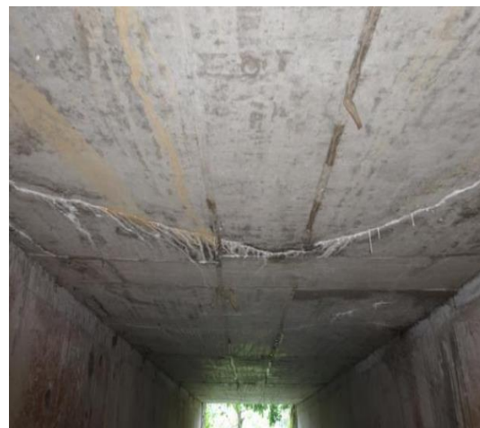
图 3.18-2 盖板横向裂缝
