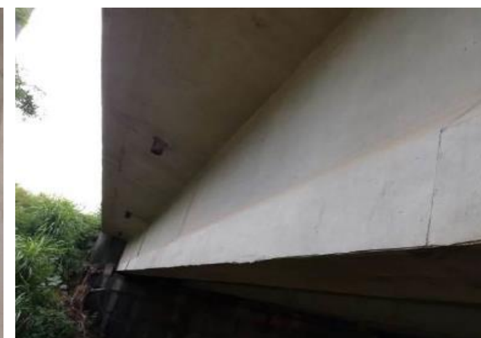
图 3.1-2 R1-1#T 梁马蹄右侧面纵向裂缝
