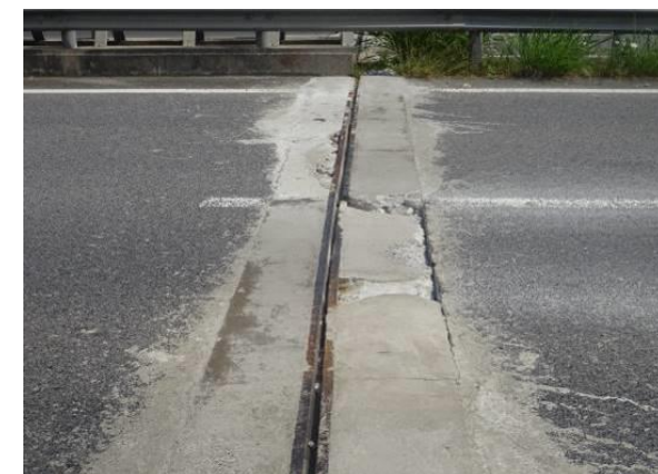
图 3.9-1 R1#伸缩缝锚固区缺陷破损、型钢断裂
