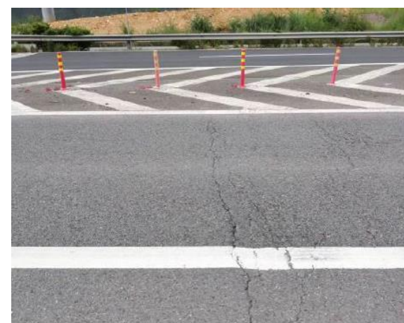
图 3.1-11 L-0#桥头搭板桥面铺装裂缝
