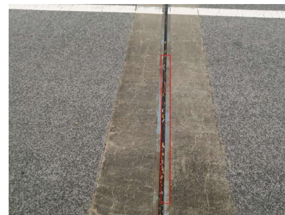
图 3.4-9 L1#伸缩缝堵塞
