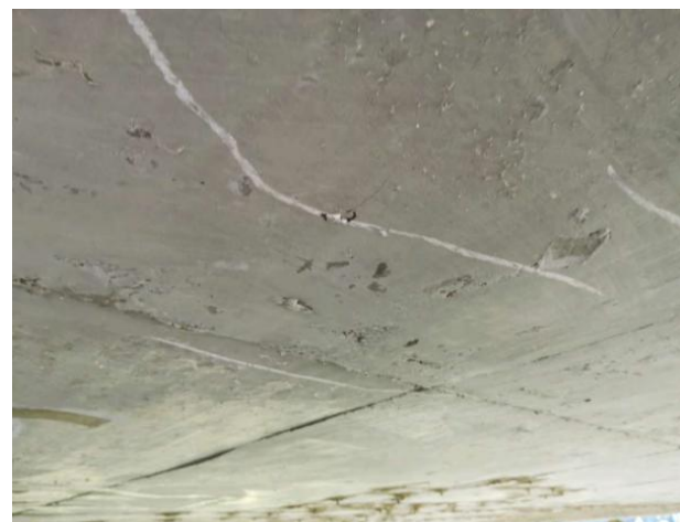
图 3.11-2 R1#箱梁底板纵向裂缝
