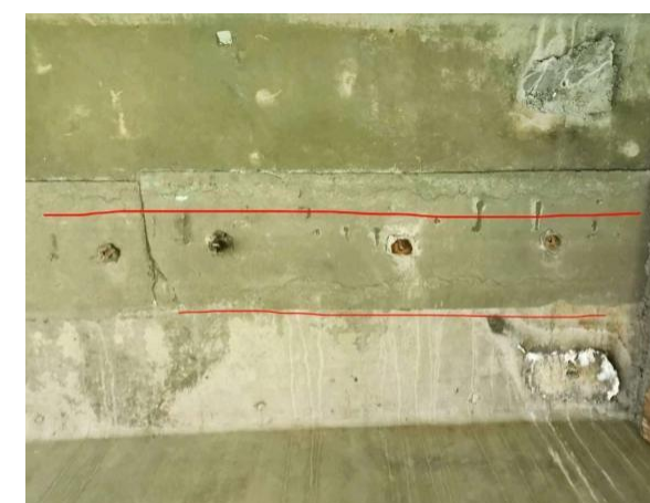
图 3.4-4 R5-5#湿接缝纵向裂缝
