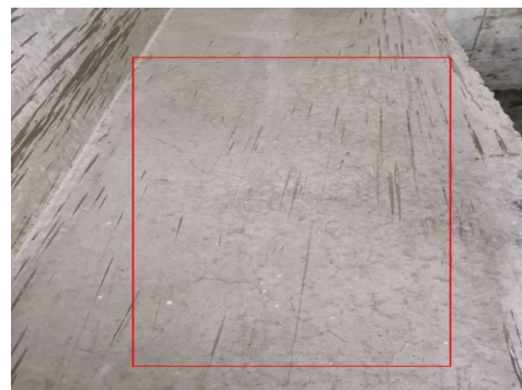
图 3.16-3 R2-2#横隔板大桩号面网状裂缝
