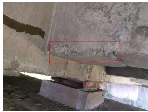
图 3.16-4 L2-1#横隔板大桩号面剥落
