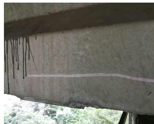
图 3.12-1 R1-2#T梁马蹄左侧面纵向裂缝
