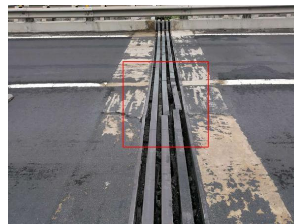
图 3.10-3 主桥 L4#伸缩缝橡胶条焊缝开裂
