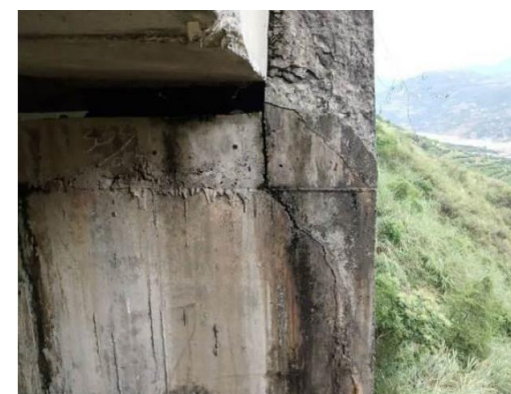
图 3.17-1 L8#盖梁左侧挡块剥落、露筋
