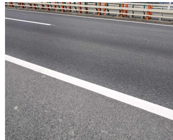
图 3.3-9 L1#桥面铺装车辙
