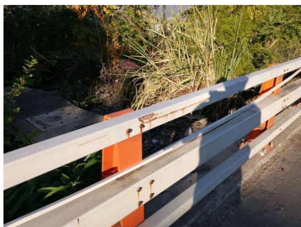
图 3.3-11 R1#右侧护栏锈蚀
