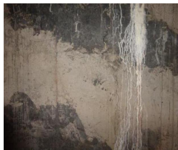
图 3.19-2 侧墙竖向裂缝
