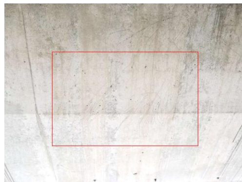
图 3.16-5 R5#盖梁大桩号面网状裂缝
