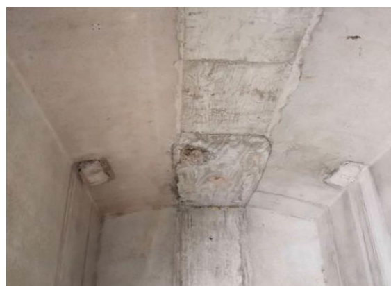
图 3.1-3 L-2-6#湿接缝剥落、掉角
