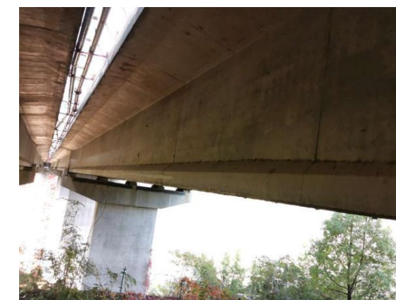
图 3.3-2 L1-3#T 梁右翼缘板破损
