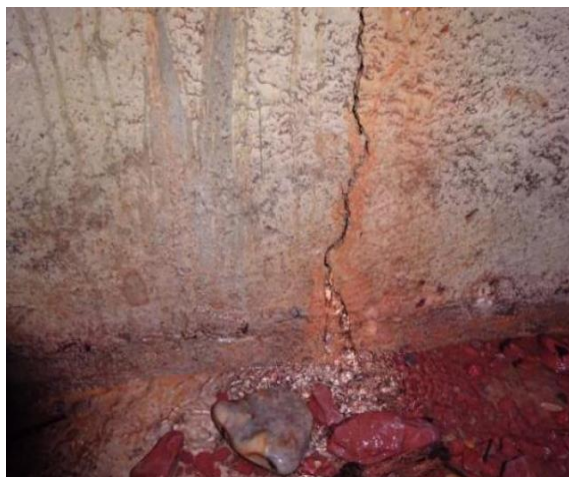
图 3.18-1 侧墙竖向裂缝
