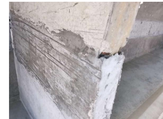
图 3.3-4 R8-2-4#横隔板底面破损露筋
