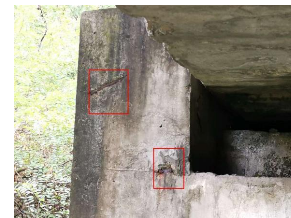
图 3.5-6 L3# 盖梁右侧挡块网状裂缝
