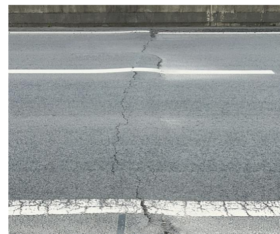
图 5.2-4 桥台处铺装横向裂缝
