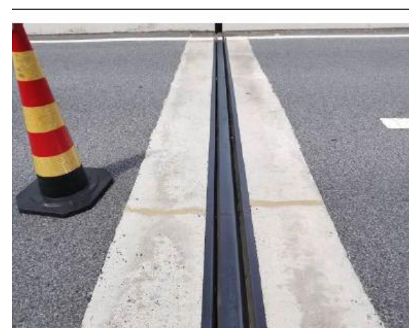
图3.6-3 L1#伸缩缝锚固件、止水带破损
