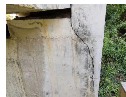
图 3.17-2 R4#盖梁右侧挡块竖向开裂
