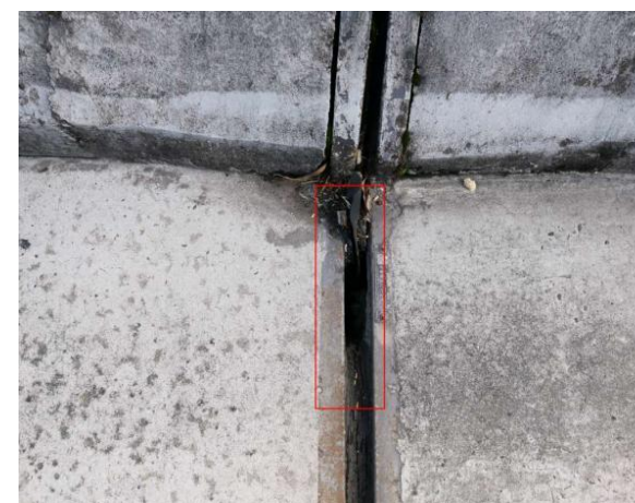
图 3.5-7 L2# 伸缩缝橡胶条橡胶带老化破损
