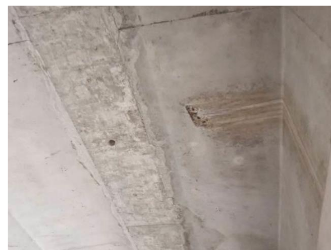
图 3.1-1 L3-6#T 梁左翼缘板剥落、掉角
