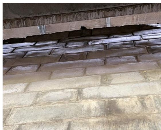
图 4.2-3 三里河大桥桥台侧墙外鼓
