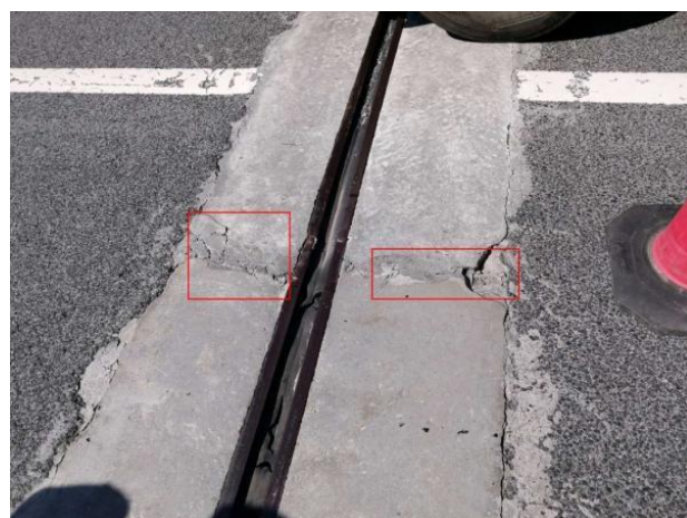
图 3.11-4 L5#伸缩缝锚固区破损
