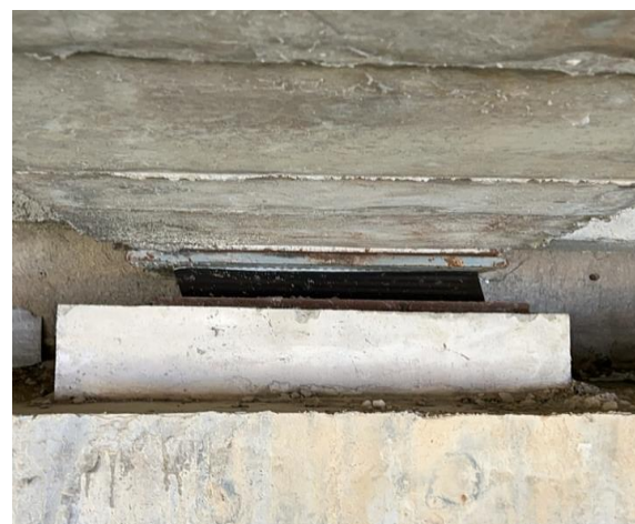
图 5.2-3 桥台处支座剪切变形
