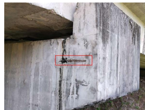
图 3.5-5 R5# 盖梁大桩号面网状裂缝
