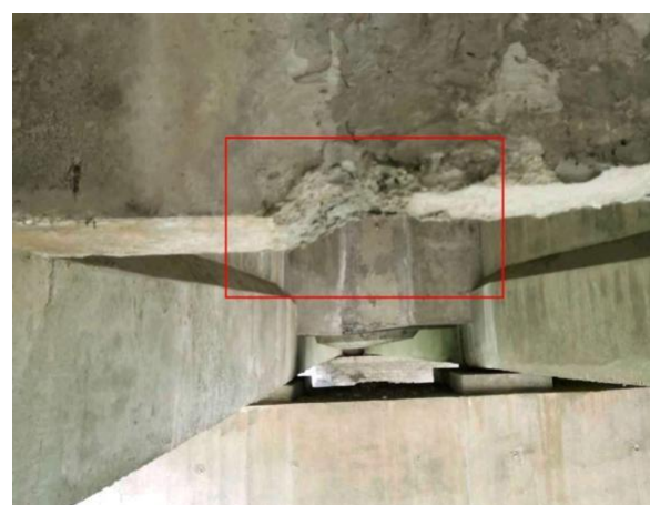
图 3.4-3 R2-5-2#横隔板剥落
