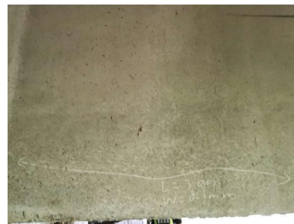
图 3.16-1 R1-1#T梁马蹄右侧面纵向裂缝
