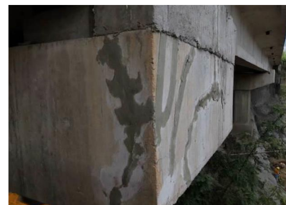
图 3.1-9 R3#盖梁右侧挡块混凝土破损
