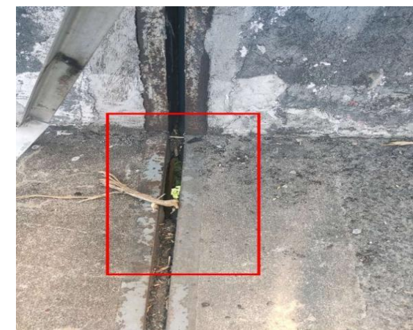
图 3.12-2 R1#伸缩缝橡胶条老化破损
