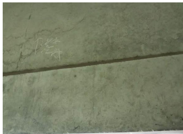
图 3.2-1 L3-3#T 梁左腹板纵向裂缝
