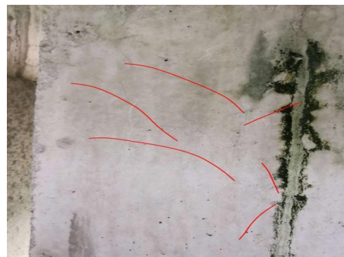
图 3.16-6 L3#盖梁右侧挡块网状裂缝
