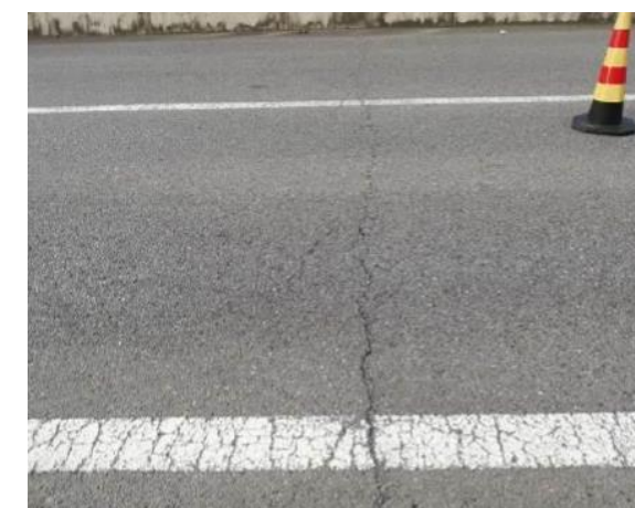
图 3.1-12 R-0#桥头搭板桥面铺装裂缝
