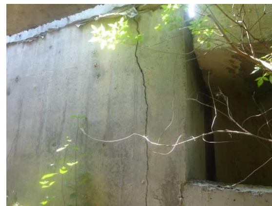
图 3.7-2 0号桥台右侧墙竖向开裂
