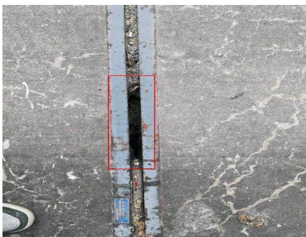
图 3.11-3 R1#伸缩缝橡胶条橡胶带老化破损
