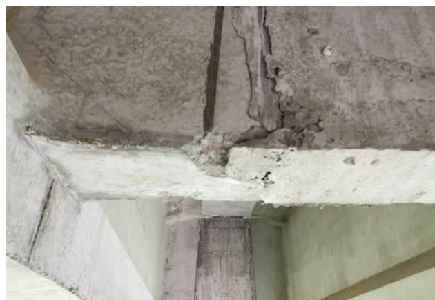
图 3.2-3 L2-1-2#横隔板底面剥落、掉角
