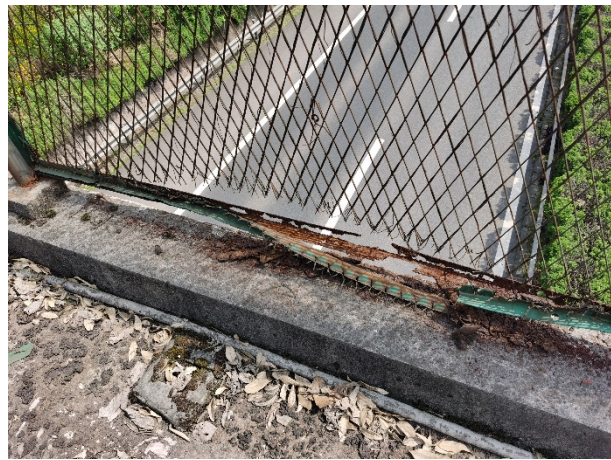
防抛网锈蚀变形
