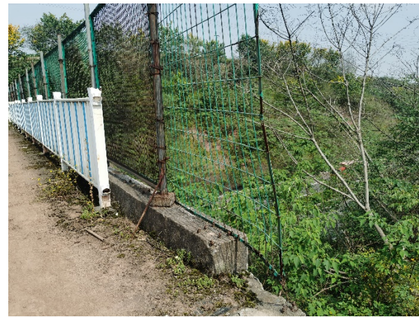
防抛网立柱缺失
