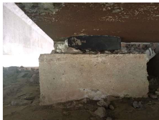
图2.2-64 右幅1-1-12#支座剪切变形
