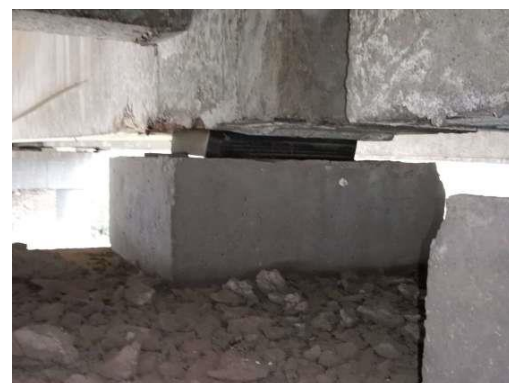
图2.2-58 左幅2-2-3#支座剪切变形
