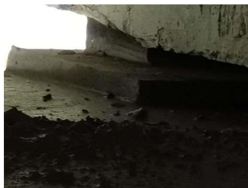
图2.2-71 右幅3-2-4#支座开裂
