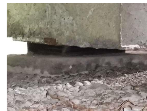
图2.2-70 右幅3-2-5#支座剪切变形
