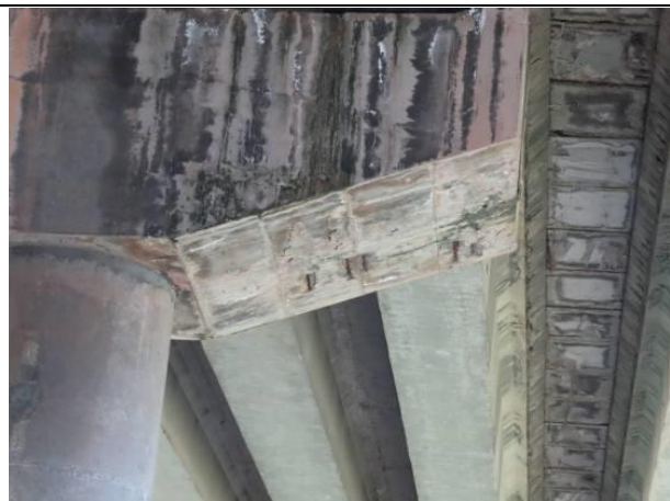
图 2.2-8 柏树湾大桥左幅 7#盖梁露筋
