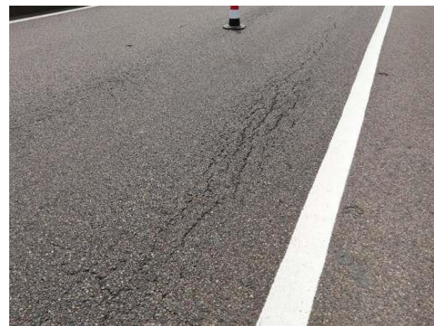
图 2.2-14 古路大桥右幅 2#桥面铺装网状裂缝
