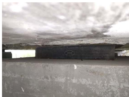
图2.2-57 左幅2-1-3#支座脱空
