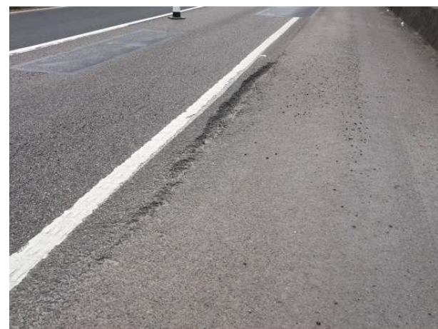
图 2.2-17 渝邻 1#桥右幅 2#桥面铺装拥包
