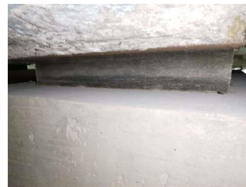
图2.2.2-36 右幅3-3-4#支座开裂
