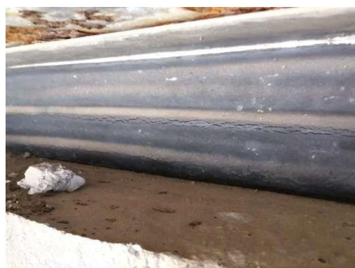
图2.2-49 左幅5-4-1#支座开裂
