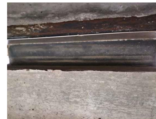
图2.2-84 右幅4-4-4#支座开裂
