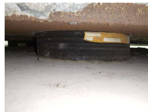
图2.2-75 右幅3-3-7#支座开裂
