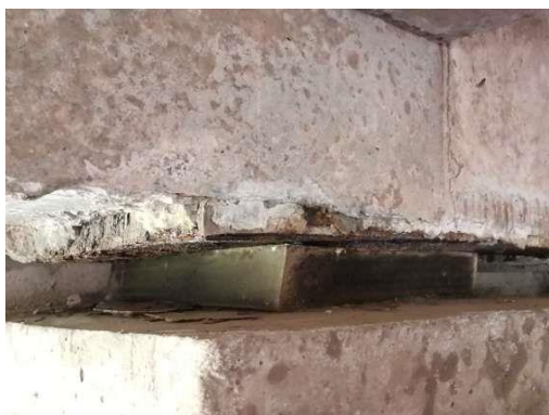
图2.2.2-33 右幅1-1-1#支座剪切变形
