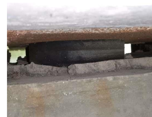
图2.2-30 右幅2-2-11#支座老化变质开裂
