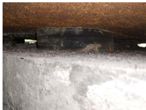
图2.2-74 右幅2-2-9#支座老化变质、开裂
