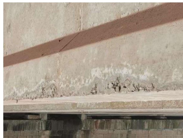
图 2.2-1 古路大桥右幅 1-4#T 梁蜂窝、麻面
