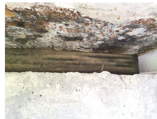
图2.2-83 右幅1-1-5#支座开裂
