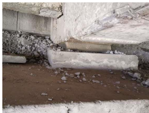
图2.2.2-47 右幅3-3-2#支座脱空
