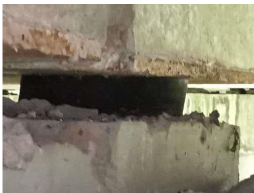
图2.2.2-31 右幅3-2-10#支座剪切变形
