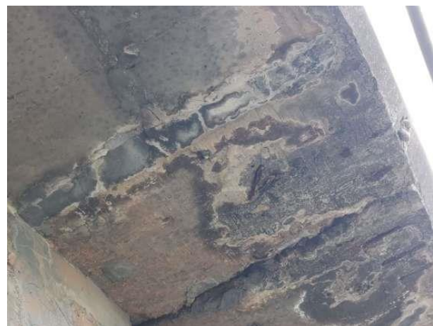
图 2.2-2 古路大桥右幅 8-5#T 梁露筋
