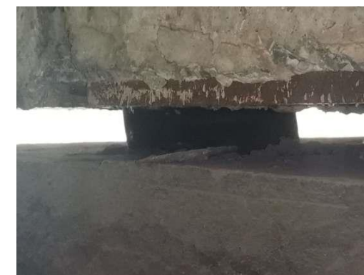
图2.2-76 右幅4-4-13#支座剪切变形
