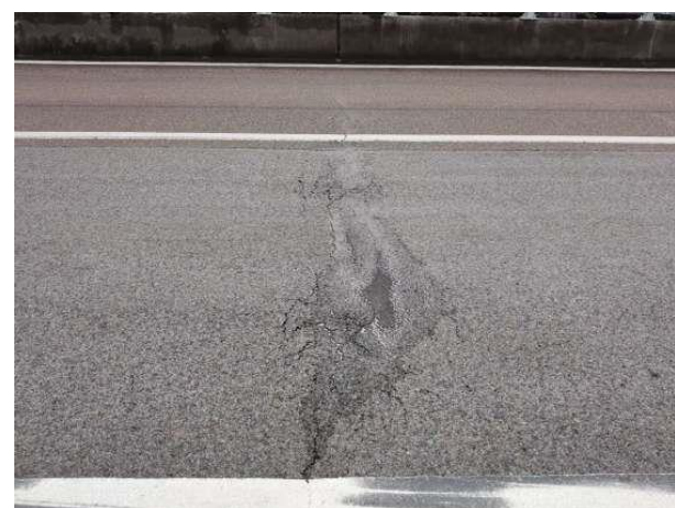
图 2.2-16 楠花 2#桥右幅 1#桥面铺装网状裂缝
