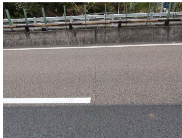
图 2.2-13 柏树湾大桥右幅 1#桥面铺装 横向裂缝
