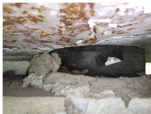
图2.2-66 右幅4-4-12#支座老化变质、开裂
