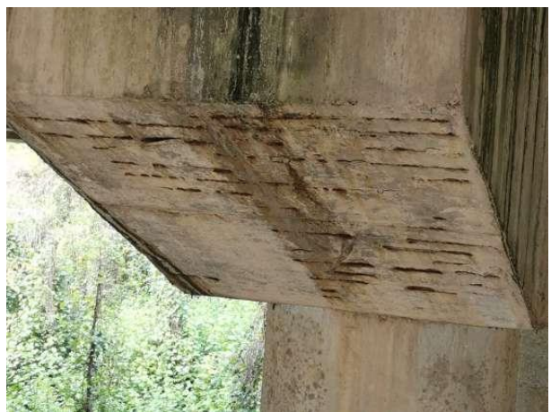
图 2.2-9 黄家院子大桥右幅 2#盖梁露筋
