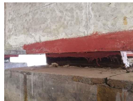
图2.2-77 左幅8-7-2#支座剪切变形
