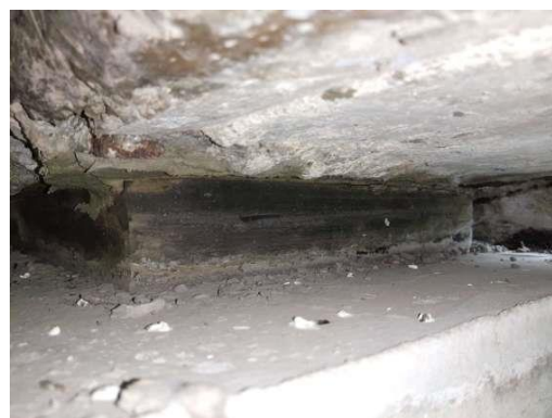
图2.2-72 右幅4-4-5#支座开裂
