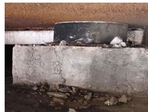
图2.2-93 右幅1-0-5#支座剪切变形
