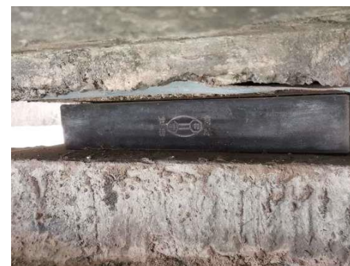
图2.2.2-38 右幅3-2-2#支座脱空
