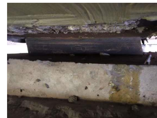
图2.2-46 右幅2-1-3#支座开裂
