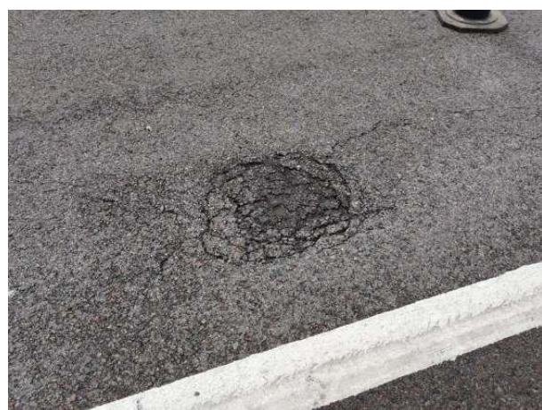
图 2.2-15 楠花 2#桥右幅 1#桥面铺装破损坑槽
