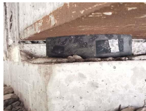
图2.2-96 右幅2-2-7#支座开裂
