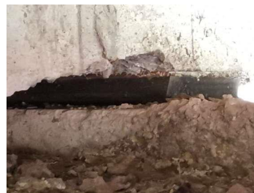
图2.2.2-37 右幅2-1-1#支座剪切变形
