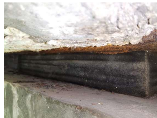
图2.2-56 右幅2-2-1#支座开裂
