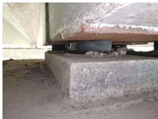
图2.2-87 左幅6-5-11#支座脱空
