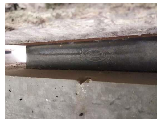
图2.2-53 左幅7-6-4#支座开裂
