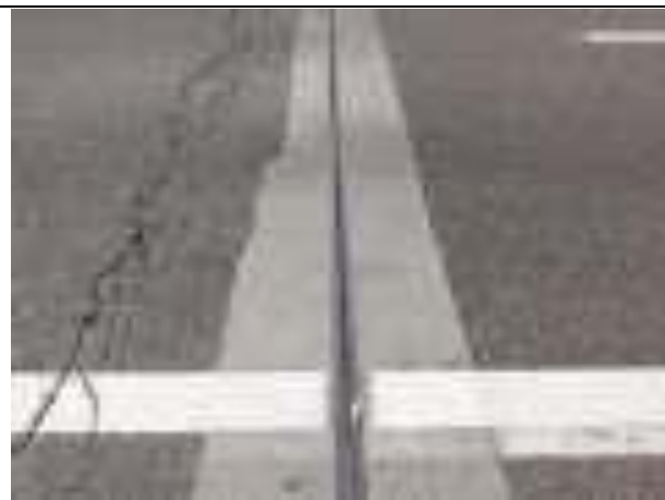
图 2.2-12 鱼堡中桥右幅 0#桥台横向开裂
