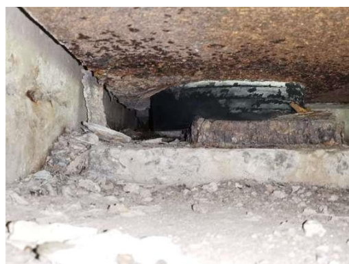
图2.2.2-41 左幅2-1-1#支座脱空
