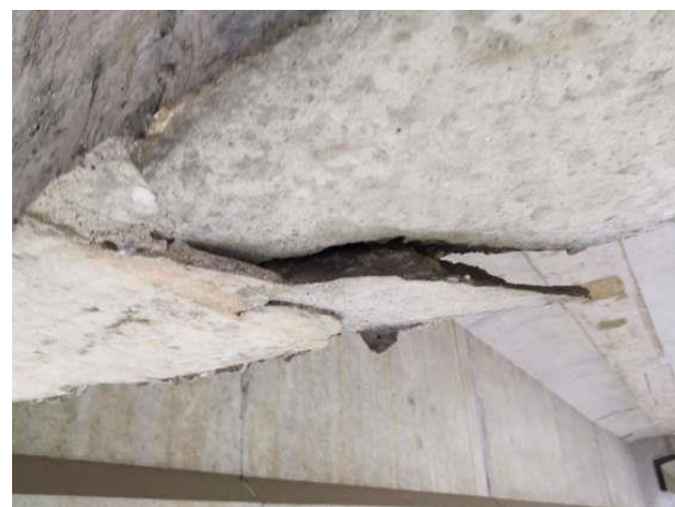
图 2.2-5 楠花 1#大桥左幅 6-2-2#横隔板开裂
