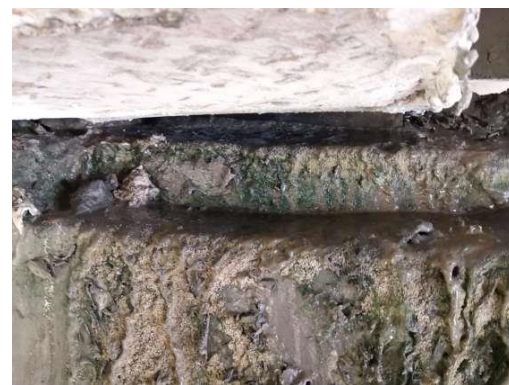
图2.2.2-48 左幅2-1-1#支座堵塞
