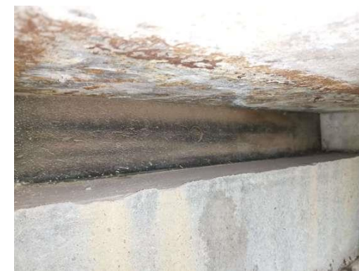
图2.2-52 右幅16-16-5#支座开裂
