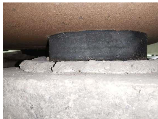
图2.2-88 右幅8-8-8#支座开裂
