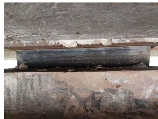
图2.2-40 右幅7-7-3#支座老化变质、开裂
