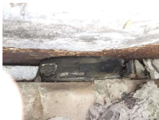
图2.2-65 左幅4-3-16#支座剪切变形
