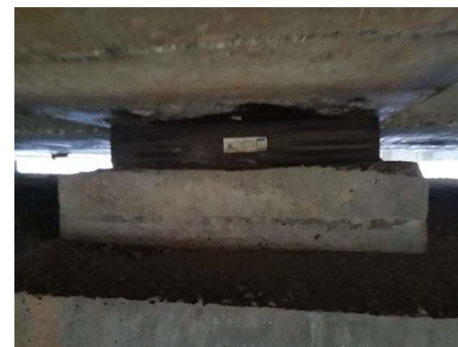
图2.2-51 右幅1-1-4#支座剪切变形
