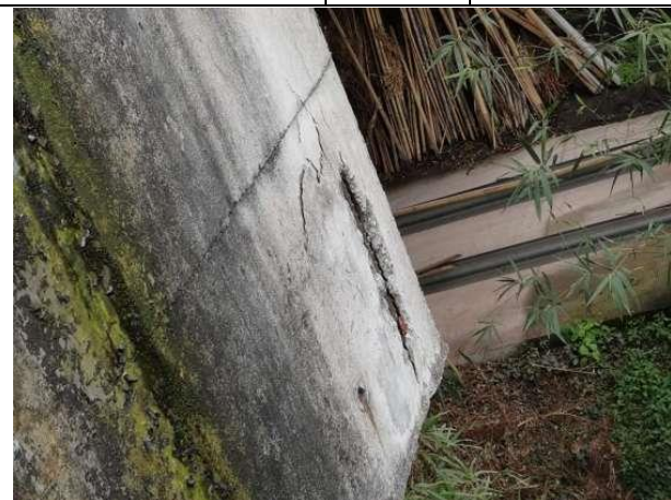
图 2.2-7 柏树湾大桥左幅 1#桥墩剥落、露筋 破损
