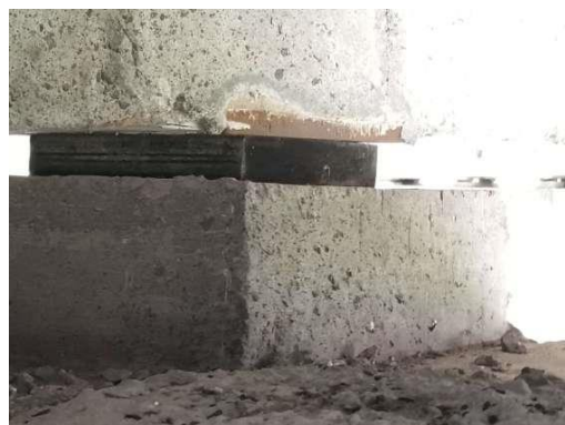
图2.2-55 右幅4-3-3#支座脱空
