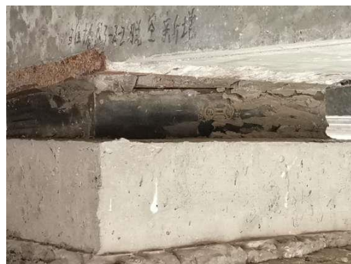
图2.2.2-34 右幅3-2-4#支座脱空
