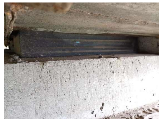
图2.2-82 左幅4-3-5#支座开裂
