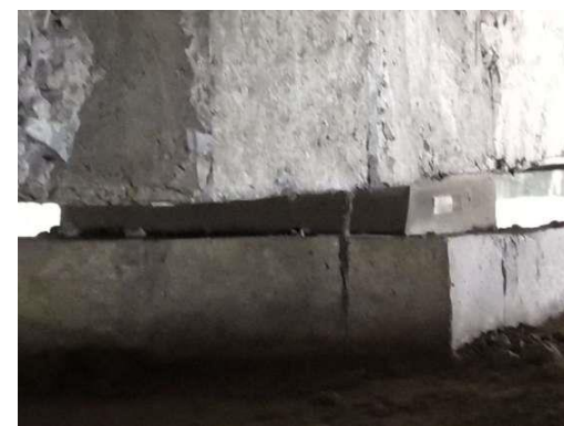
图2.2-45 右幅1-1-4#支座剪切变形
