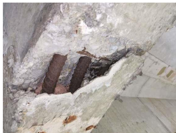
图 2.2-6 楠花 1#大桥左幅 6-3-2#横隔板破损，露筋
