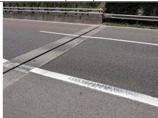
图 2.2-11 石口子大桥左幅 0#桥台桥头跳车
