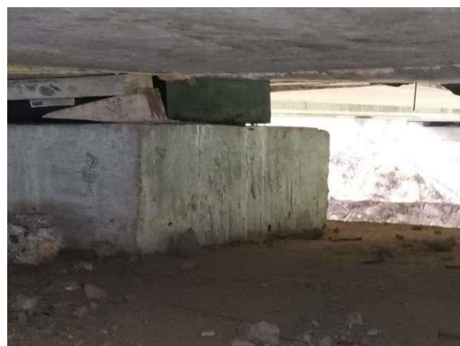
图2.2-81 左幅1-1-2#支座脱空
