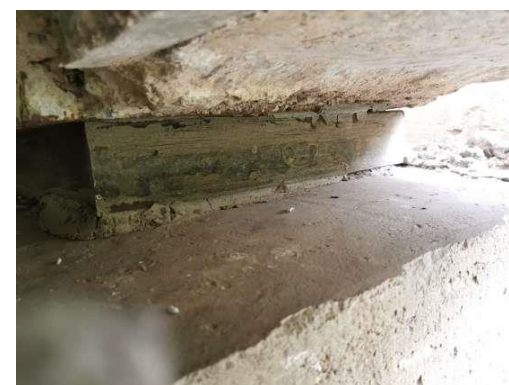
图2.2-69 左幅6-5-5#支座脱空
