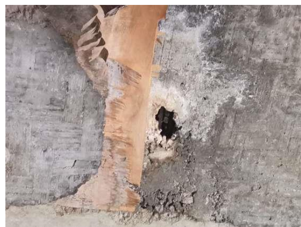
图 2.2-3 古路大桥右幅 3-4#湿接缝露筋
