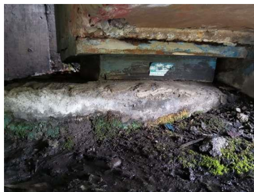
图2.2-79 右幅9-9-5#支座剪切变形
