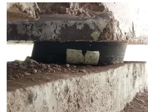
图2.2.2-44 右幅4-3-14#支座剪切变形
