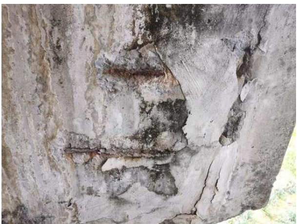
图 2.2-10 王家主线桥右幅 3#盖梁露筋
