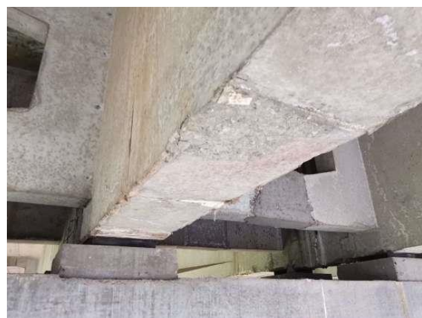
图 2.2-4 楠花 1#大桥左幅 7-4#T 梁破损
