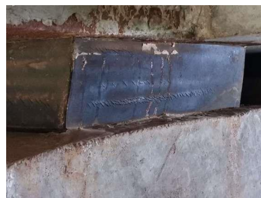
图2.2-50 左幅18-17-1#支座开裂
