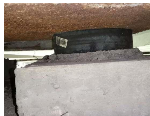
图2.2-29 右幅2-1-12#支座老化变质开裂
