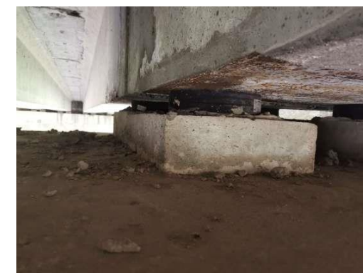
图2.2-62 右幅3-2-11#支座老化变质、开裂
