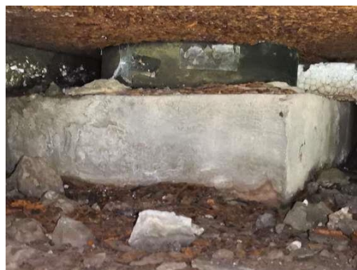
图2.2-63 左幅1-0-1#支座剪切变形
