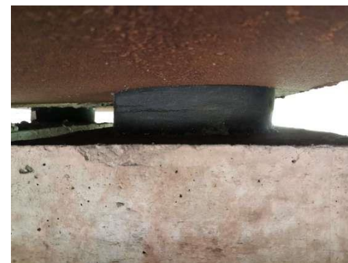
图2.2.2-43 右幅1-1-14#支座开裂
