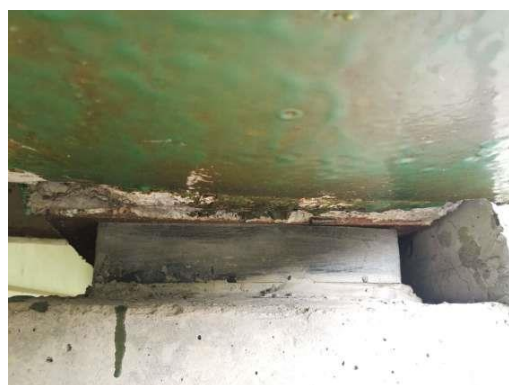
图2.2-90 左幅3-2-5#支座脱空
