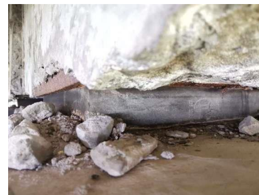
图2.2-59 右幅2-1-1#支座开裂
