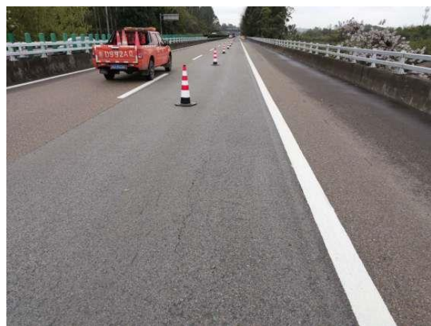
图 2.2-17 楠花 2#桥右幅 2#桥面铺装纵向裂缝
