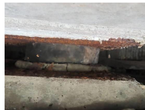
图2.2-85 左幅1-0-2#支座剪切变形
