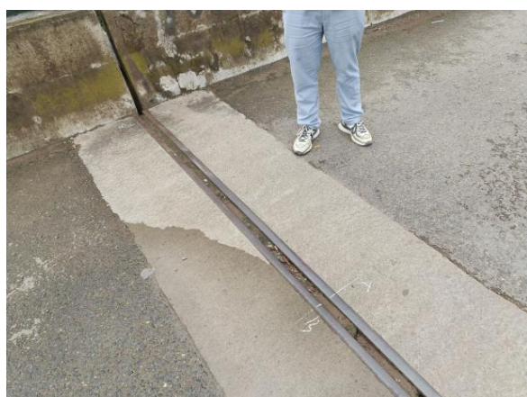
图 3-13 伸缩缝填塞严重
