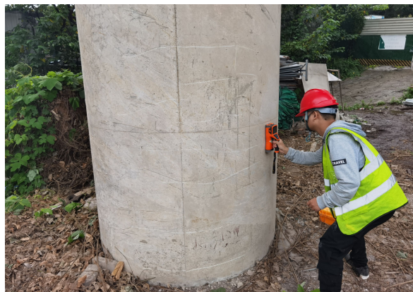
图 3-2 2#立柱内侧环向裂缝
