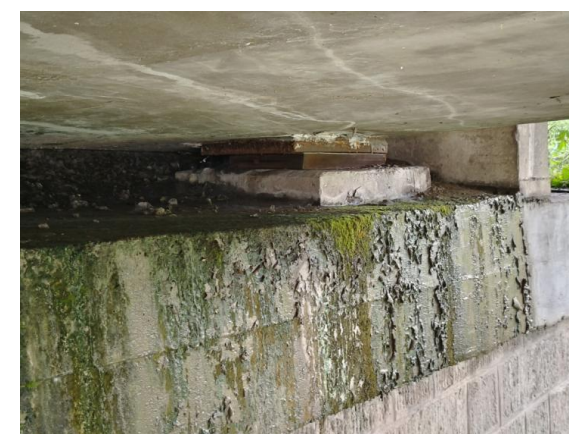
图 3-11 0#台支座顶面向内侧剪切变形
