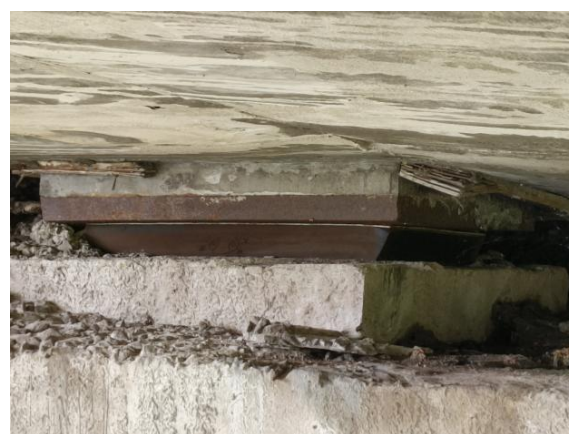
图 3-10 0#台支座顶面向内侧剪切变形
