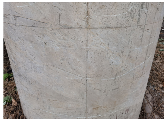
图 3-3 2#立柱内侧环向裂缝
