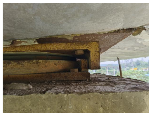
图 3-9 4-4-1#支座钢盆锈蚀
